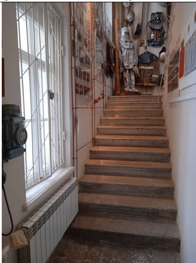
12. Объект культурного наследия федерального значения «Управление городское с оградой и воротами». Пожарная лестница. Общий вид.
