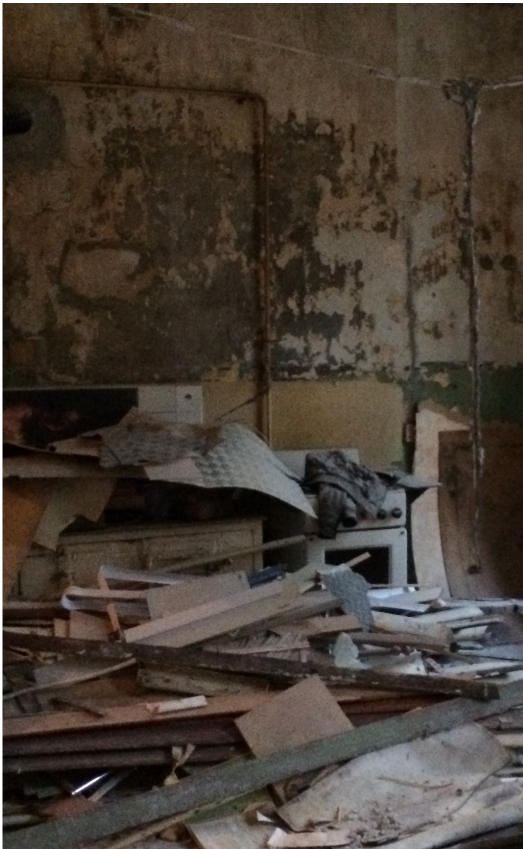
Фото 13 Общий вид на часть помещений квартиры № 50 (№ 6 по плану ПИБ). Наблюдается складирование строительного мусора.
