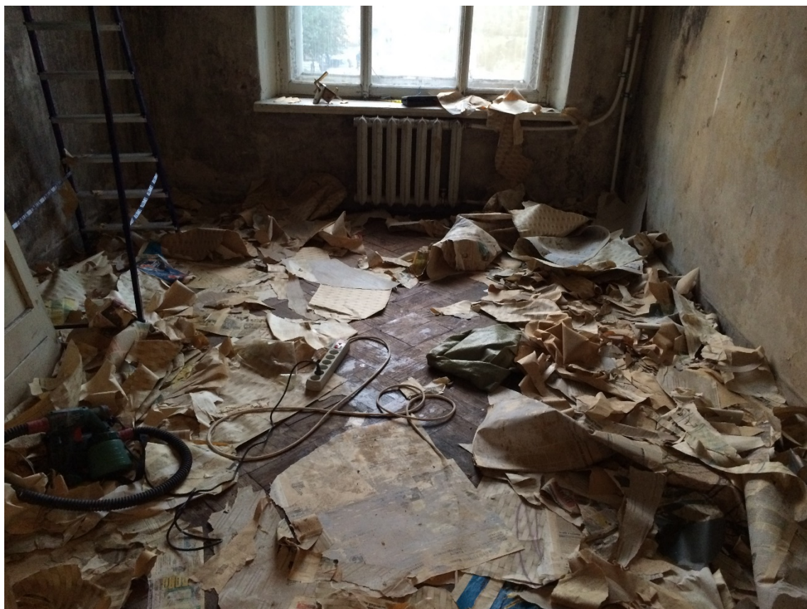
Фото 18 Общий вид на часть помещений квартиры № 50 (№ 8 по плану ПИБ). Наблюдается складирование строительного мусора.
