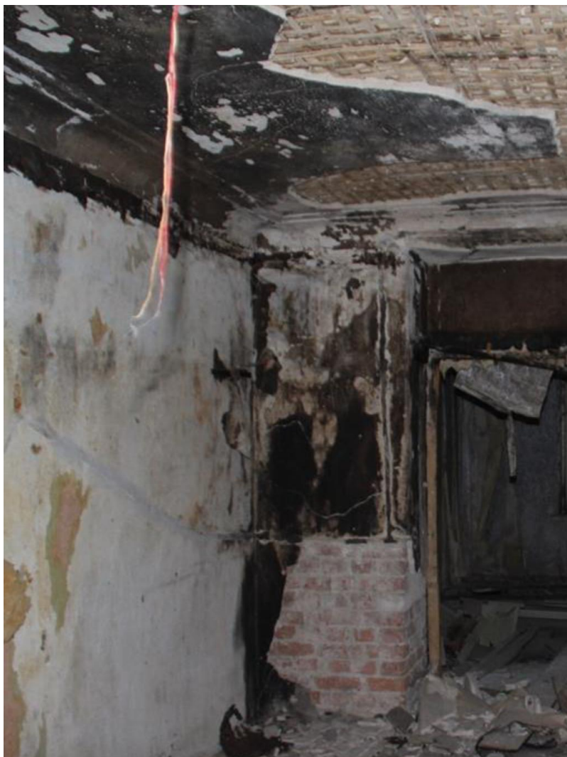
28. Здание по адресу: г. Санкт-Петербург, Кондратьевский пр., д. 40, литера А, корпус 7, являющееся частью объекта культурного наследия регионального значения «Жилые здания», входящее в состав объекта культурного наследия регионального значения «Кондратьевский жилмассив» (г. Санкт-Петербург, Калининский район, Кондратьевский пр., д. 40. На основании Распоряжения КГИОП от 27.02.2014 № 10-89). Фрагмент интерьера помещения второго этажа.
