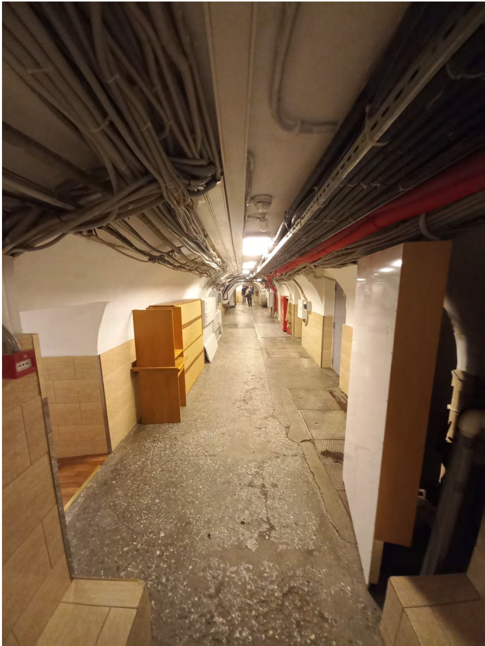
Фото 13. Главный корпус. Коридор подвала. Существующие кабельные линии.
