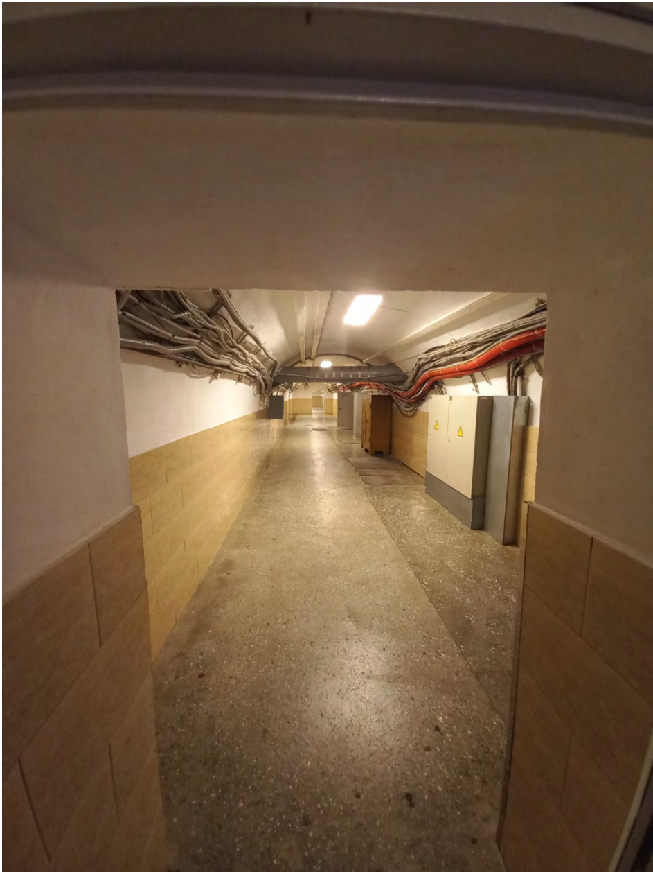
Фото 14. Главный корпус. Коридор подвала. Свод. Существующие кабельные линии.
