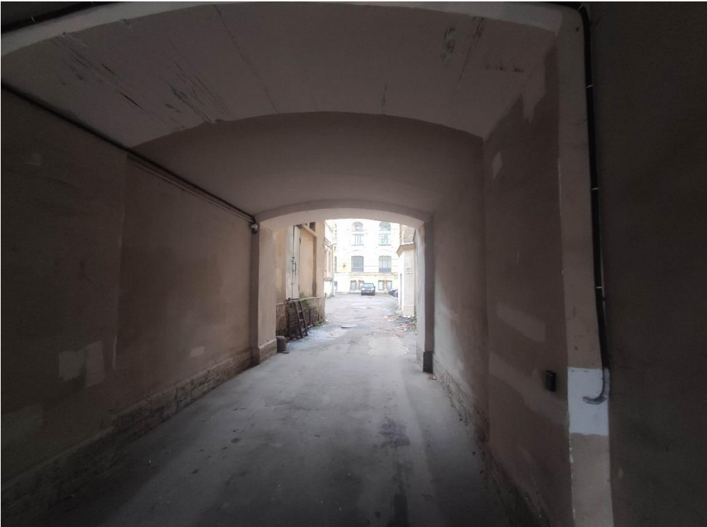
8. Часть объекта культурного наследия «Здания, в которых 1885-1918 гг. находились Высшие женские (Бестужевские) курсы. Здесь преподавали Бестужев-Рюмин К.Н., Менделеев Д.И., Бутлеров А.М., Сеченов И.М. и другие деятели науки» по адресу: Санкт-Петербург, 10-я линия В.О., дом 31-33, литера А. Общий вид воротного проезда в центральном лицезов корпусе.
