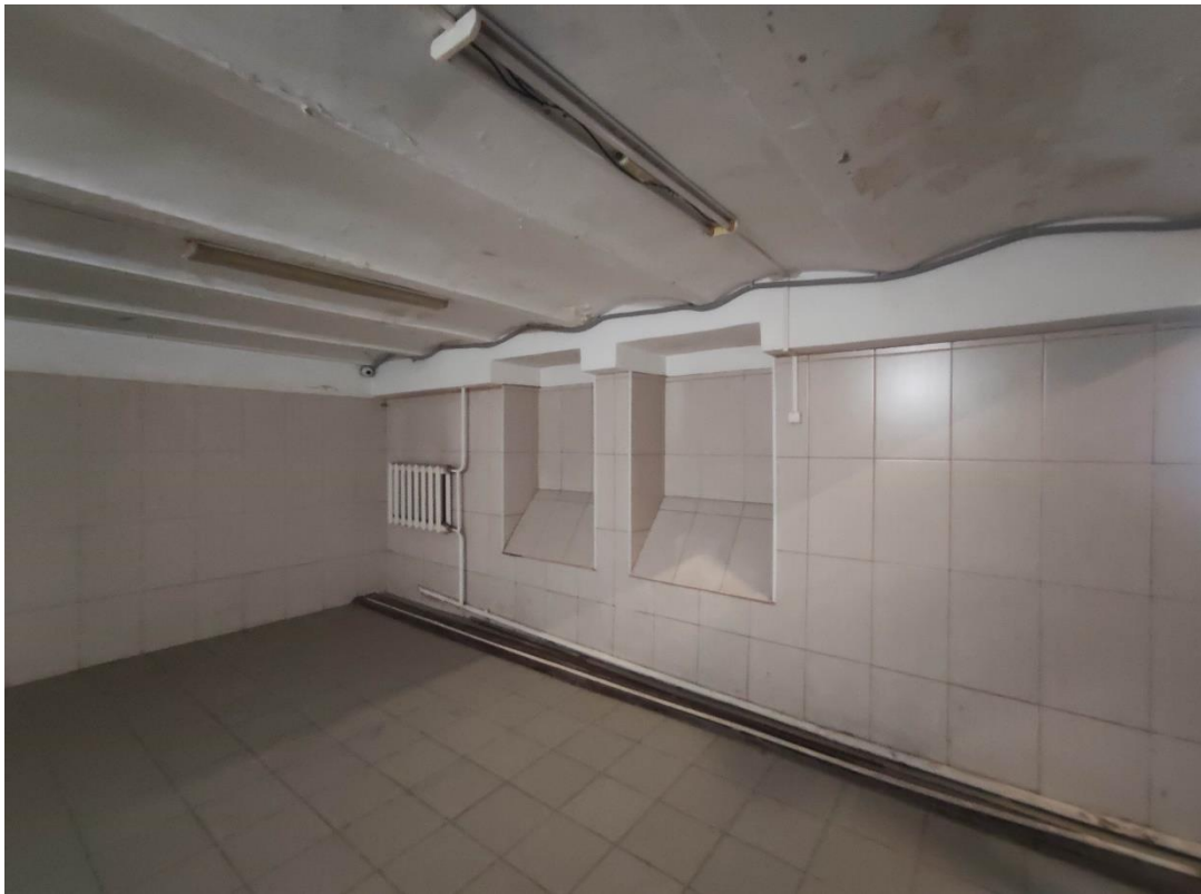
93. Часть объекта культурного наследия «Здания, в которых 1885-1918 гг. находились Высшие женские (Бестужевские) курсы. Здесь преподавали Бестужев-Рюмин К.Н., Менделеев Д.И., Бутлеров А.М., Сеченов И.М. и другие деятели науки» по адресу: Санкт-Петербург, 10-я линия В.О., дом 31-33, литера А. Общий вид пом. № 1-Н(21).
