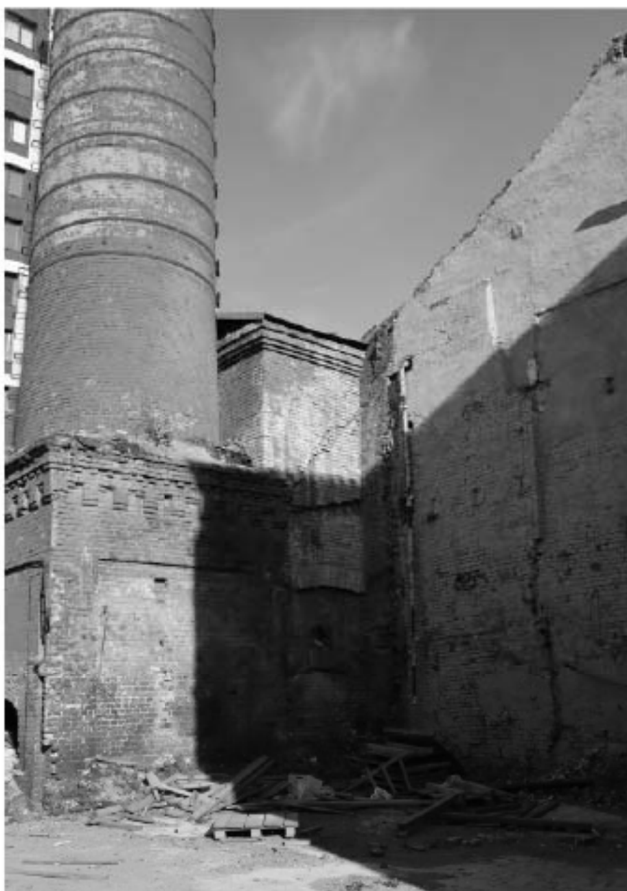
13. Выявленный ОКН «Производственное здание с дымовой трубой Киновиевского Ультрамаринового завода Г.И. Веge», по адресу: г. Санкт-Петербург, Октябрьская набережная, дом 38, литера АН. Цокольная часть дымовой трубы литеры АН-10. Примыкание литеры АН-8 к АН-10 (слева) и к АН-6 (справа). Вид с юго-востока. Дата съемки: 13.09.2023.
