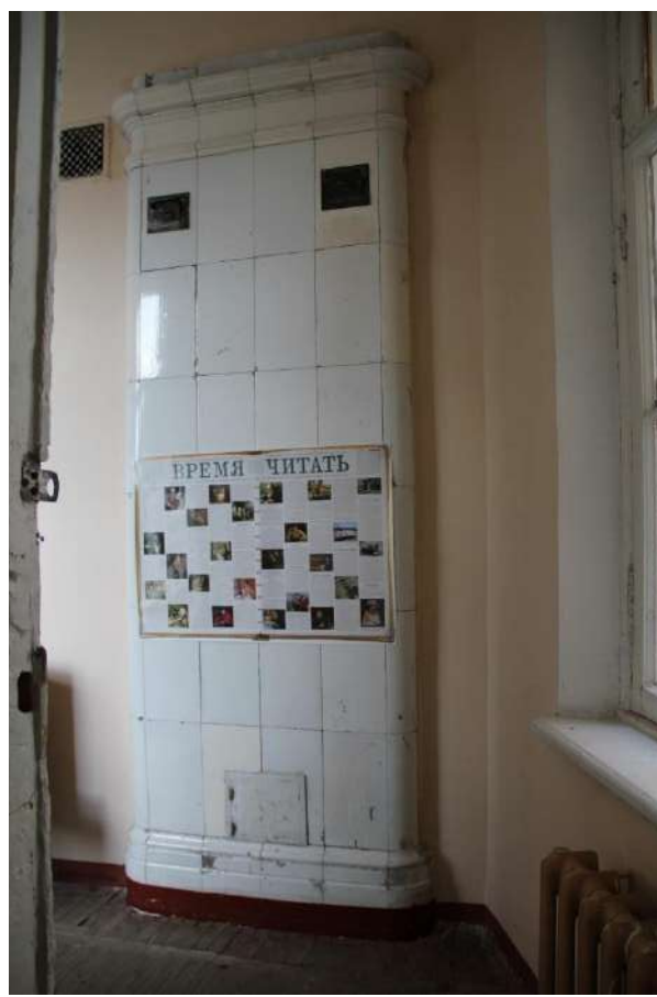
Фото 46. Вид на печь в пом. 1-Н (125).
