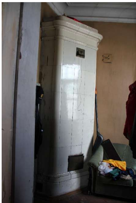
Фото 22. Вид на печь в пом. 1-Н (15).
