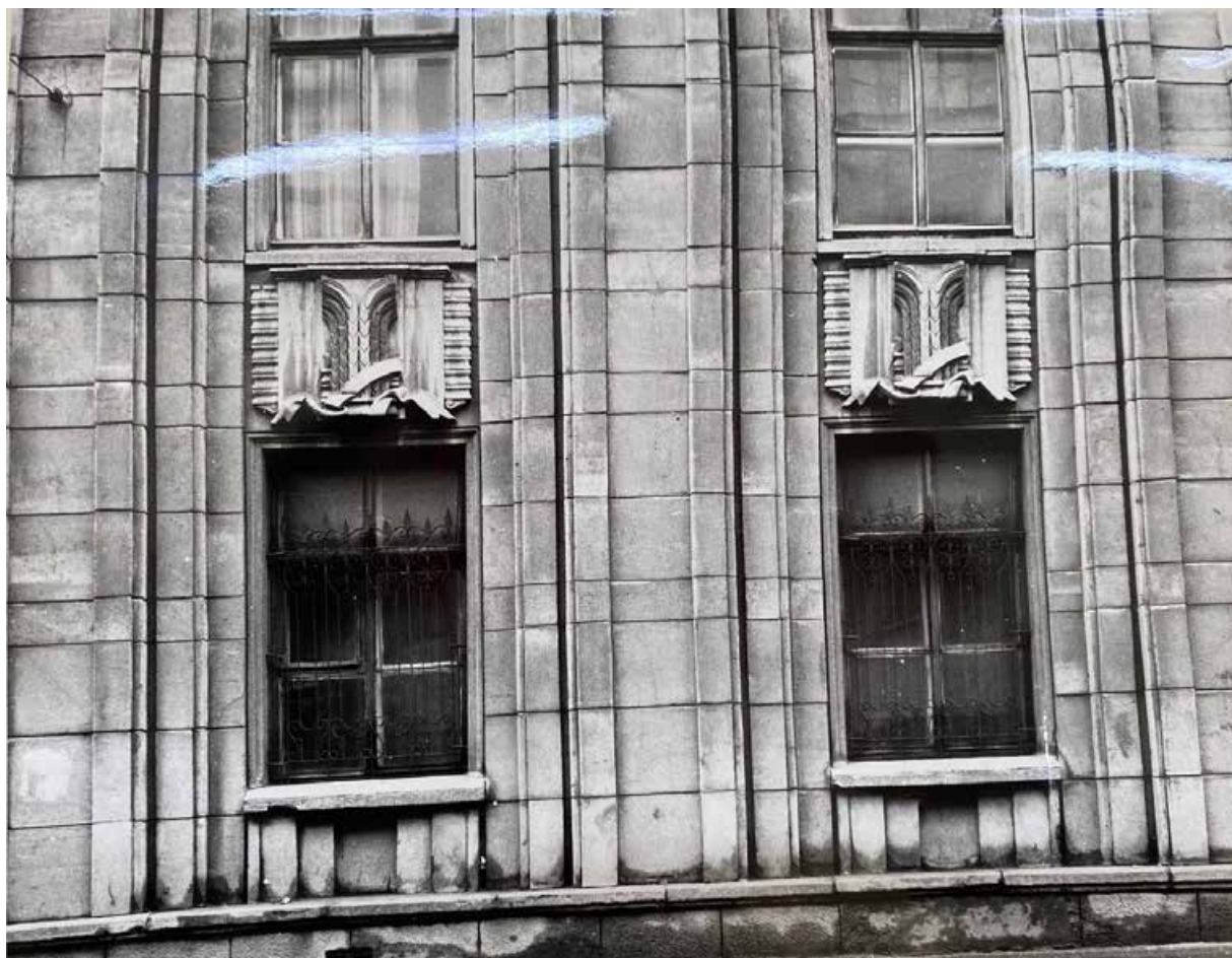
67. Фотофиксация из научно-проектной документации по реставрации фасадов здания ЛОККИ - Архив КГИОП - № 3-1118 от 27.02.2006
