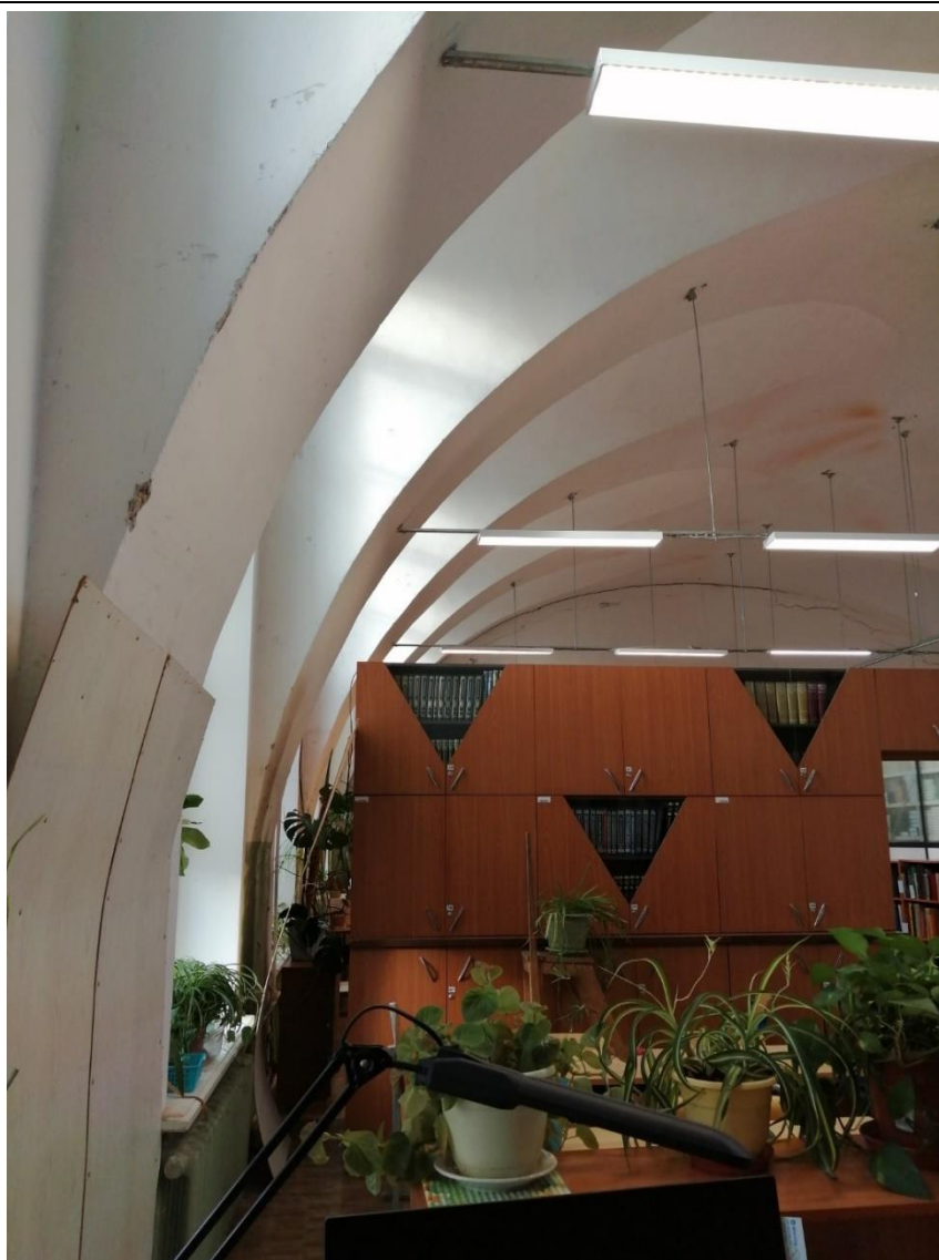
30. Объект культурного наследия федерального значения «Корпус для игры в мяч ("жедепом")», расположенный по адресу: г. Санкт-Петербург, Университетская набережная, дом 7-9-11, литера О. Фрагмент пом. № 1-Н(51) в отметке 1-го этажа.
