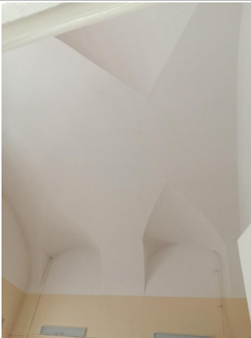
45. Объект культурного наследия федерального значения «Корпус для игры в мяч ("жедепом")», расположенный по адресу: г. Санкт-Петербург, Университетская набережная, дом 7-9-11, литера О. Фрагмент пом. № 1-Н(60) в отметке 1-го этажа.
