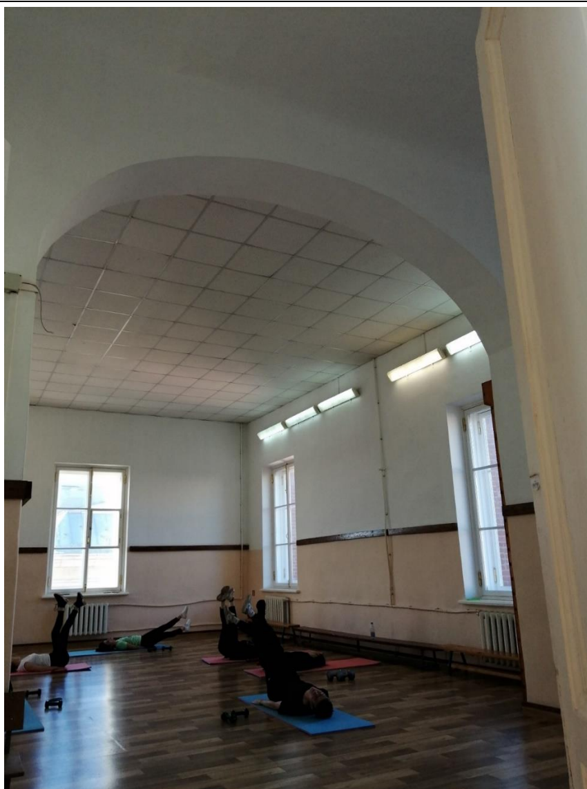
42. Объект культурного наследия федерального значения «Корпус для игры в мяч ("жедепом")», расположенный по адресу: г. Санкт-Петербург, Университетская набережная, дом 7-9-11, литера О. Общий вид пом. № 1-Н(85) в отметке 3-го этажа.
