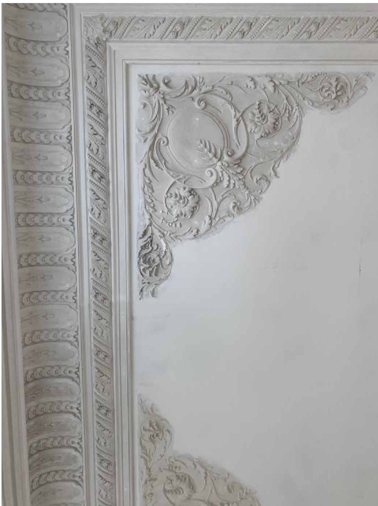
Фото 27. Фрагмент потолка помещения квартиры № 45 объекта культурного наследия.
