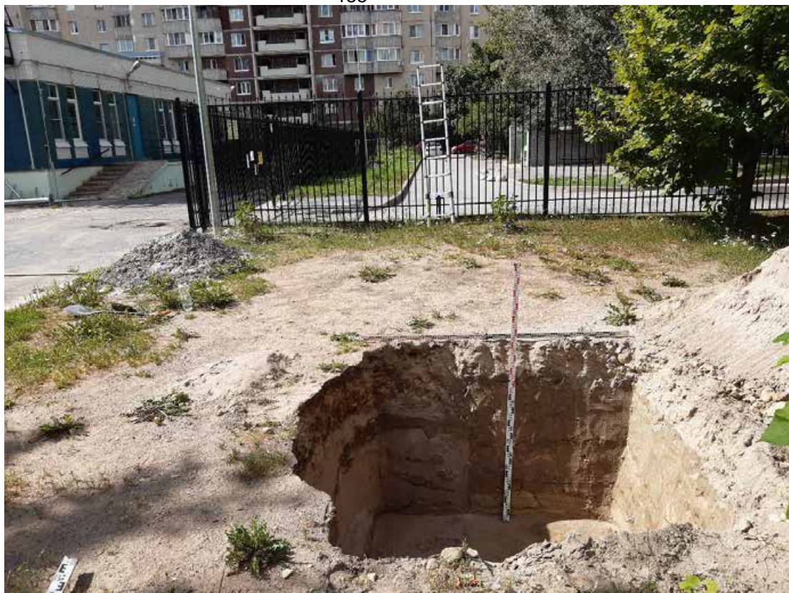
Рис. 126. Санкт-Петербург, «Квартал 61 (ул. Савушкина – Беговая ул. – Школьная ул. – Яхтенная ул.)». Фотофиксация общего вида шурфа 1 с окружающей местностью. Вид на запад.
