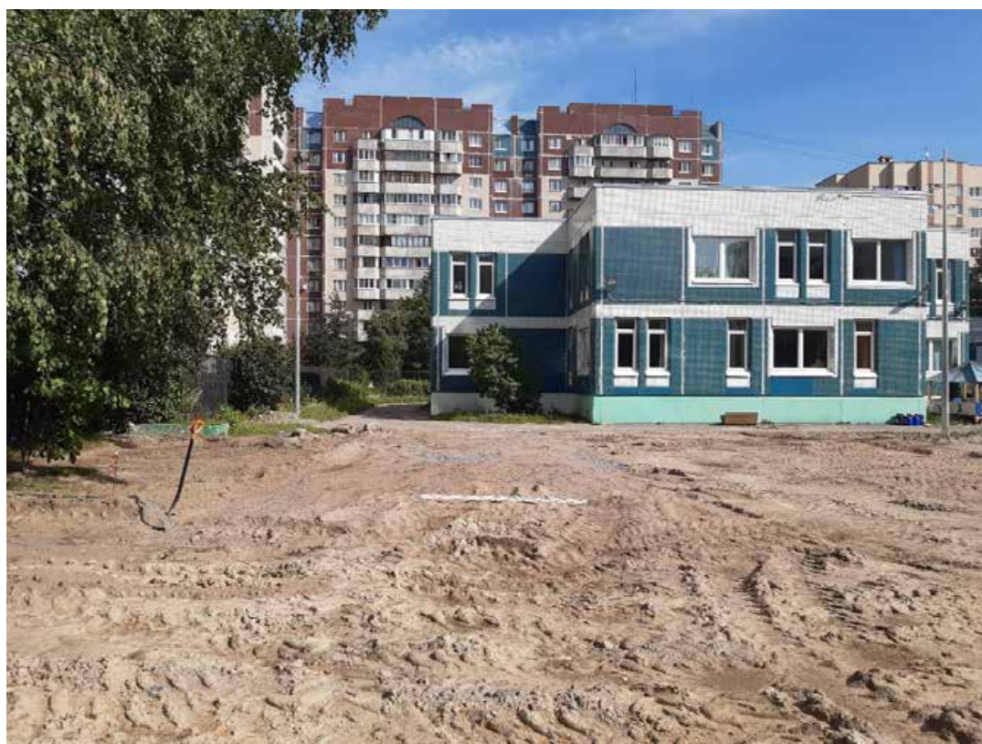
Рис. 152. Санкт-Петербург, «Квартал 61 (ул. Савушкина – Беговая ул. – Школьная ул. – Яхтенная ул.)». Шурф 4. Общий вид до начала работ. Вид на север.
