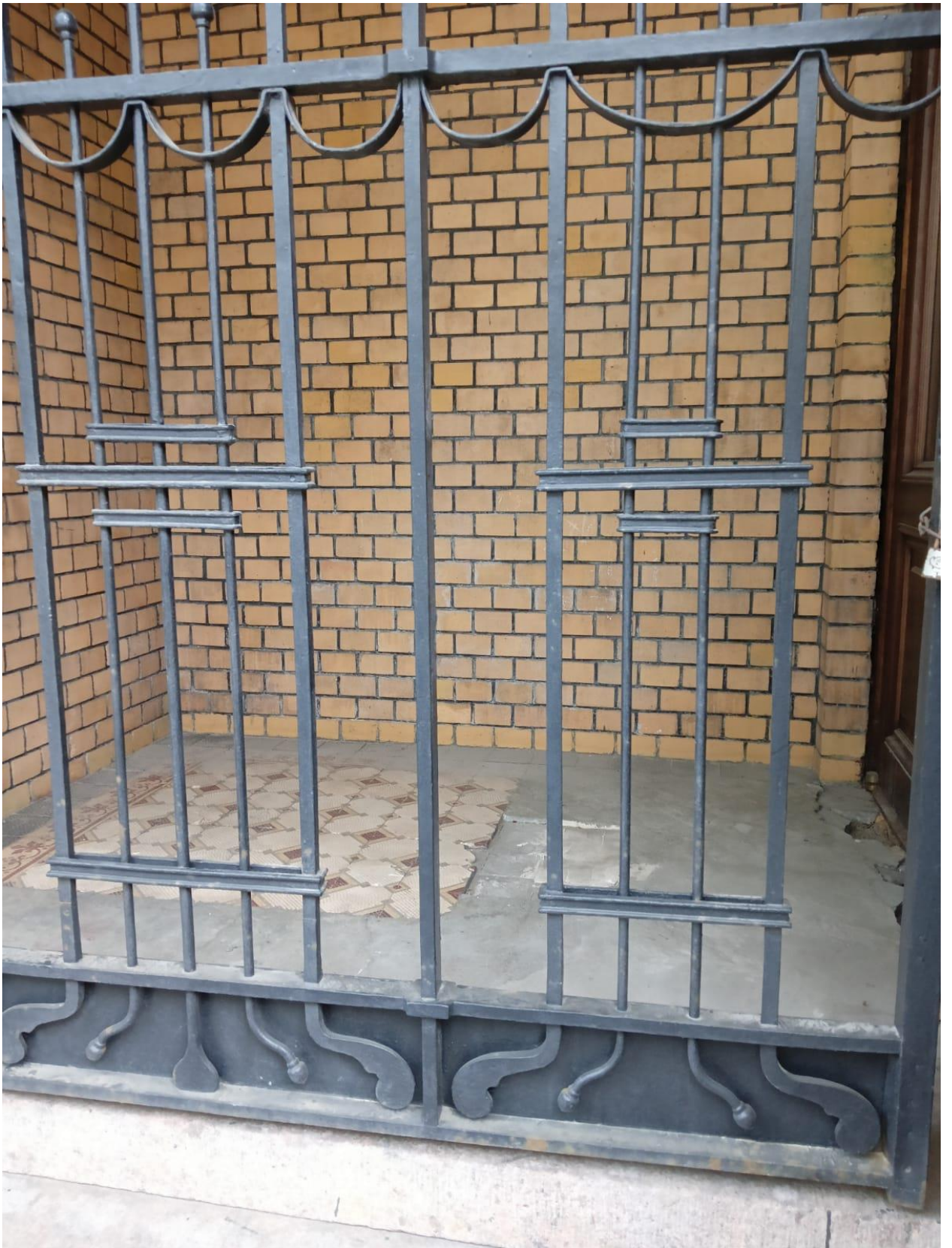
Фото 15. Объект культурного наследия федерального значения «Дом Форостовского П.П.», Санкт-Петербург, 4 линия В.О., дом 9 литера А. Покрытие пола лоджии входа в б. контору – метлахская плитка с мозаичным эффектом (восьмигранная светло-охристого цвета с терракотовым рисунком) со вставками мелкой квадратной плитки.
