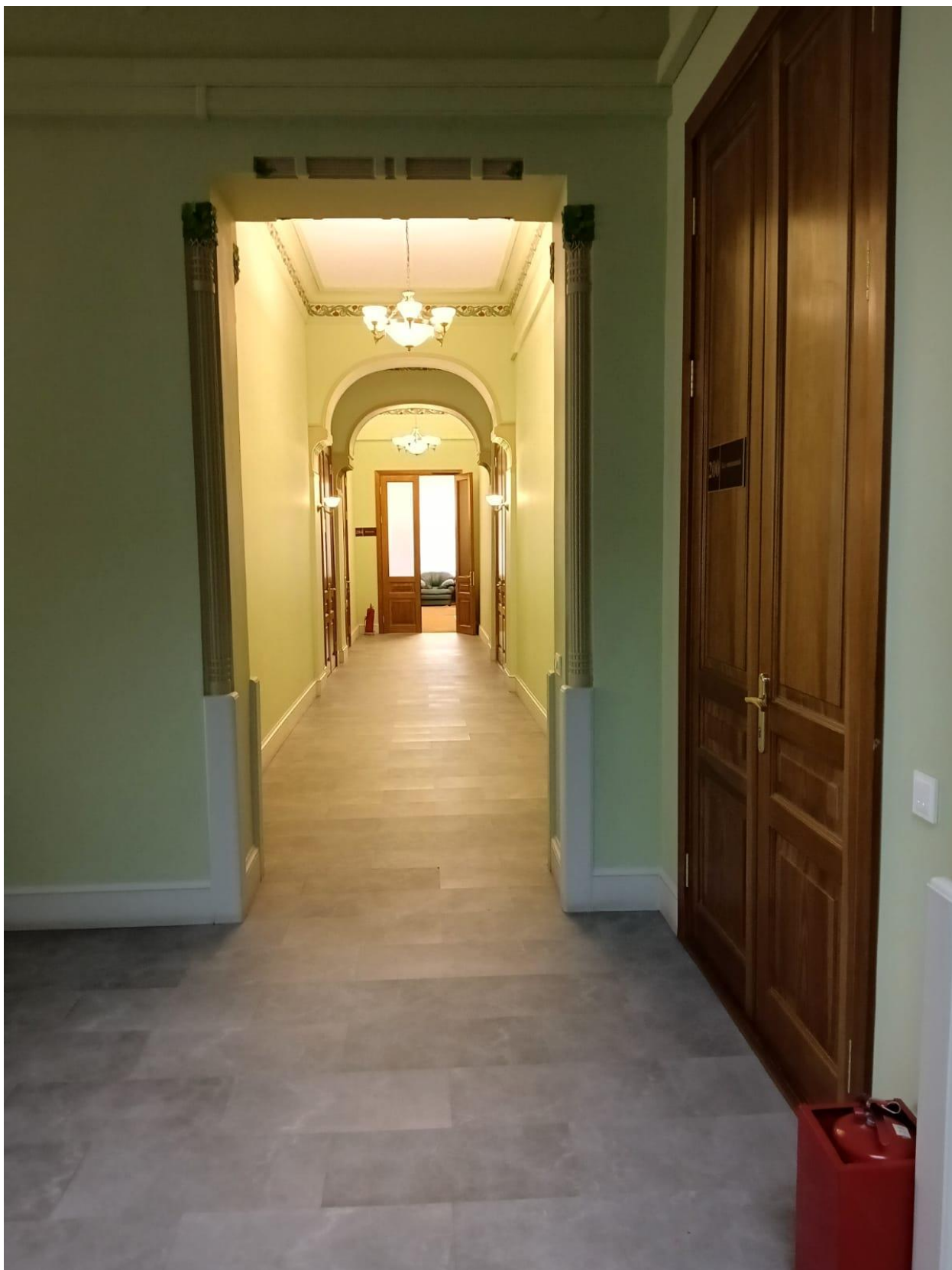
Фото 13. Объект культурного наследия федерального значения «Дом Форостовского П.П.», Санкт-Петербург, 4 линия В.О., дом 9 литера А. Помещение 1-Н (пом.б\н). Вид с площадки второго этажа лестницы. Позднее напольное покрытие.
