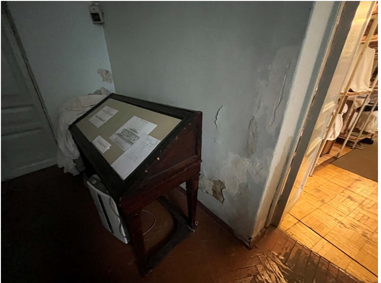
Фото №32. 1-ый этаж, восточное крыло, помещение 1-Н(4), следы намокания конструкций.
