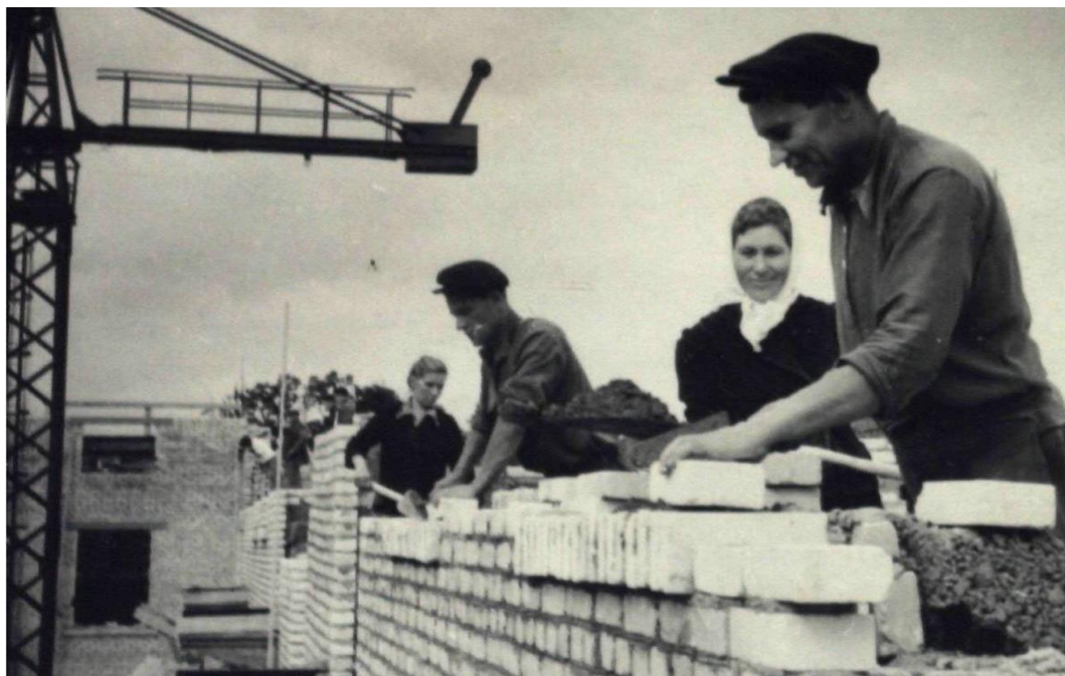
26. ЦГАКФФД СПб. Ар 37947. Каменщик Н.К. Сидоренко, выполняющий по две нормы, и подсобница М.И. Сидоренко за кладкой стены седьмого этажа на строительстве нового стоквартирного дома на углу проспекта Карла Маркса и Сердобольской улицы 17.08.1953 г.
