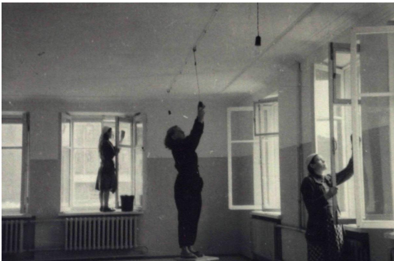
27. ЦГАКФФД СПб. Ар 37945. Отделочные работы в помещении детского сада в новом стоквартирном доме на углу проспекта Карла Маркса и Сердобольской улицы. Жилой дом строится поточно-скоростным методом. 17.08.1953 г.
