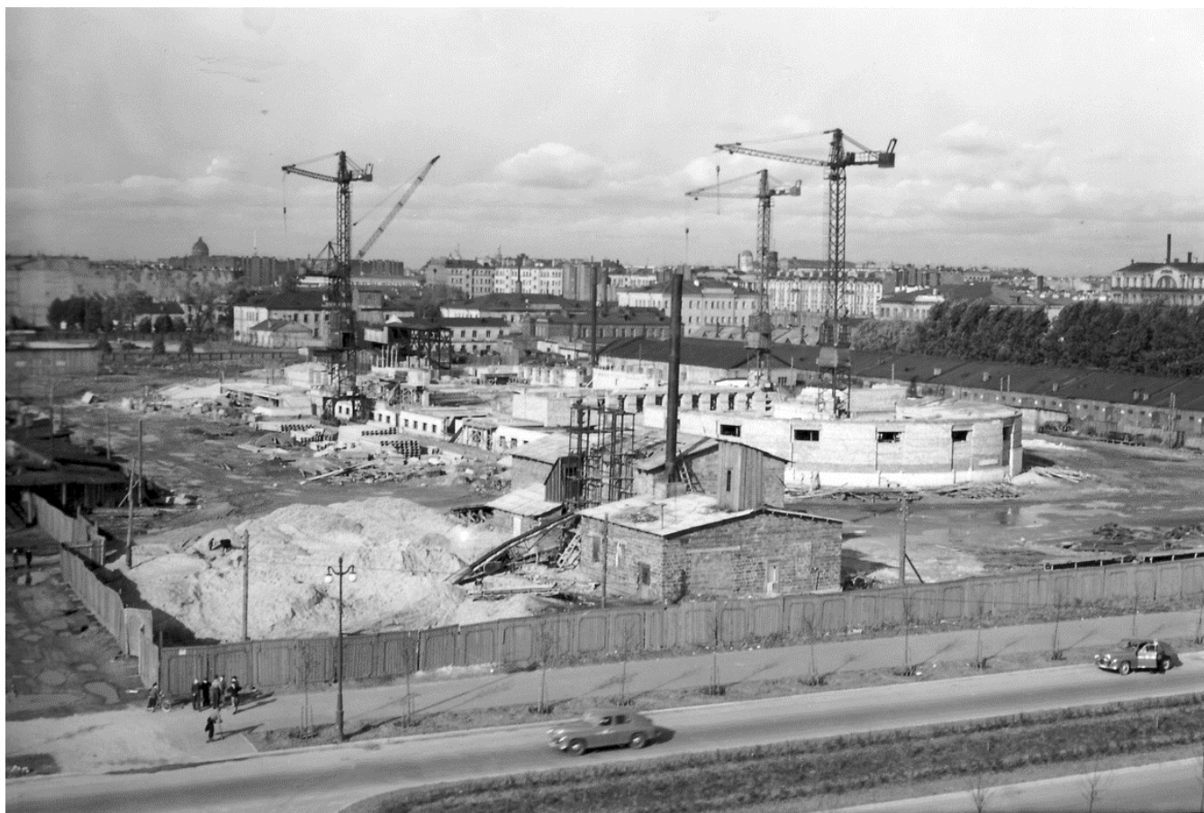
36. ЦГАКФФД СПб. Бр 71410. Вид на строящееся здание театра юных зрителей с южной стороны. 1958 г.
