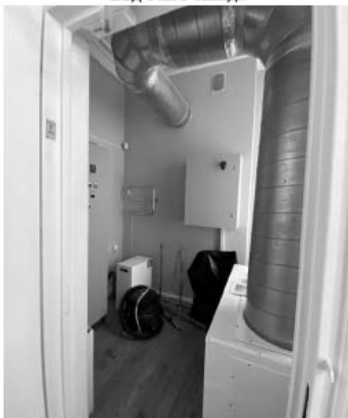
Фото 34. МЫЛЬНЯ. Помещение № 22 согласно плану ПИБ. Помещение с осушителем воздуха. Вид с востока
