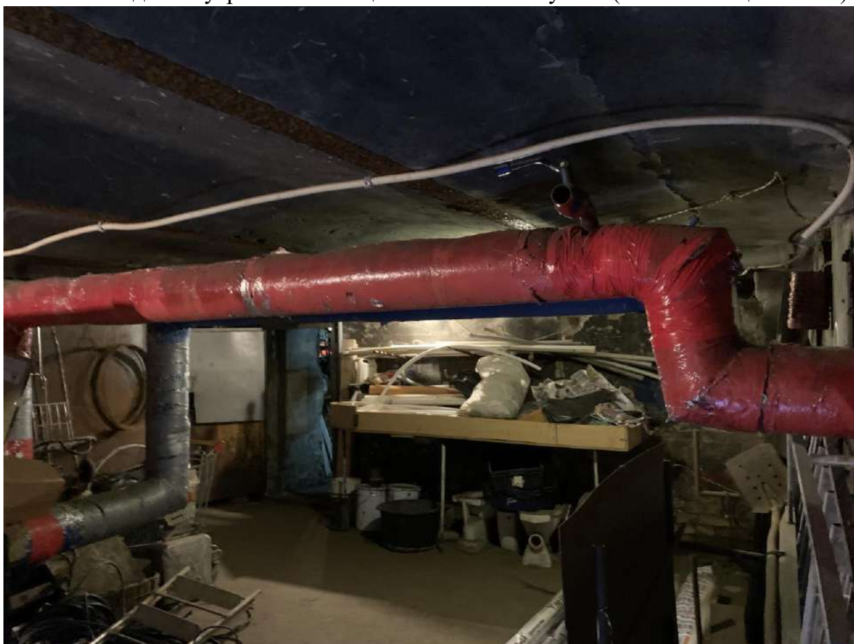
Фото 14. Вид на внутренние помещения теплового пункта (ч.п. 3 помещения 3-Н).
