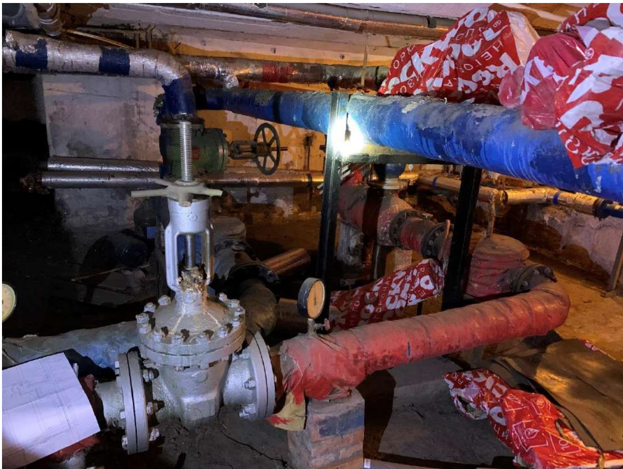
Фото 13. Вид на внутренние помещения теплового пункта (ч.п. 1 помещения 3-Н).
