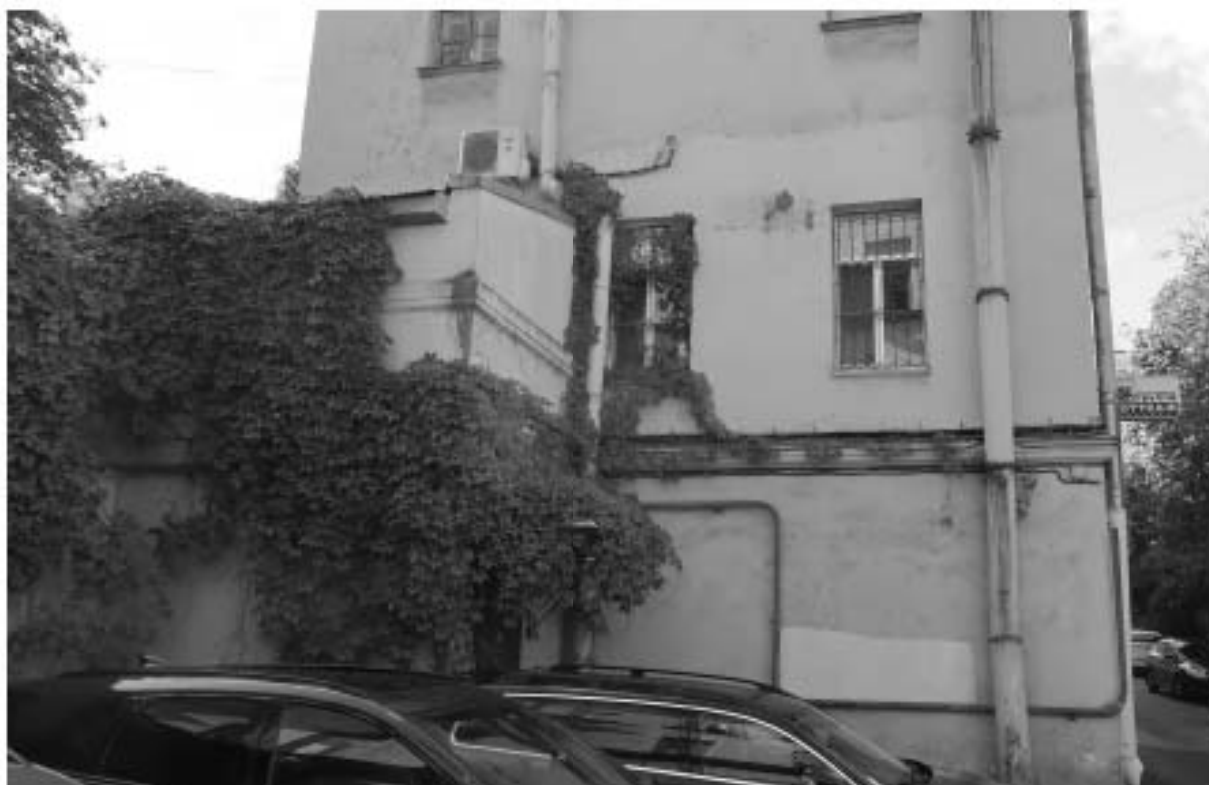
Фото №13. Общий вид фасада. Место расположения оконных проемов в уровне 1 этажа, которые по проекту предусмотрено раскрыть.
