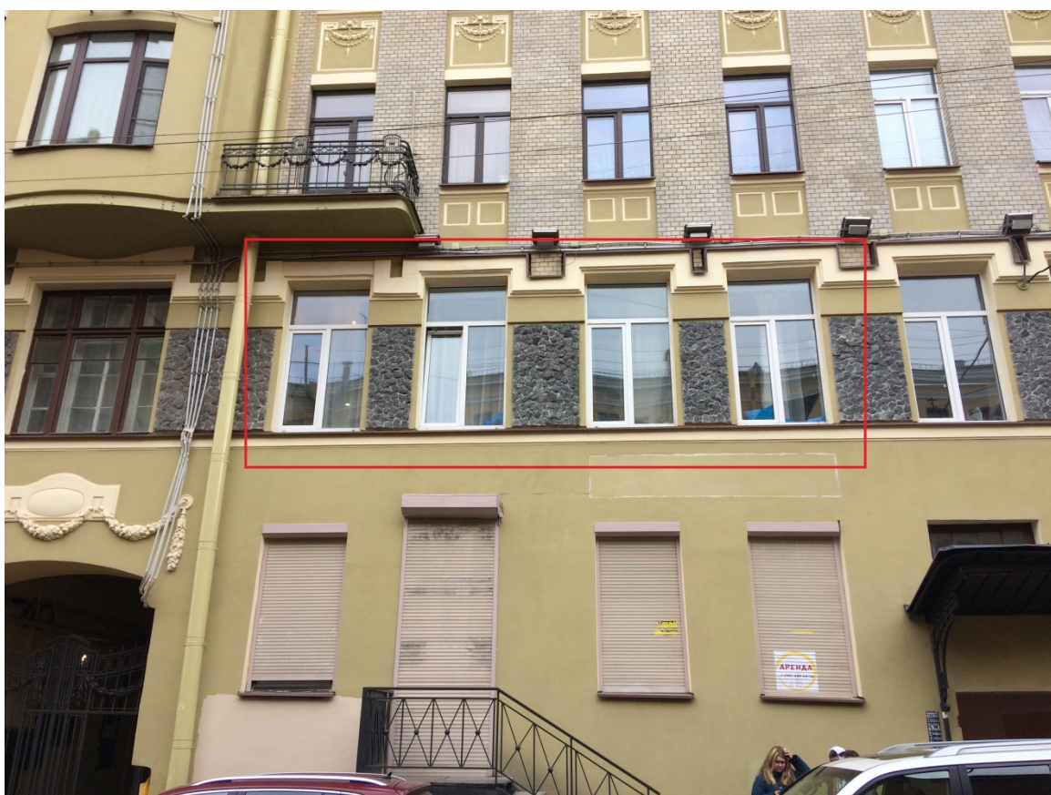
Фото 2. Вид на фасад с переулка Бринько. Оконные проемы квартиры 29.
