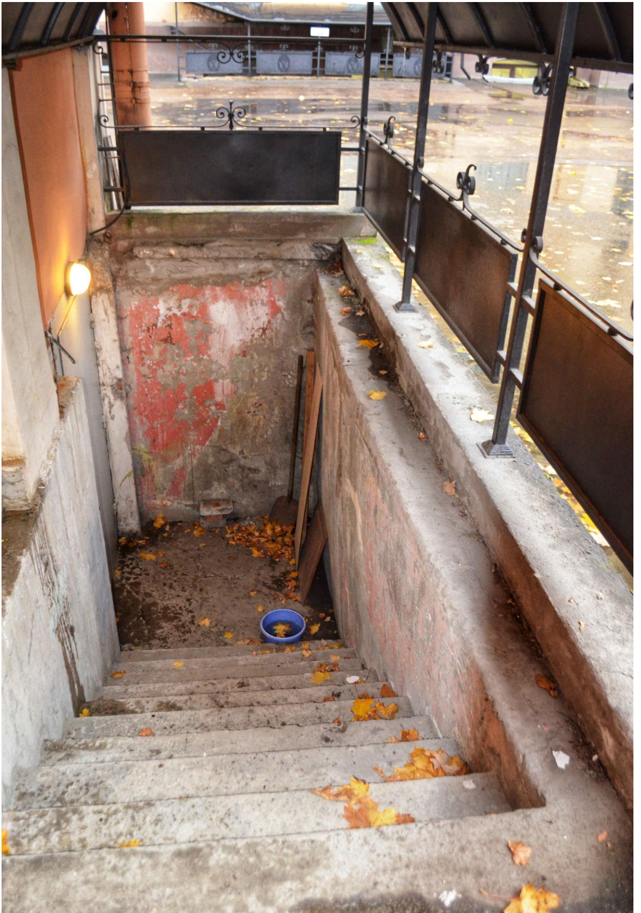
Фото 53. ОКН федерального значения «Корпус Духовской» (наб. реки Монастырки, дом 1, литера Д). Восточный фасад. Вход в подвальное помещение. Фрагмент. Съёмка 23.10.2020 г.
