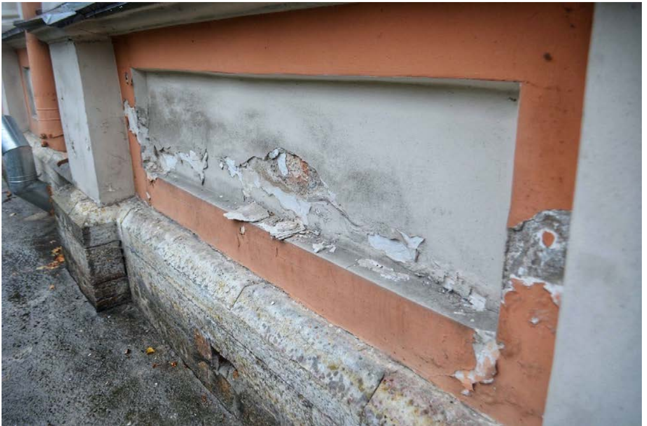
Фото 23. ОКН федерального значения «Корпус Духовской» (наб. реки Монастырки, дом 1, литера Д). Западный фасад. Фрагмент. Съёмка 23.10.2020 г.
