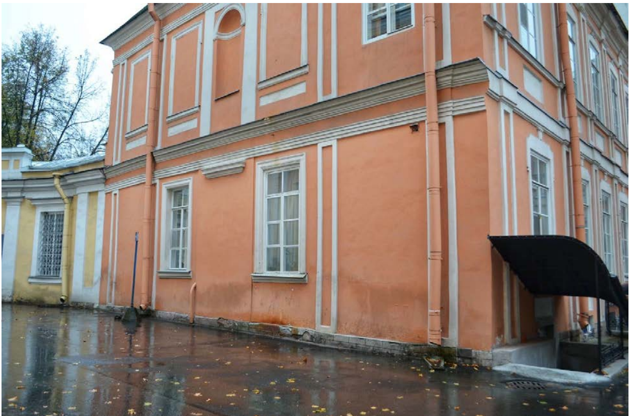
Фото 28. ОКН федерального значения «Корпус Духовской» (наб. реки Монастырки, дом 1, литера Д). Южный фасад. Фрагмент. Съемка 23.10.2020 г.
