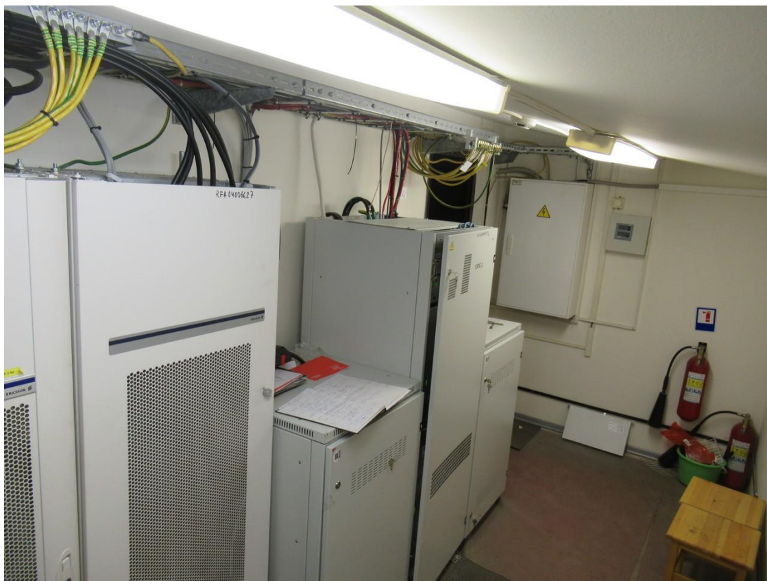
Фото 9. Интерьер аппаратной объекта культурного наследия федерального значения «Дом Министерский Первый»
