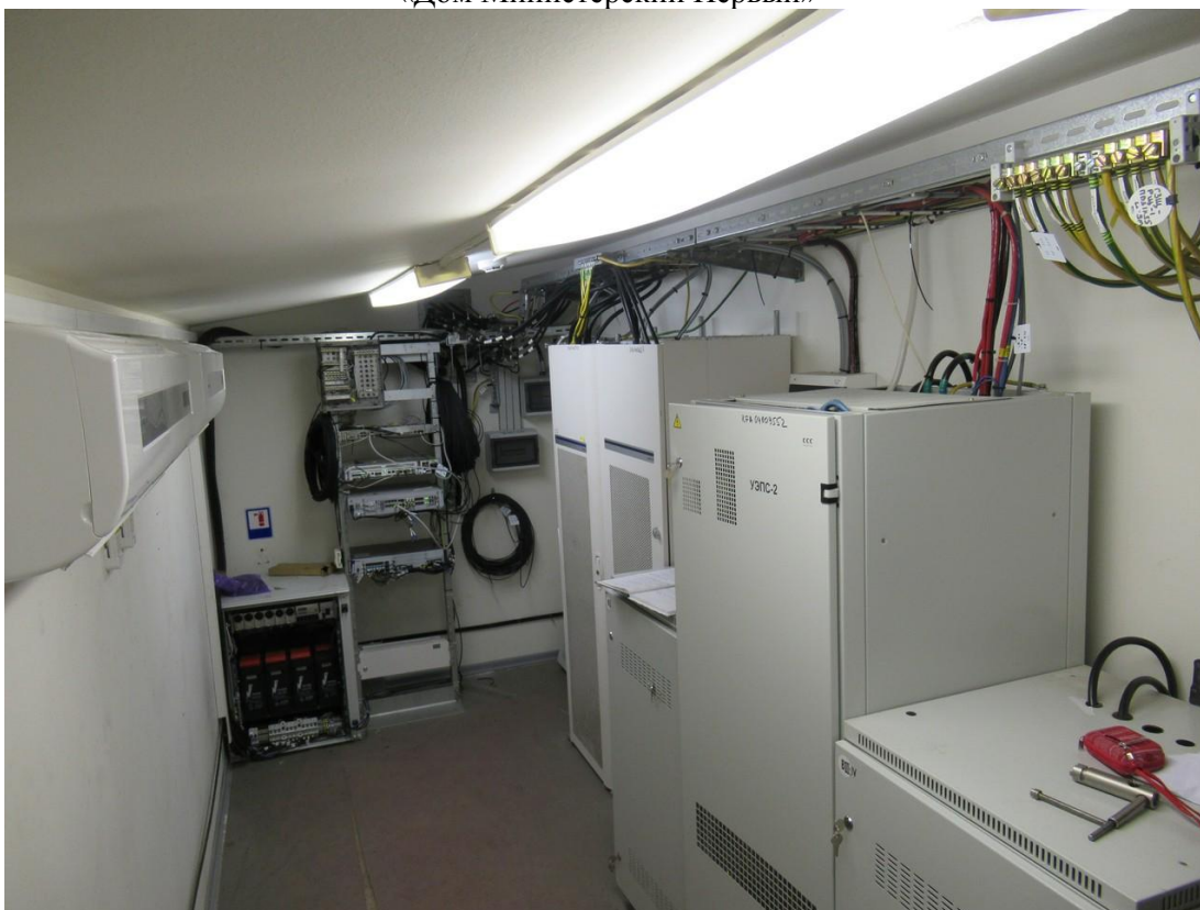
Фото 8. Интерьер аппаратной объекта культурного наследия федерального значения «Дом Министерский Первый»
