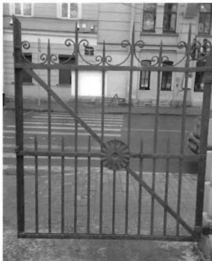
Фото 7: фрагмент объекта культурного наследия. Металлические ворота по Таврической ул. (Вид со стороны объекта культурного наследия федерального значения «Сад Таврический с прудом»).
