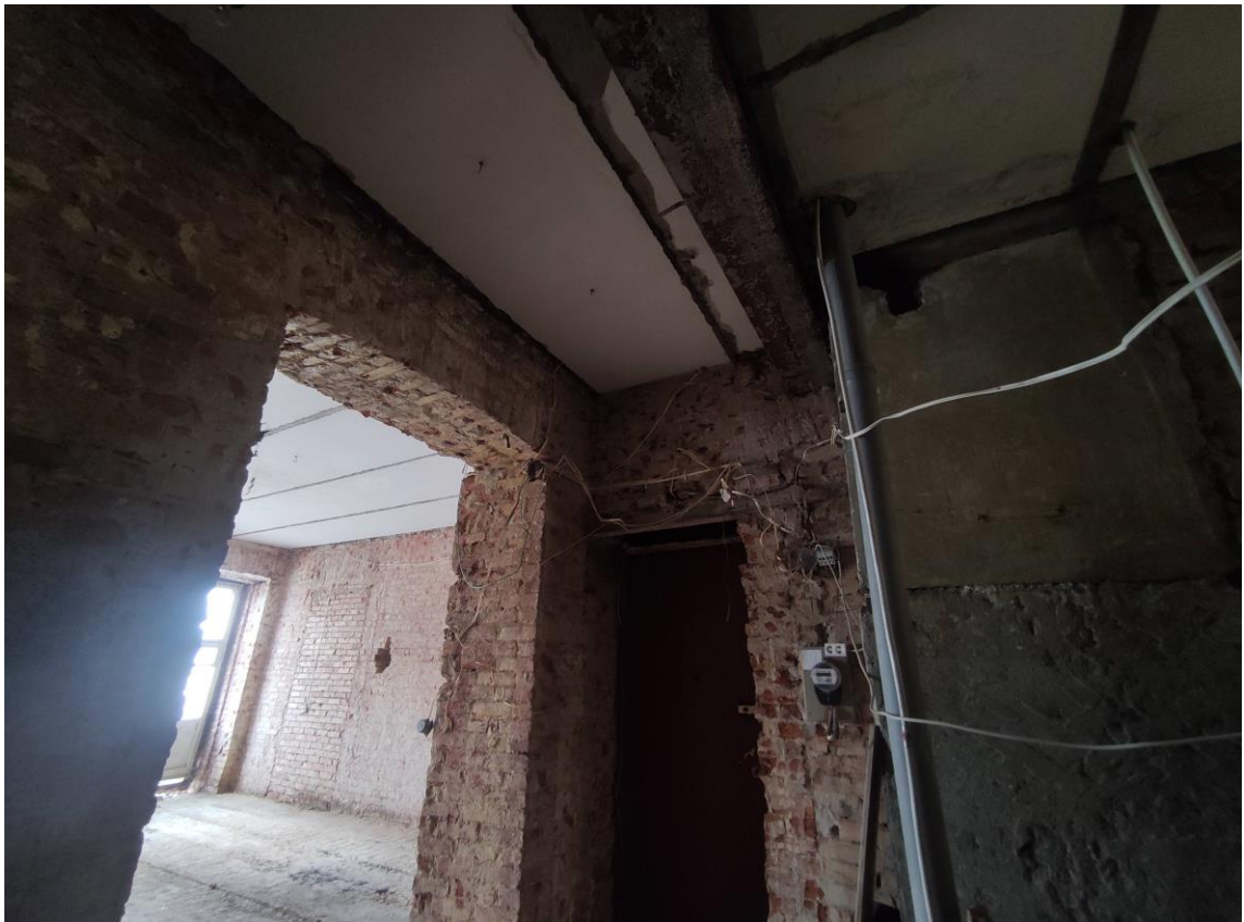
Фото 26. Объект культурного наследия регионального значения «Жилой дом», расположенный по адресу: Санкт-Петербург, улица Ефимова, дом 6, литера А. Фрагмент пом. № 40(1-4).
