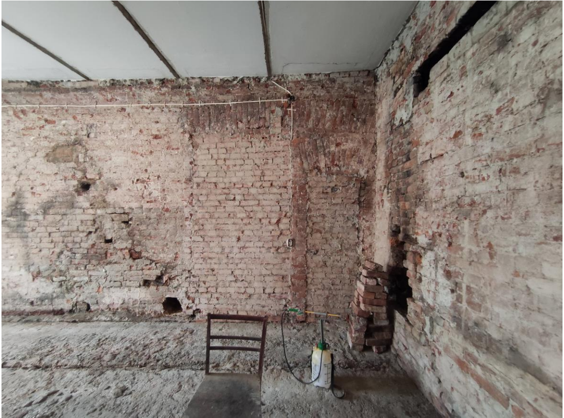
Фото 42. Объект культурного наследия регионального значения «Жилой дом», расположенный по адресу: Санкт-Петербург, улица Ефимова, дом 6, литера А. Фрагмент пом. № 40(5).
