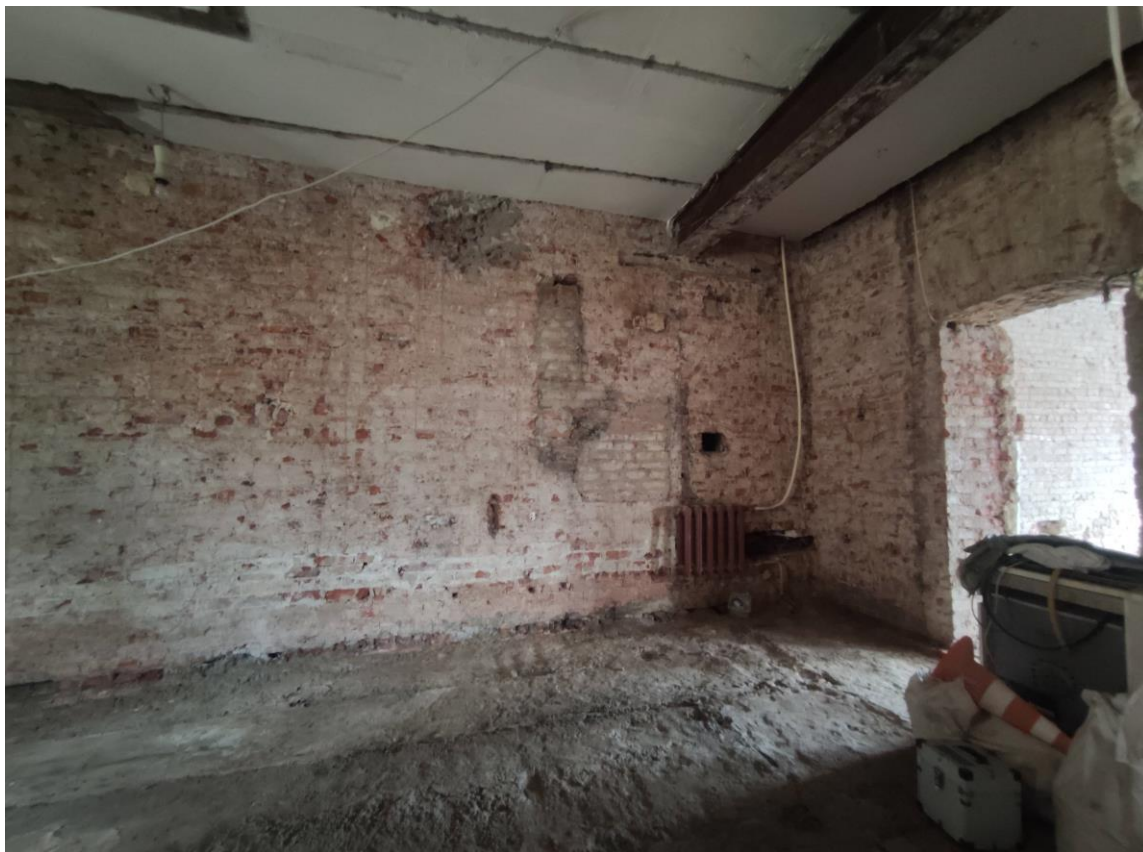
Фото 43. Объект культурного наследия регионального значения «Жилой дом», расположенный по адресу: Санкт-Петербург, улица Ефимова, дом 6, литера А. Фрагмент пом. № 40(5).
