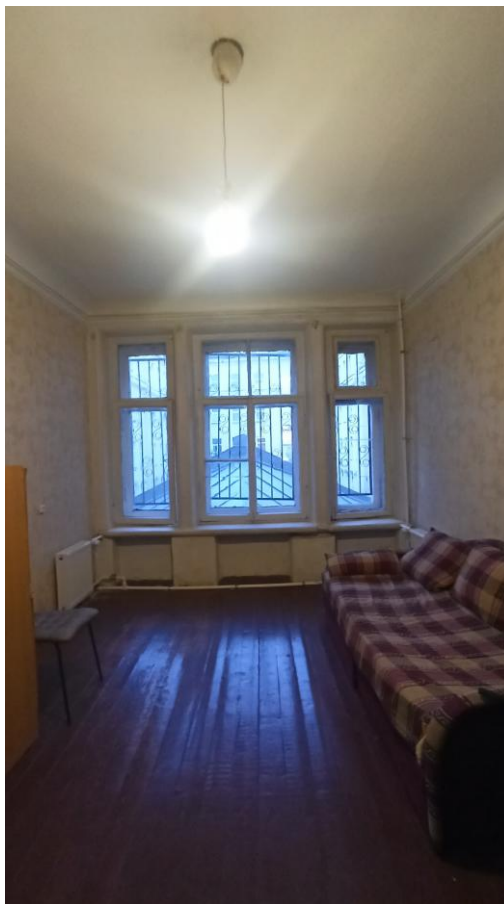
Фото 7. Интерьер квартиры № 57 объекта культурного наследия регионального значения «Дом по Большой Конюшенной ул. с флигелями», входящего в состав ансамбля «Доходные дома фон Дервиза П.П. (великих князей Бориса и Кирилла Владимировичей)»
