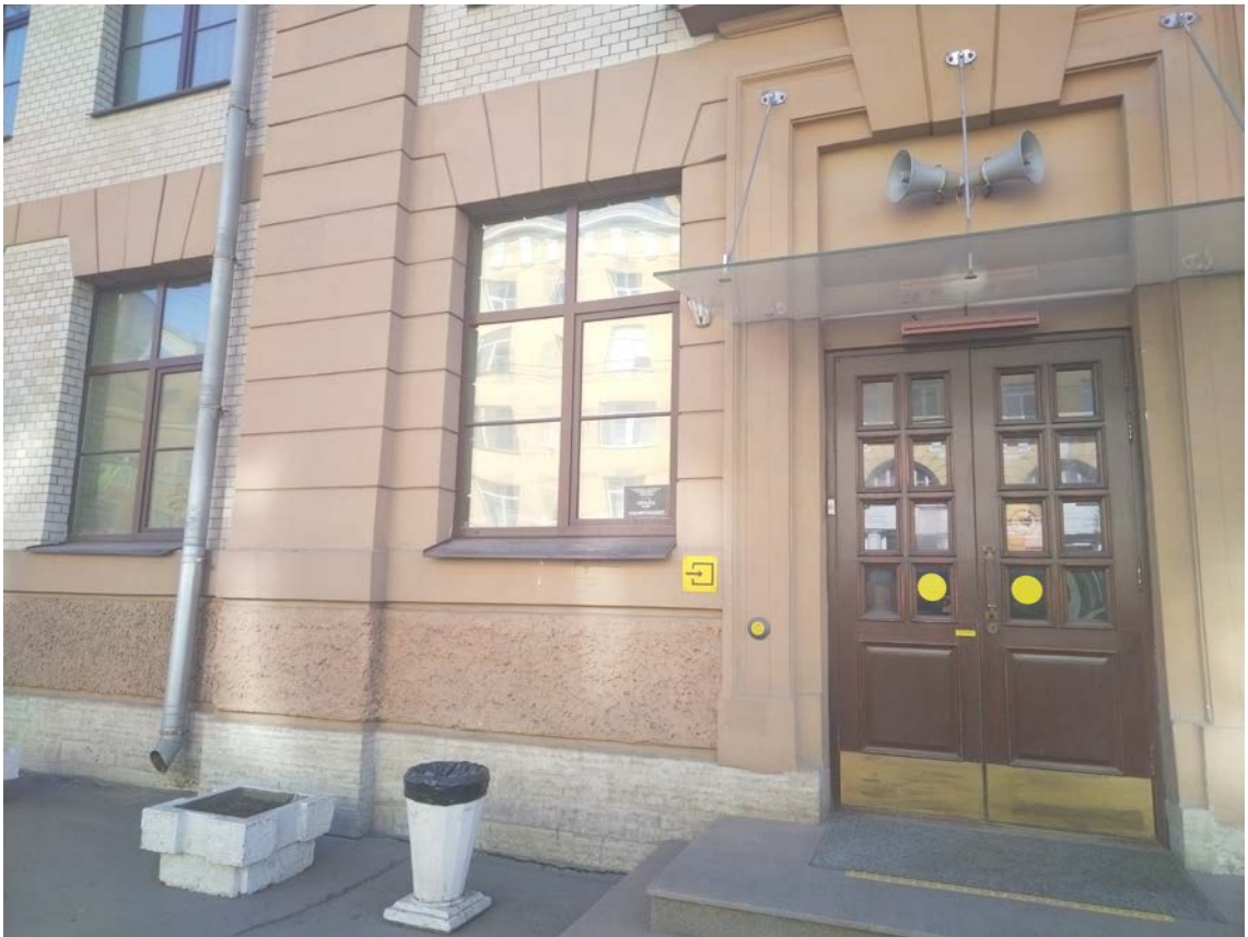
3. Выявленный объект культурного наследия «Здание ремесленного училища Русского технического общества при Петроградском Металлическом заводе». Фрагмент лицевого фасада. 01.09.2023
