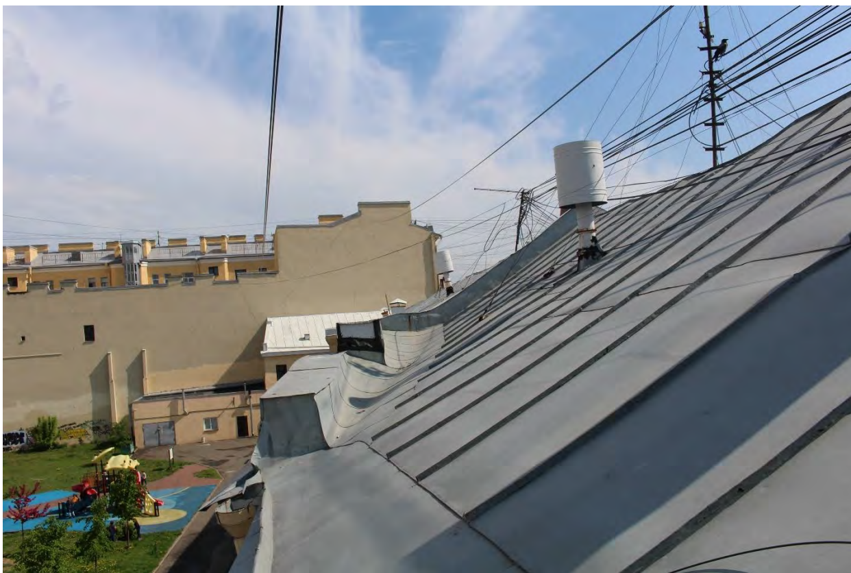
Фото 17. Вид с крыши лицевого корпуса выявленного объекта культурного наследия «Манеж и конюшни лейб-гвардии Гренадерского полка (здание тира лейб-гвардии Стрелкового батальона)». Фото 22.05.2023 г.
