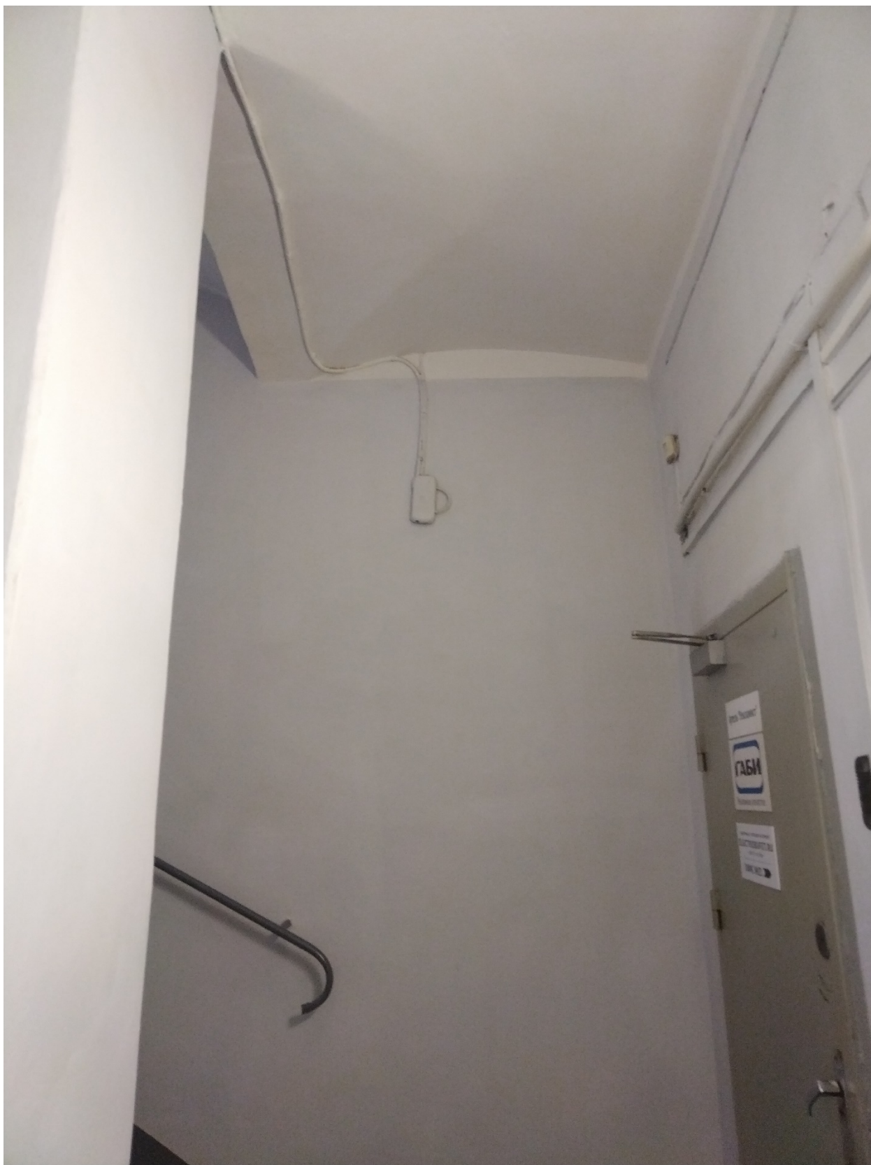
8. Выявленный объект культурного наследия «Дом жилой». Санкт-Петербург, Гончарная ул., д. 25, литера А. Помещение лестницы Л-3. Сводчатые перекрытия. Дата съемки: 12.07.2023.
