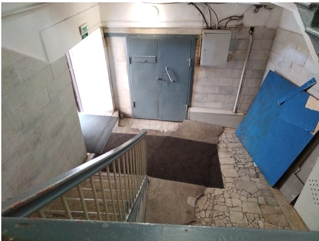
16. Выявленный объект культурного наследия «Дом жилой». Санкт-Петербург, Гончарная ул., д. 25, литера А. Помещение лестницы Л-1. 1 этаж. Дата съемки: 12.07.2023.
