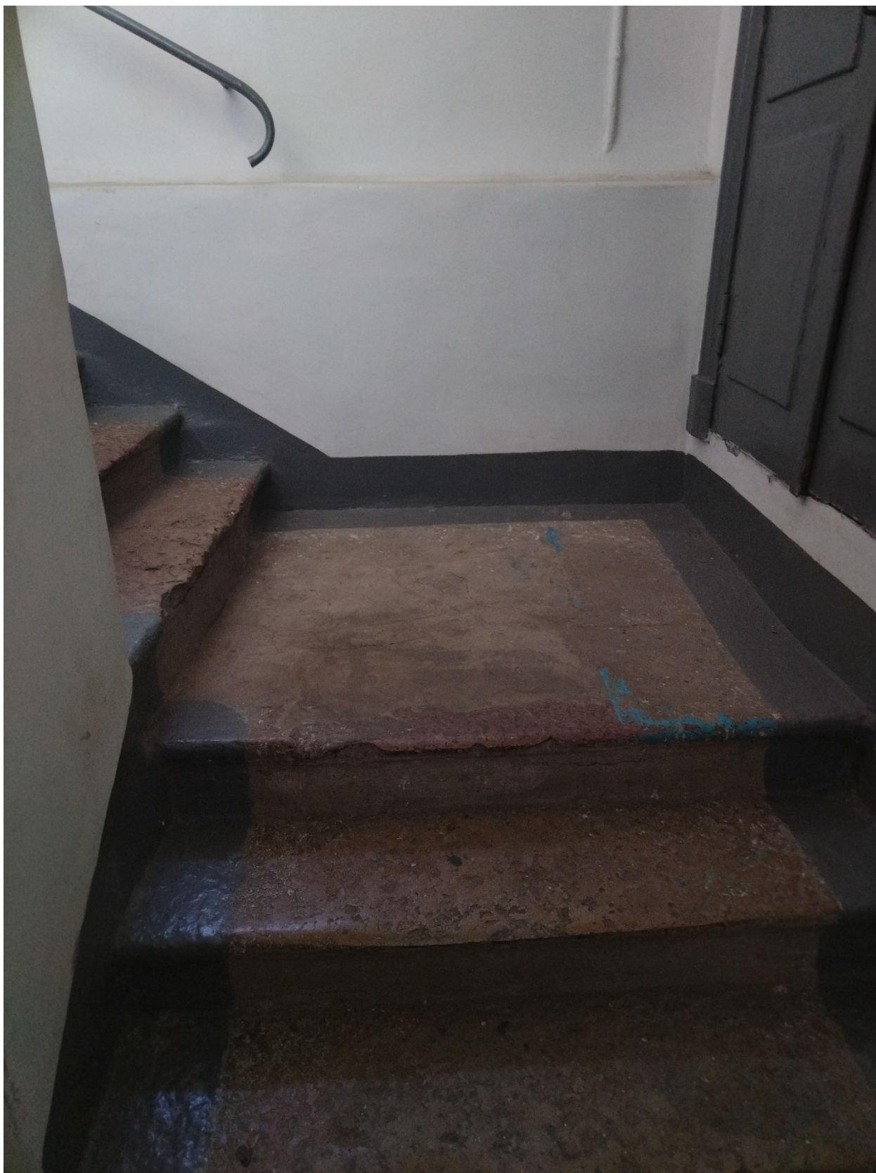
4. Выявленный объект культурного наследия «Дом жилой». Санкт-Петербург, Гончарная ул., д. 25, литера А. Помещение лестницы Л-3. Площадка и ступени лещадной плиты. Дата съемки: 12.07.2023.
