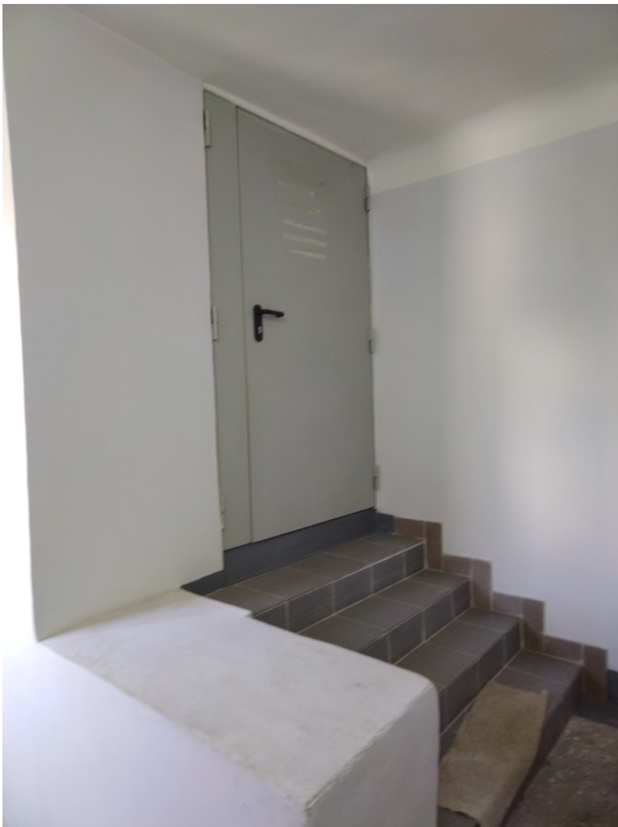
11. Выявленный объект культурного наследия «Дом жилой». Санкт-Петербург, Гончарная ул., д. 25, литера А. Помещение лестницы Л-3. Выход на чердачное помещение. Дата съемки: 12.07.2023.
