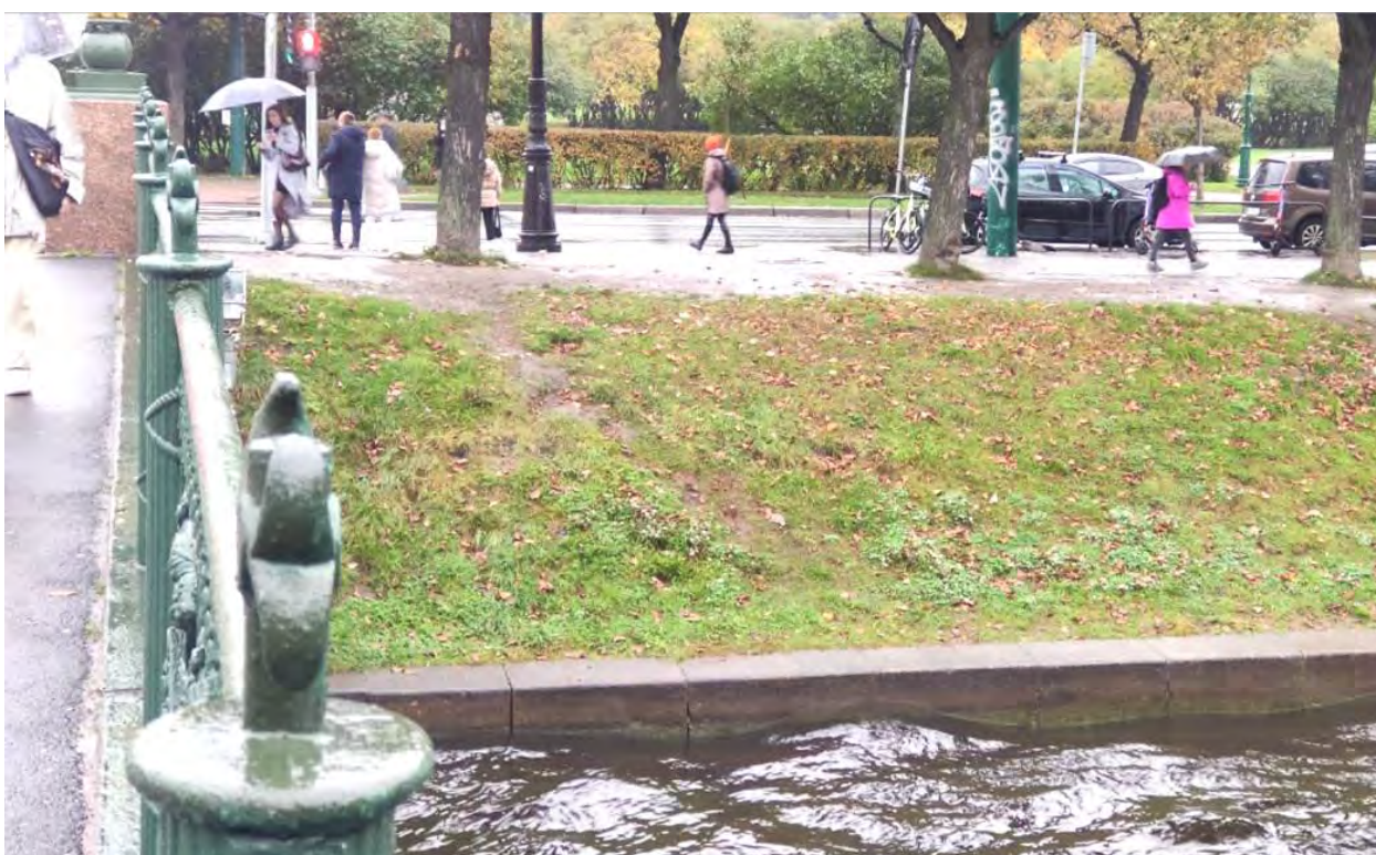
Фото 10. На гранитной облицовке подпорной стенки набережной видны биопоражения. Фото – Давыдова Н.А., 10.10.2020.
