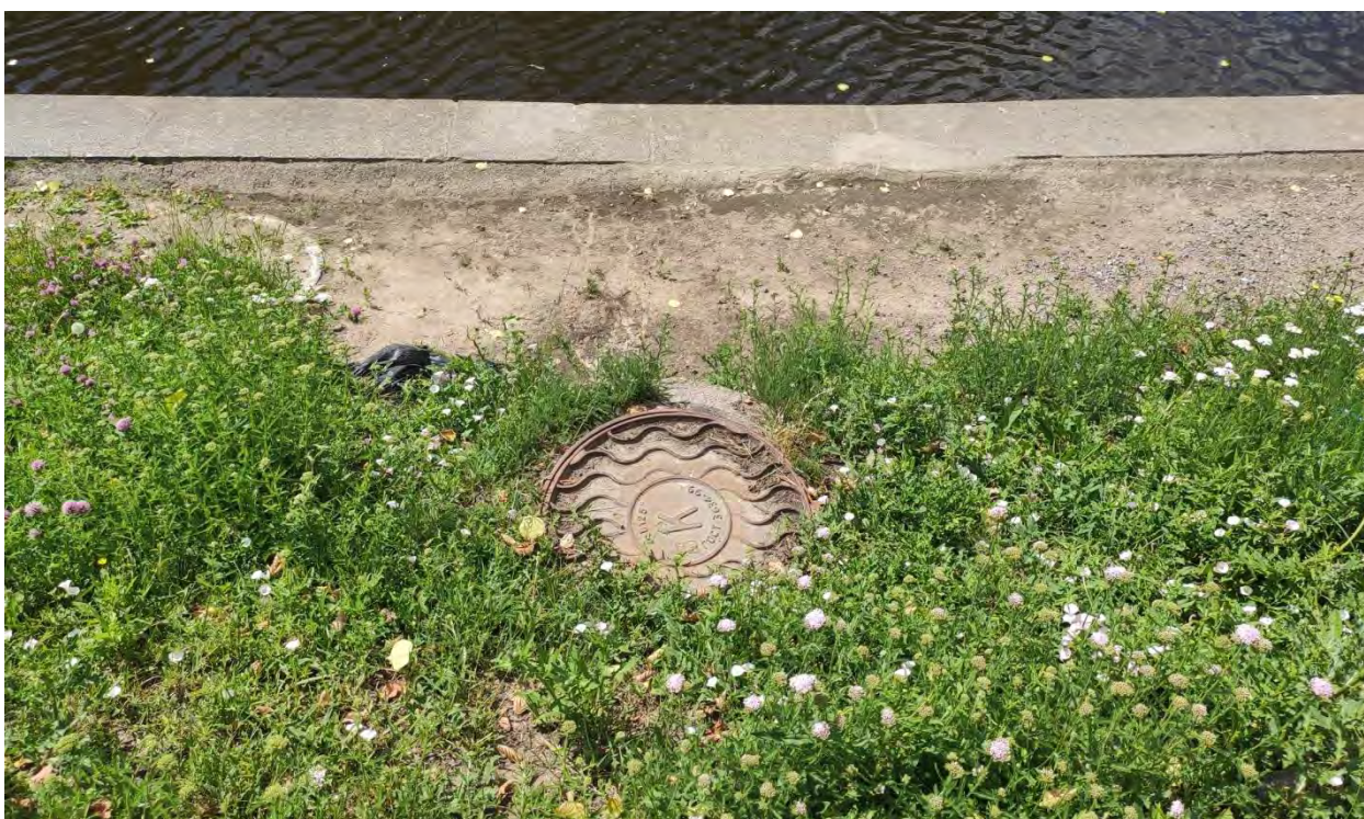
Фото 4. Вид на колодец канализационной сети в откосе в месте размыва откоса и деформации подпорной стенки набережной. Фото – Давыдова Н.А., 22.06.2020.
