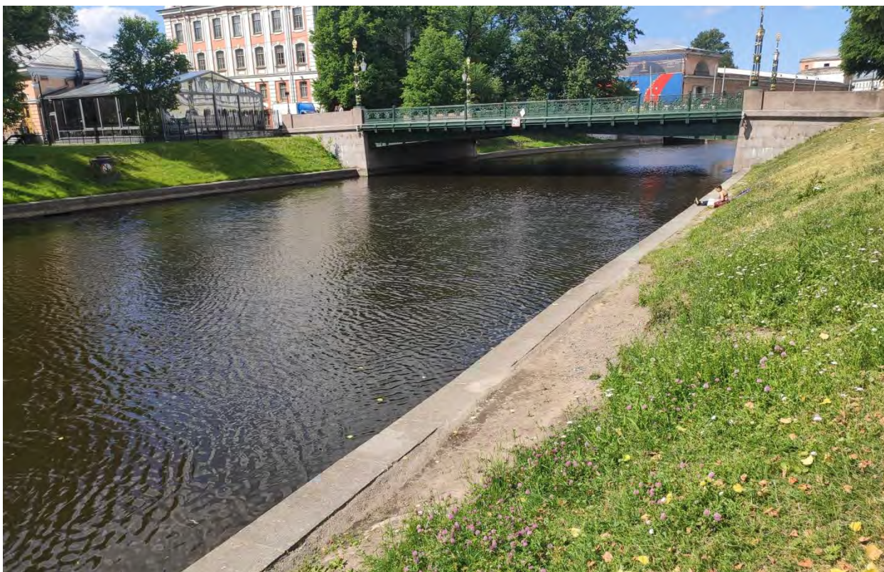
Фото 3. Вид на участок «проседания» подпорной стенки в вертикальном направлении в зоне ранее имеющегося размыва от поврежденных инженерных сетей (в настоящее время отремонтированы). Фото – Давыдова Н.А., 22.06.2020.
