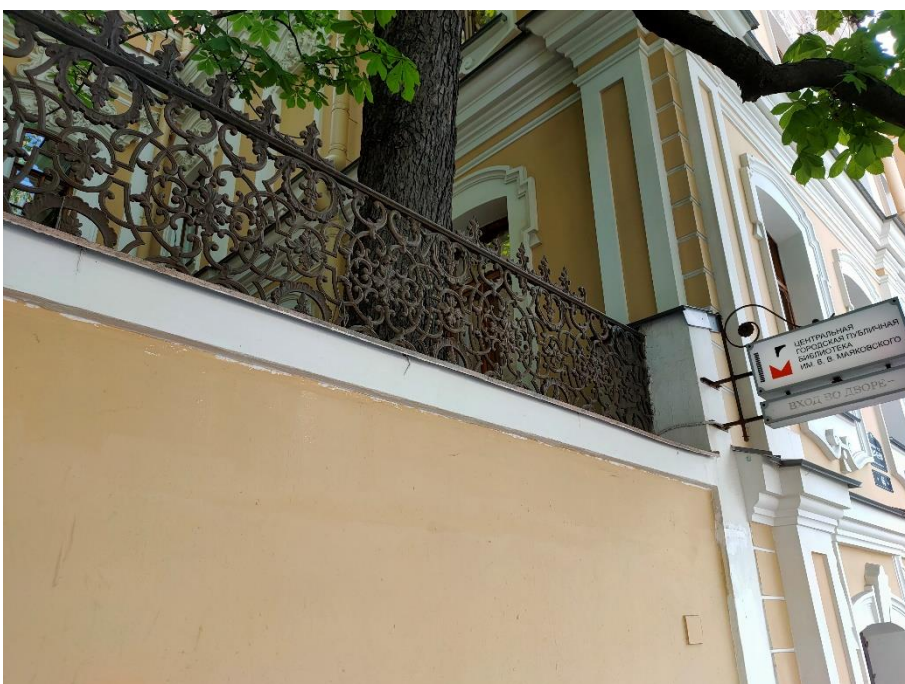
24. «Ограда с воротами», входящие в состав объекта культурного наследия федерального значения «Дом Дубянских (Зиновьева Н.В., Карловой Н.Ф.)», наб. р. Фонтанки, д.46. Западная часть ограды. Фрагмент. Фото 15.05.2023г.
