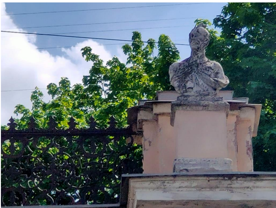
35. «Ограда с воротами», входящие в состав объекта культурного наследия федерального значения «Дом Дубянских (Зиновьева Н.В., Карловой Н.Ф.), наб. р. Фонтанки, д.46. Западная часть ограды. Фрагмент. Фото 15.05.2023г.
