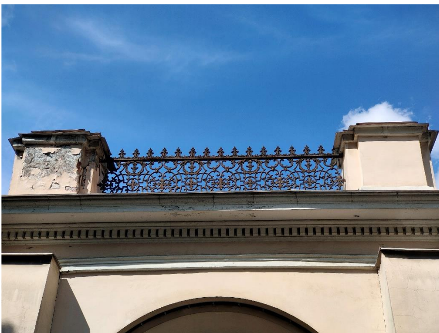
10. «Ограда с воротами», входящие в состав объекта культурного наследия федерального значения «Дом Дубяньских (Зиновьева Н.В., Карловой Н.Ф.), наб. р. Фонтанки, д.46. Восточная часть ограды. Фрагмент. Фото 15.05.2023г.
