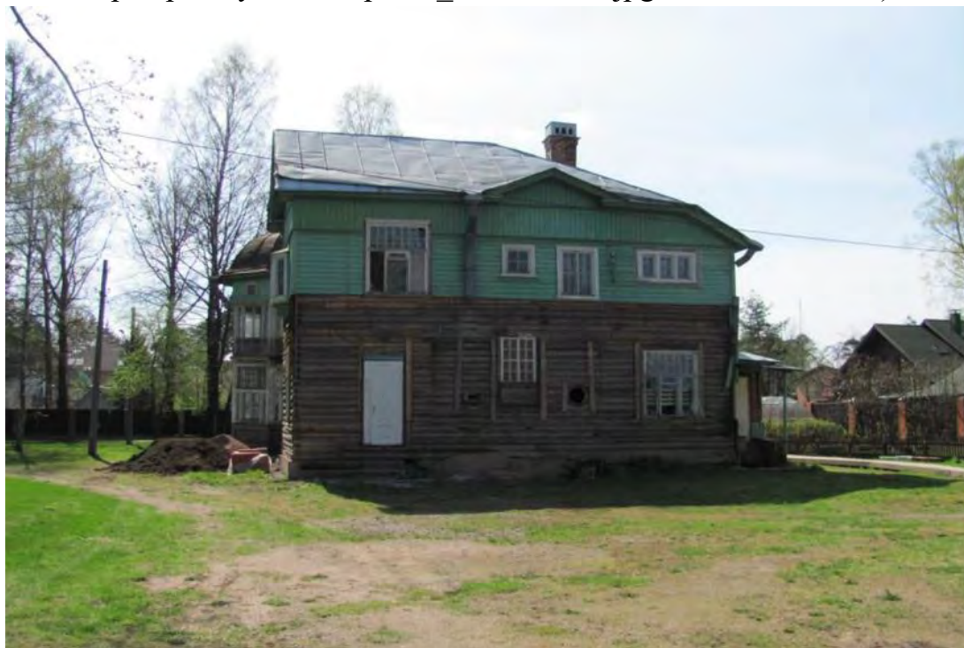
Илл. 57. Вид со стороны ул. Граничной на северный фасад 2-х этажного деревянного здания. 2015 г. (источник: Акт ГИКЭ рег. № 01-24-2401/17 от 03.07.2017 г.).
