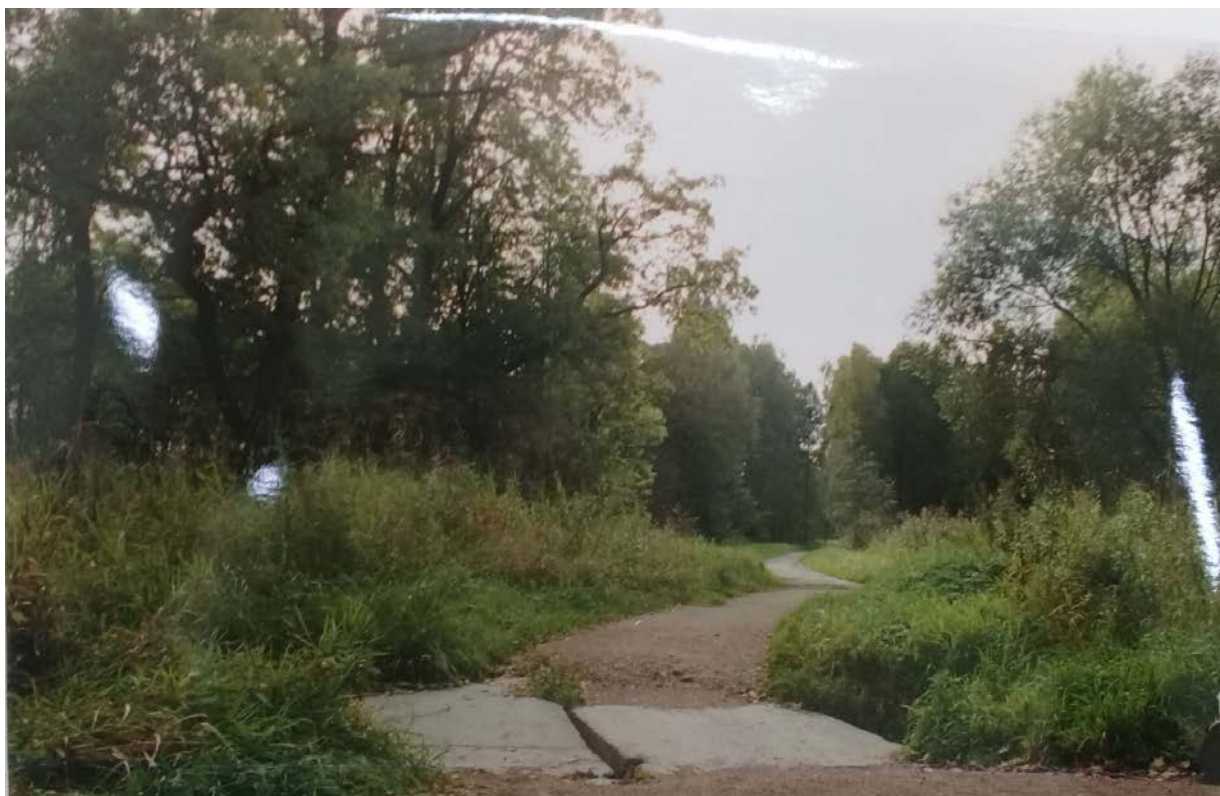
Илл. 12. Центральная часть парка. Разрушенный гранитный мост через Павловский водовод на Тярлевской дороге (мост «у Дубка на Царскосельском водопроводе в Отдельном парке»). Фото 2004 г. из паспорта памятника «Отдельный парк. Ансамбль» 29.04.2005 г. Архив КГИОП. П.226-111. инв. № 1139П.
