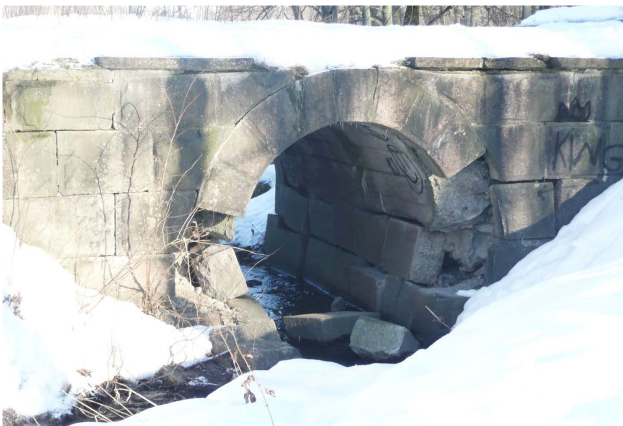
Фото 10. Смещение камней облицовки моста с верховой стороны.
