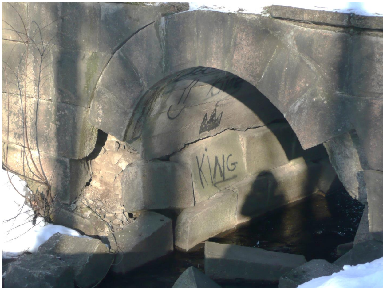
Фото 9. Вывалы гранитных камней облицовки. Свод верховой стороны.
