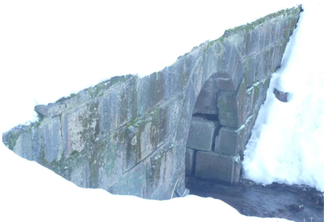
Фото 16. Смещение камней облицовки свода. Вид с низовой стороны моста.
