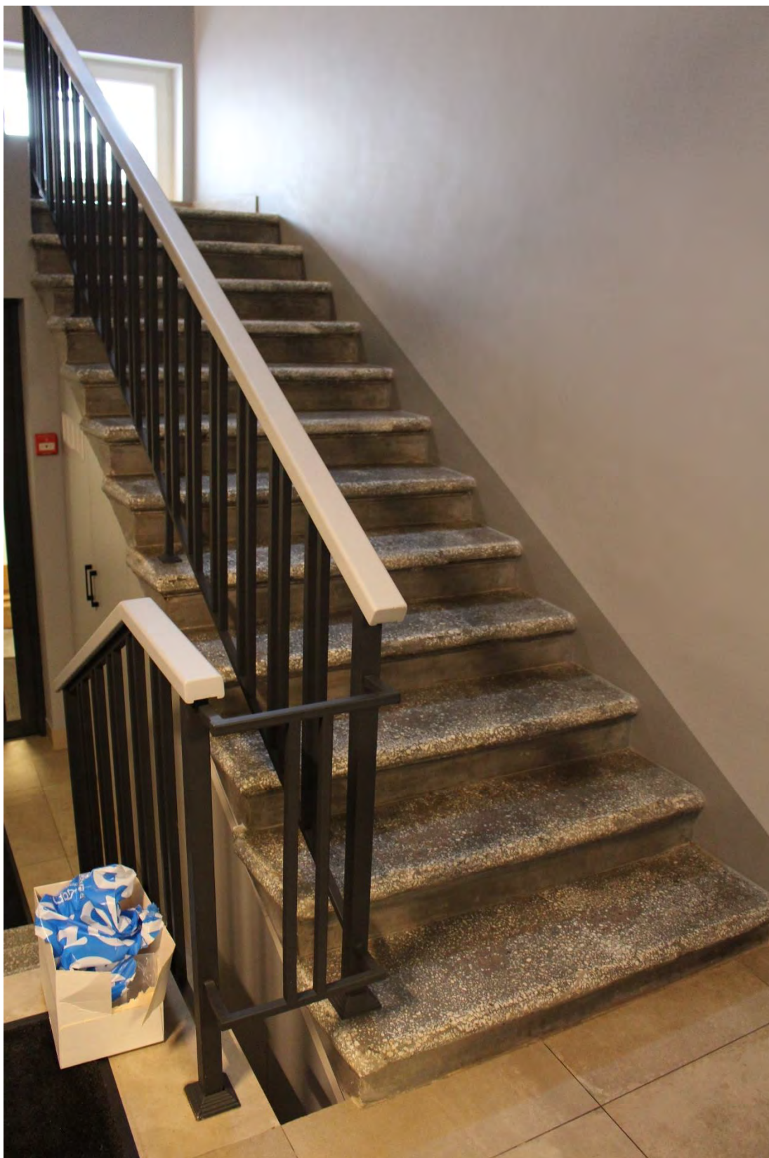
Фото 137. Северо-западная лестница выявленного объекта культурного наследия «Здание богадельни в память бракосочетания вел.кн. Ксении Александровны». Фото 19.05.2023 г.
