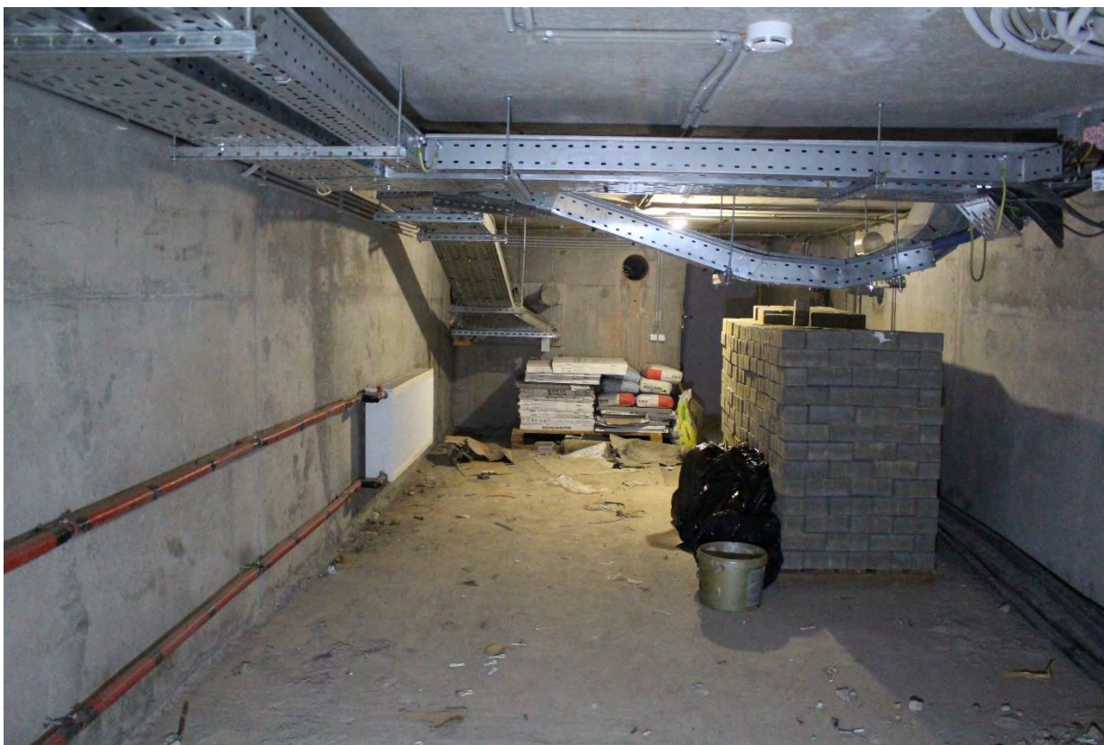
Фото 69. Подвальные помещения главного корпуса выявленного объекта культурного наследия «Главное здание градских богаделен (в 1770-х годах – здание Воспитательного дома)». Фото 19.05.2023 г.
