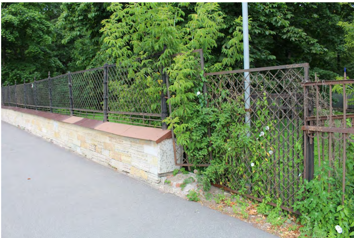
Фото 61. Вид на утраченный фрагмент ограды выявленного объекта культурного наследия «Ограда». Фото 19.05.2023 г.
