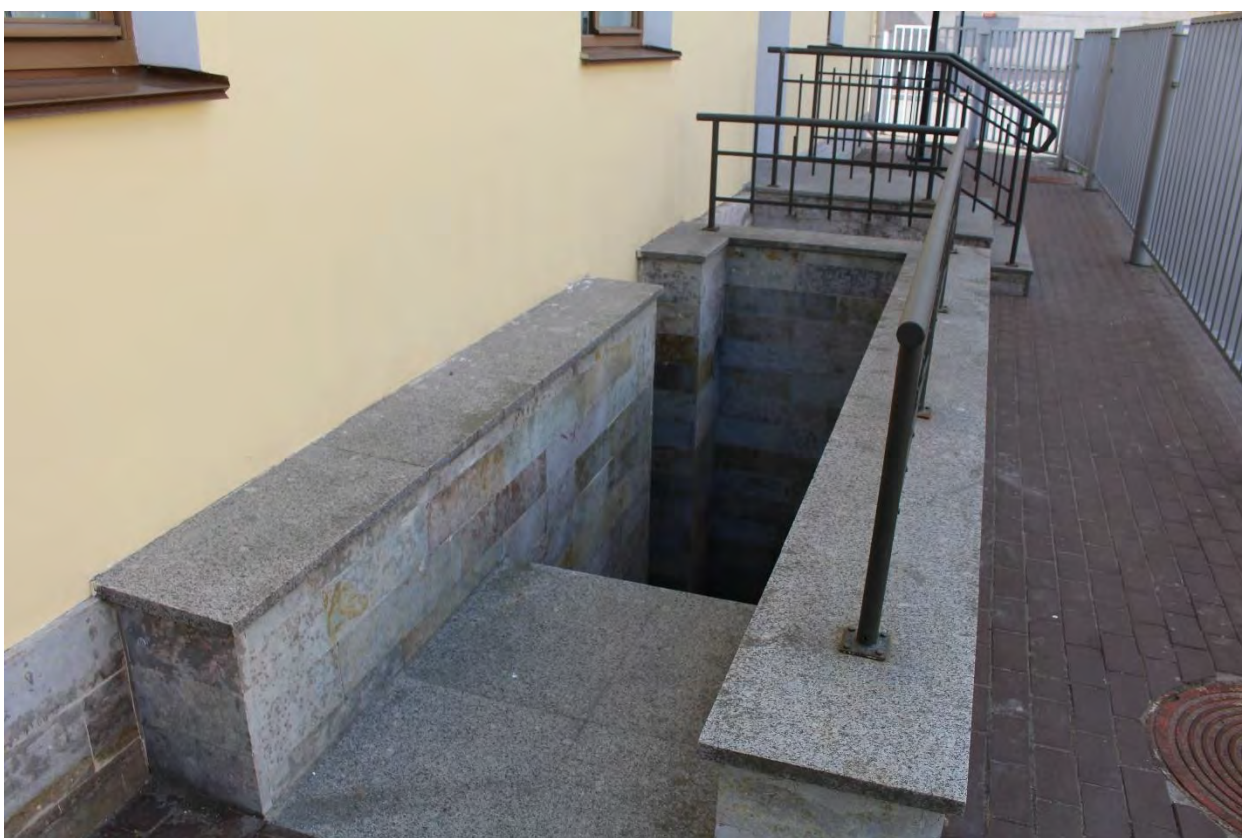
Фото 64. Вход в подвал главного корпуса выявленного объекта культурного наследия «Главное здание градских богаделен (в 1770-х годах – здание Воспитательного дома)». Фото 19.05.2023 г.
