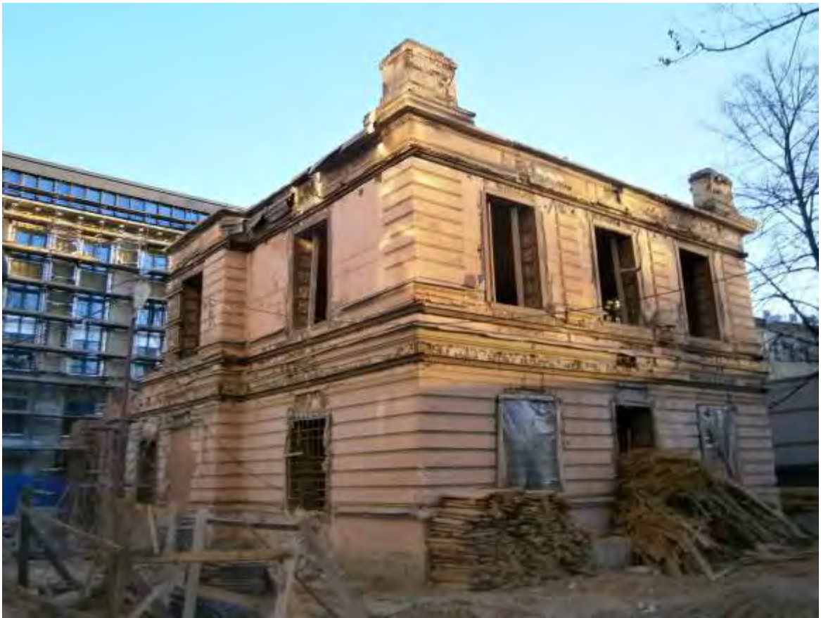
Илл. 71. Здание богадельни в память бракосочетания вел. кн. Ксении Александровны. Вид на северный и западный фасады. 2015 г. (источник: https://p1.citywalls.ru/photo_469-480513.jpg?mt=1605735863 ).
