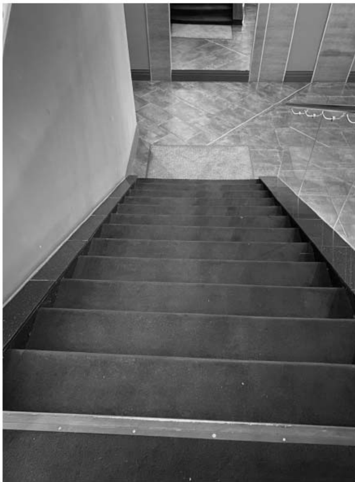
94. Общий вид лестницы Л7, расположенной в центральной части объекта культурного наследия в уровне 1-го этажа.
