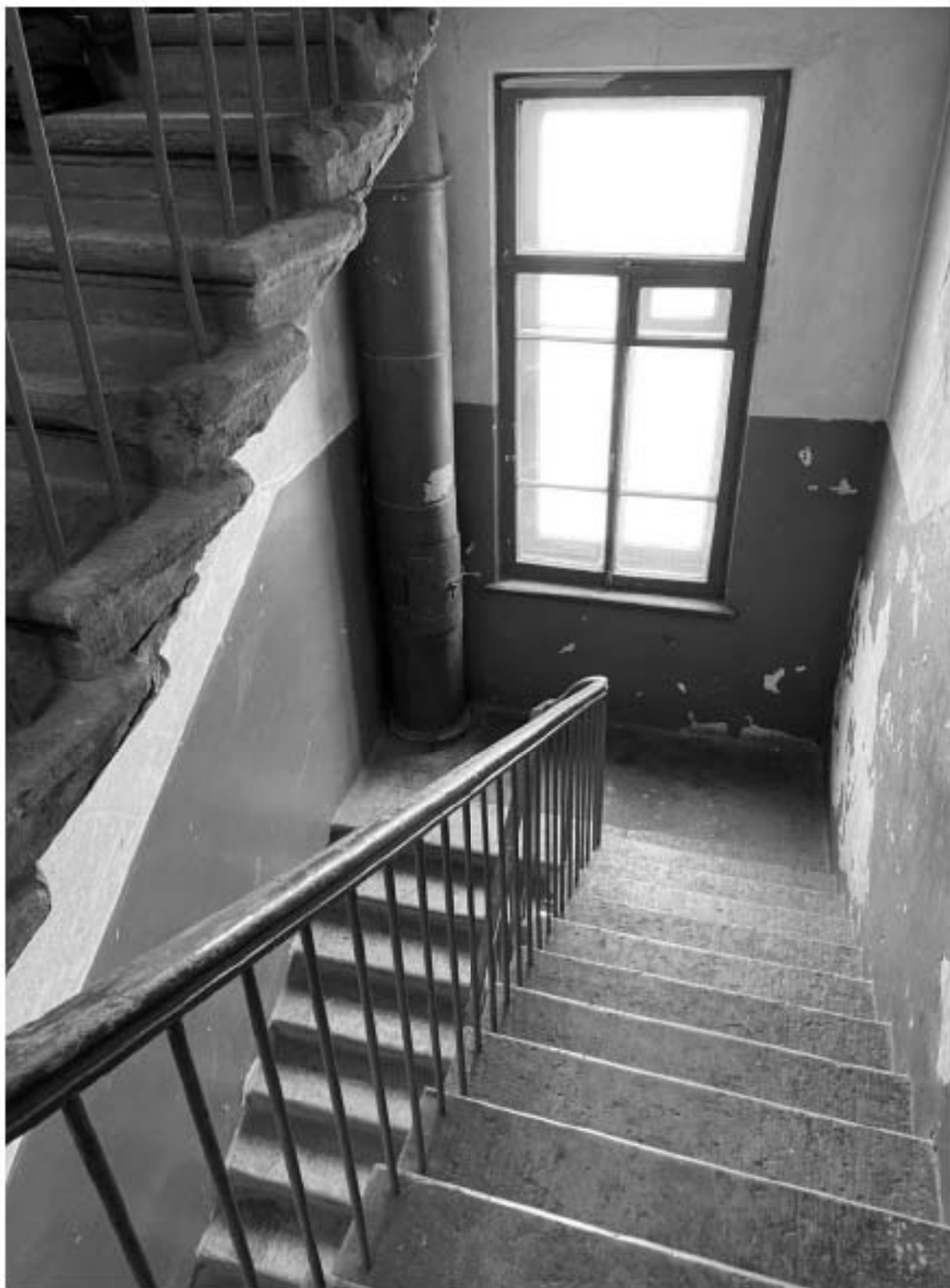
29. Вид на служебную лестницу ЛЗ объекта культурного наследия в уровне 5-го этажа.
