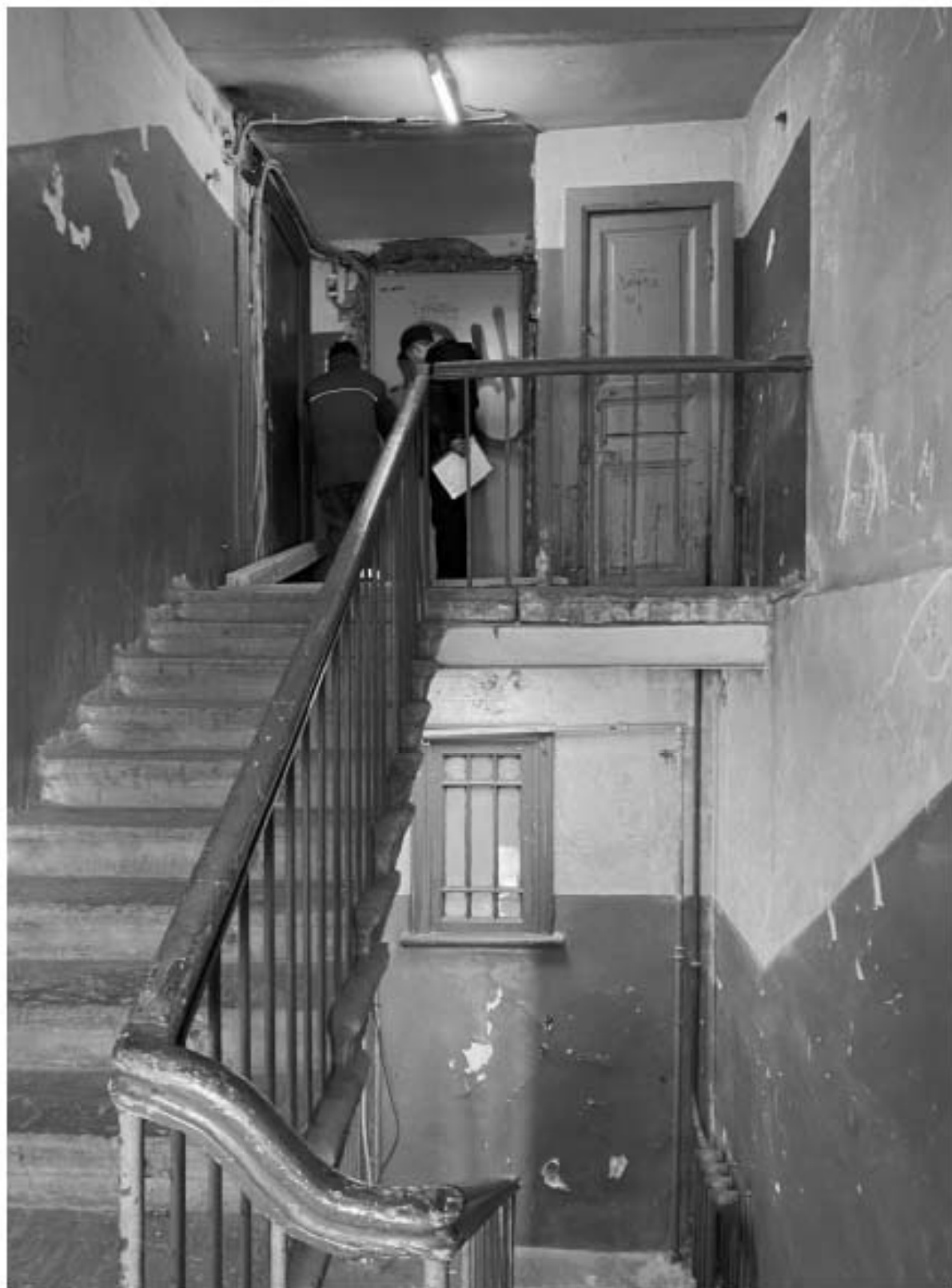
27. Вид на служебную лестницу ЛЗ объекта культурного наследия в уровне 6-го этажа.
