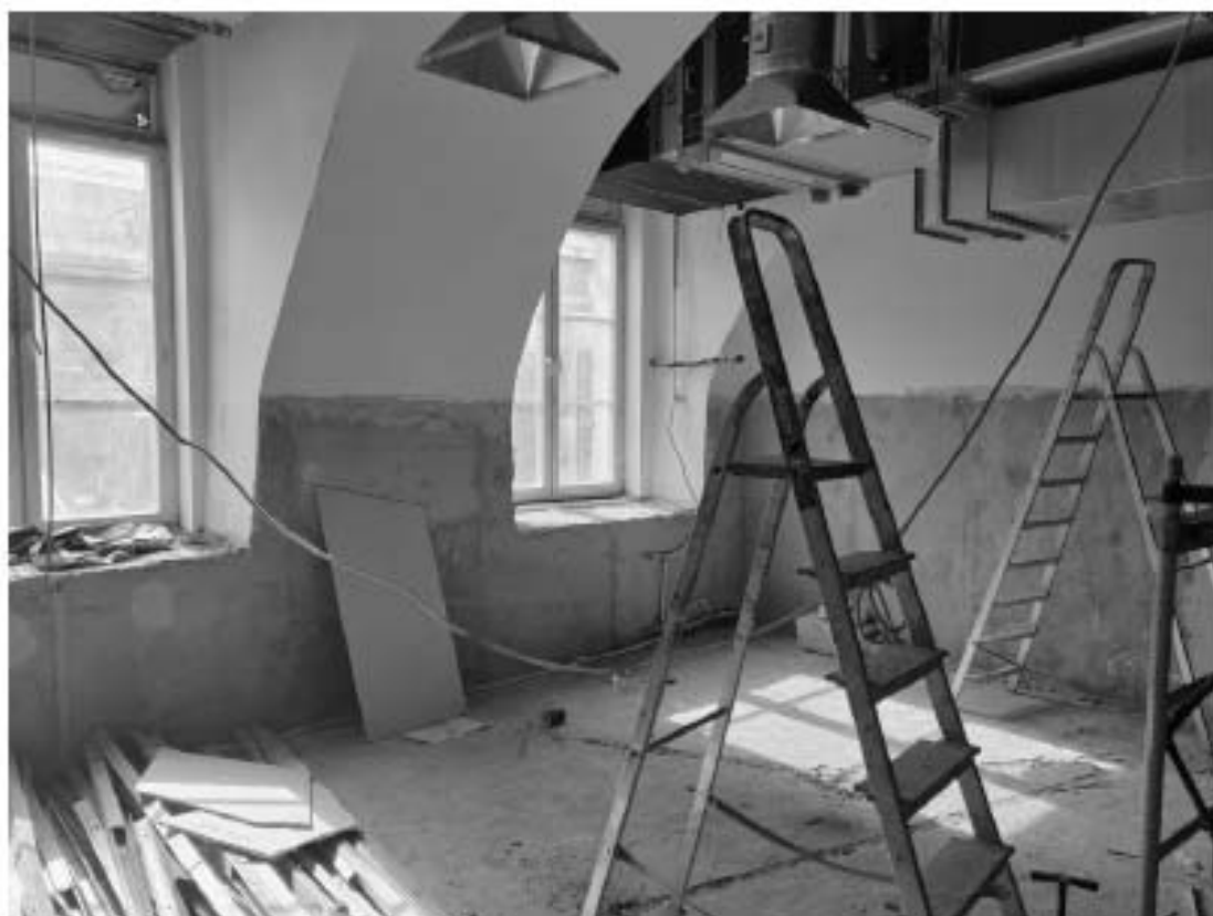
Фото 36. Интерьер пом. 6-Н и 7-Н объекта культурного наследия федерального значения «Казармы (трехэскадронный корпус)», входящего в состав объекта культурного наследия федерального значения «Манеж и казармы Конногвардейского полка»
