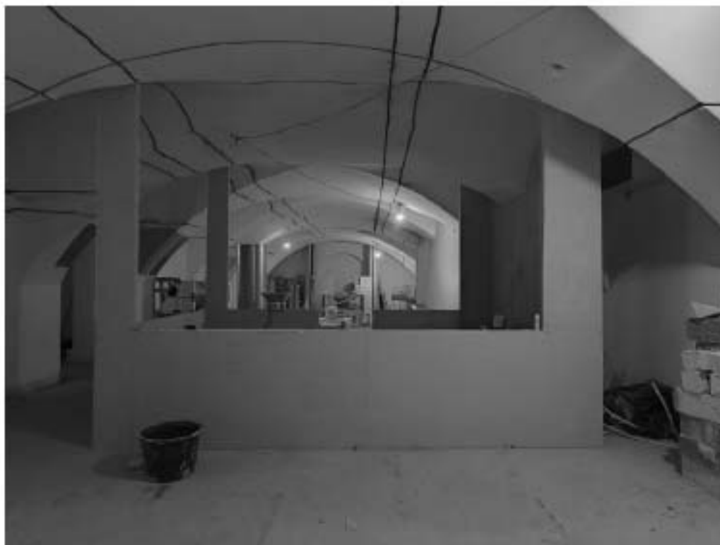
Фото 14. Интерьер пом. 6-Н и 7-Н объекта культурного наследия федерального значения «Казармы (трехэскадронный корпус)», входящего в состав объекта культурного наследия федерального значения «Манеж и казармы Конногвардейского полка»
