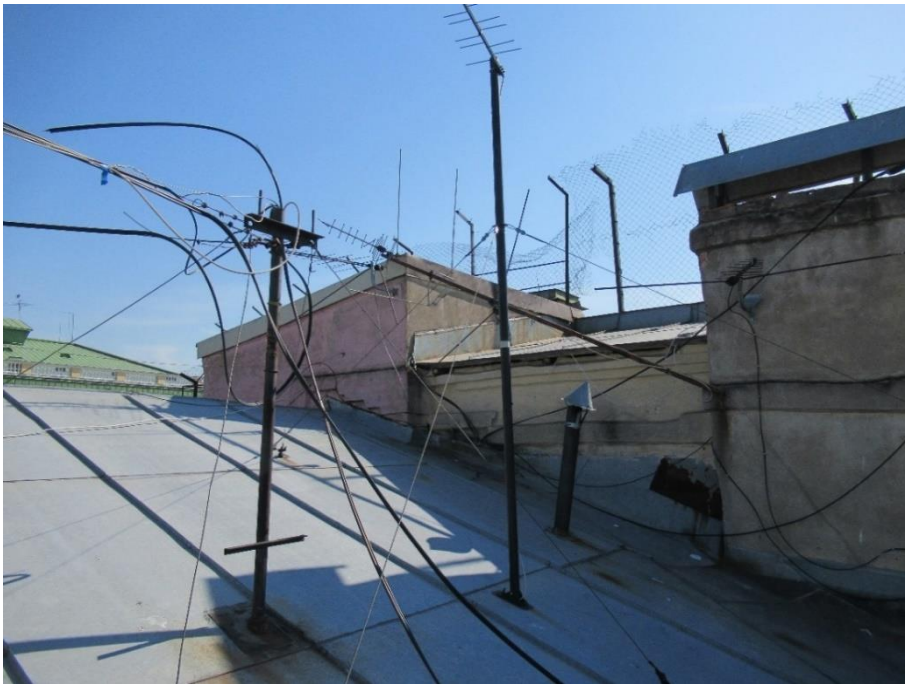
51. Объект культурного наследия регионального значения «Собственный дом архитектора Н.П. Басина», г. Санкт-Петербург, Крылова пер., 7/5, лит. А. Кровля. Фрагмент. Фото 28.08.2023г.
