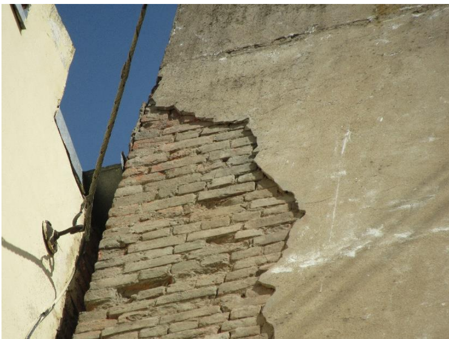
38. Объект культурного наследия регионального значения «Собственный дом архитектора Н.П. Басина», г. Санкт-Петербург, Крылова пер., 7/5, лит. А. Северный фасад. Фрагмент. Фото 28.08.2023г.
