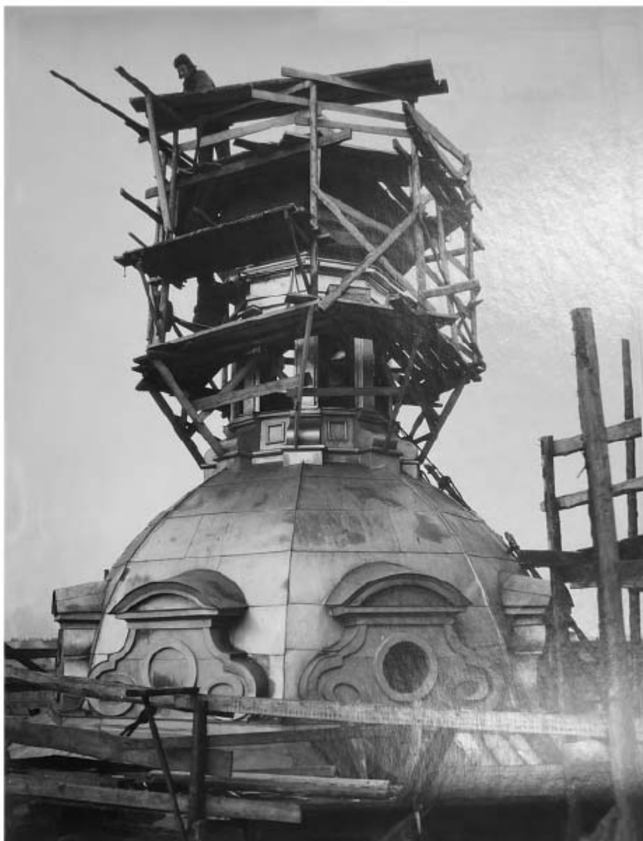
90. Предтеченская церковь. Купол северо-западный малой главы, южная сторона в процессе реставрации. (ЦГАНДТ Р-488, Оп. 324, Д. 213, Л. 5. 1952-1967 г.)
