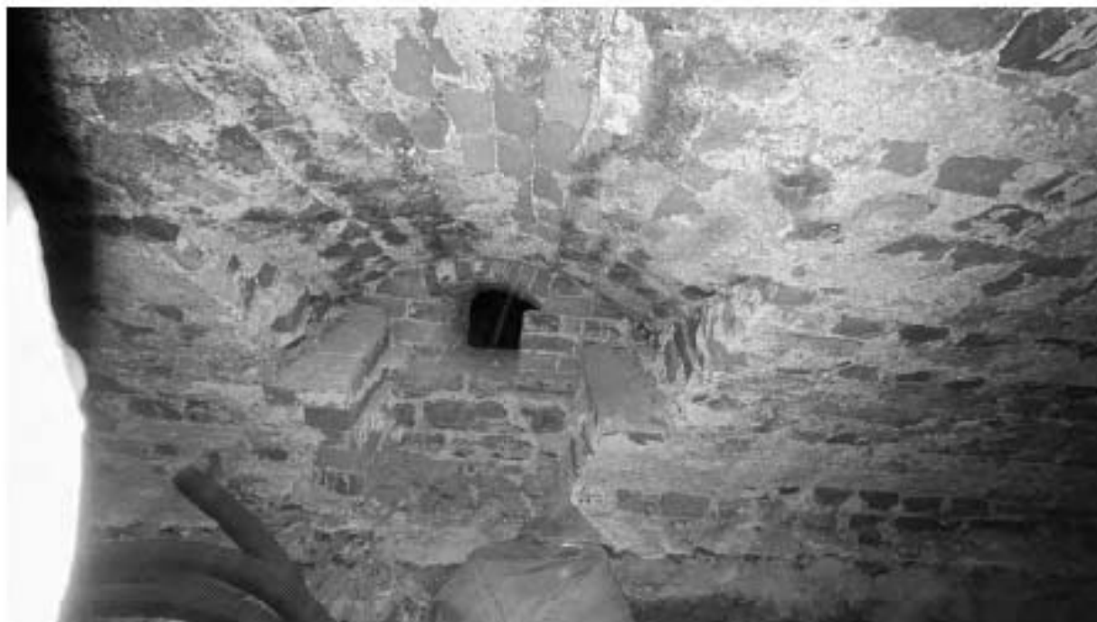
Фото 15. Подвал. Вид на исторический оконный проем. Фрагмент северо-восточного фасада. Вход в подвал.
