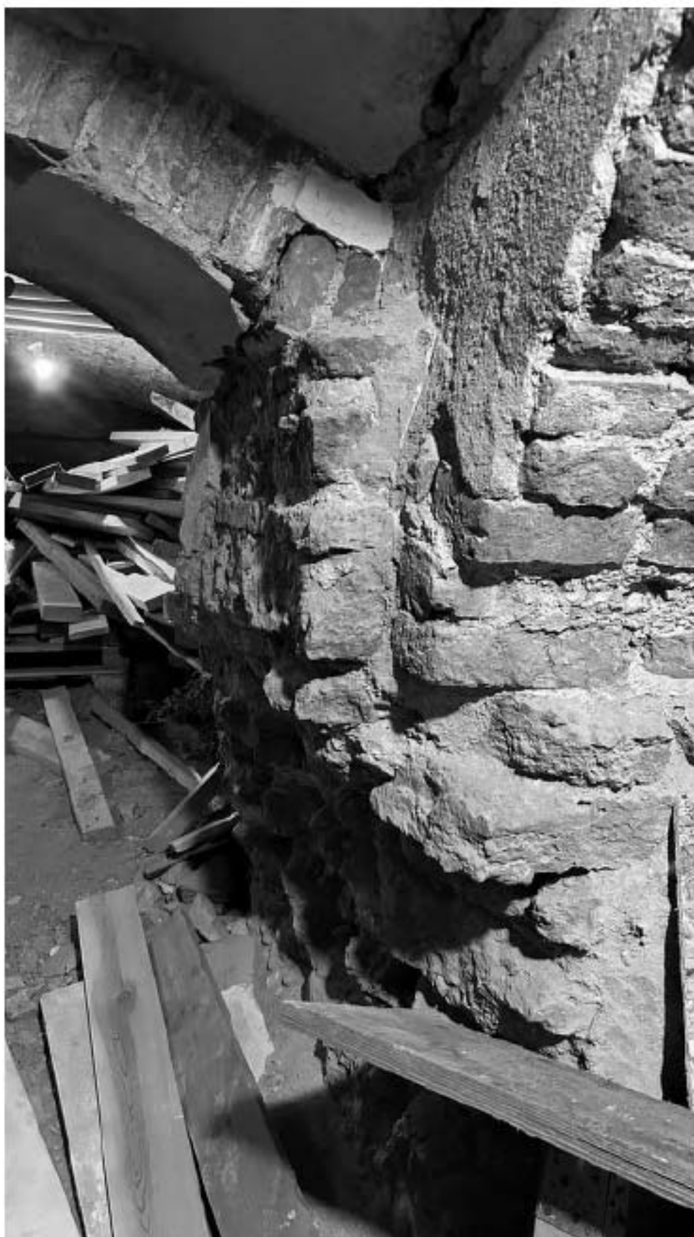
Фото 10. Подвал. Вид на разрушенный проем (дверь).
