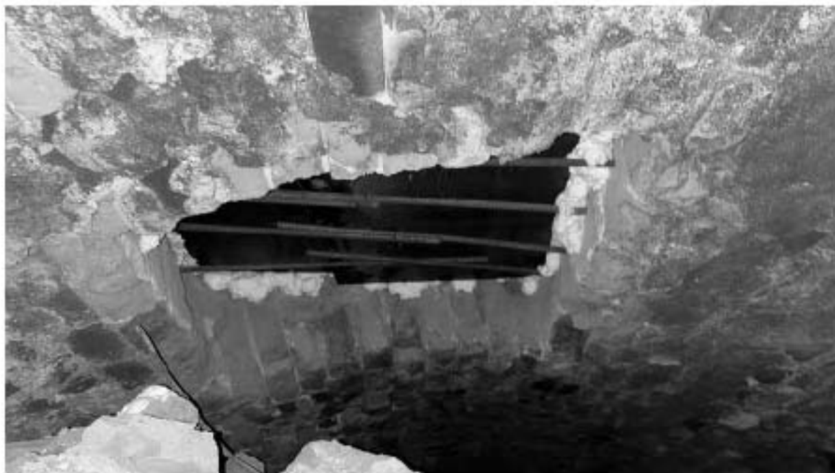
Фото 17. Подвал. Разрушение части свода в помещении западной части собора.
