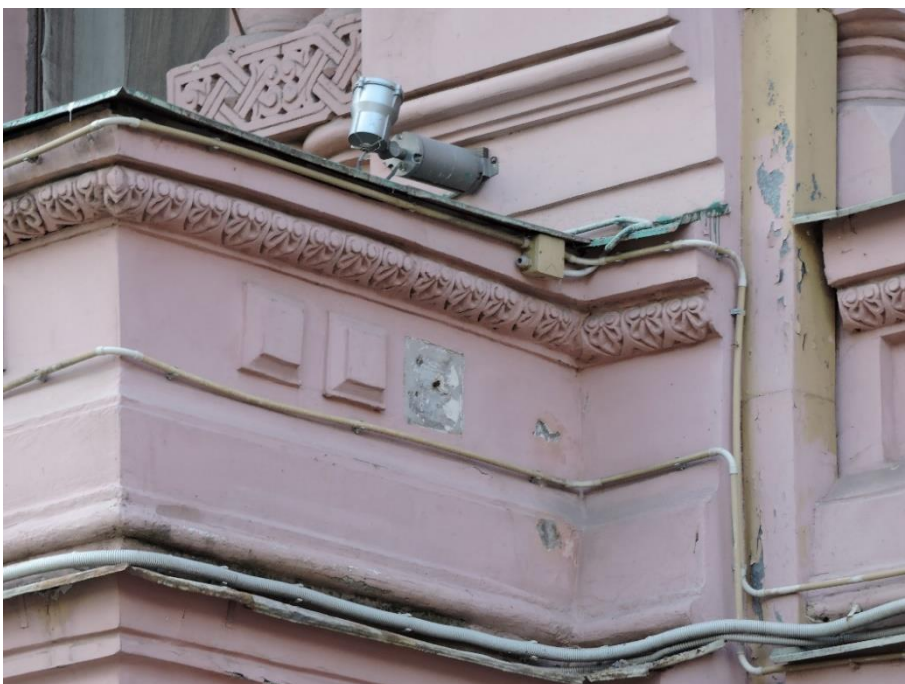
19. Объект культурного наследия регионального значения «Собственный дом архитектора Н.П. Басина», г. Санкт-Петербург, Крылова пер., 7/5, лит. А. Восточный фасад. Фрагмент. Фото 28.08.2023г.
