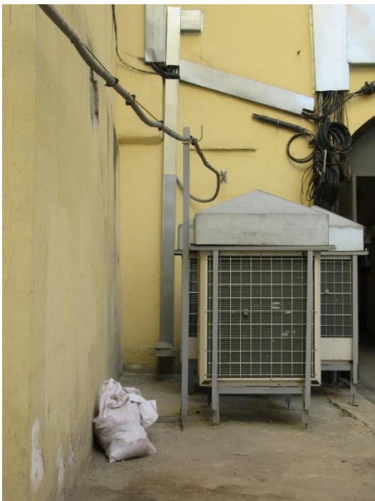
40. Объект культурного наследия регионального значения «Собственный дом архитектора Н.П. Басина», г. Санкт-Петербург, Крылова пер., 7/5, лит. А. Северный фасад. Фрагмент. Фото 28.08.2023г.
