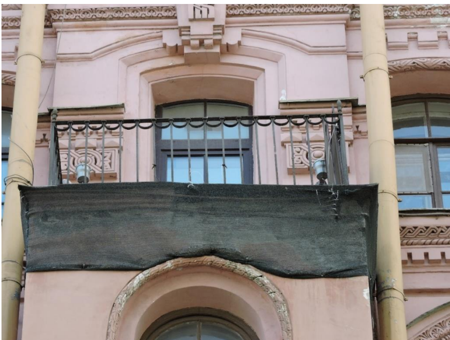
29. Объект культурного наследия регионального значения «Собственный дом архитектора Н.П. Басина», г. Санкт-Петербург, Крылова пер., 7/5, лит. А. Северный фасад. Фрагмент. Фото 28.08.2023г.
