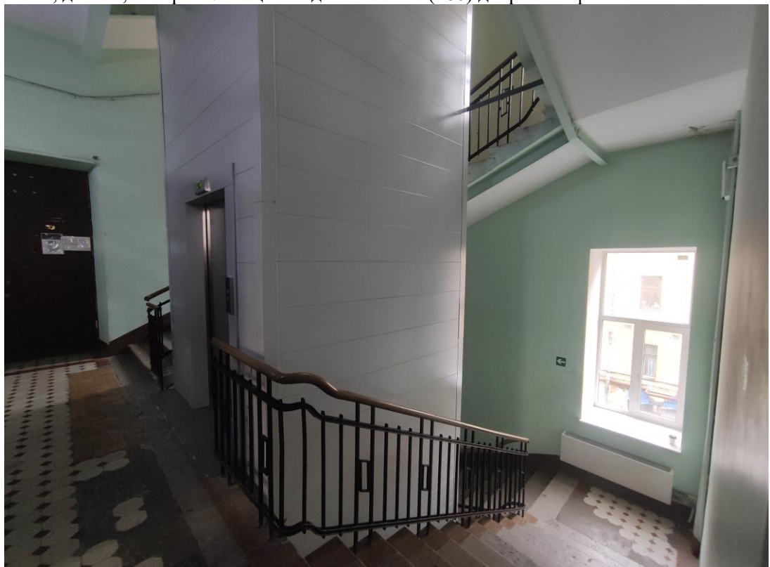
44. Объект культурного наследия регионального значения «Здание Физико-химического института Высших женских (Бестужевских) курсов», расположенный по адресу: г. Санкт-Петербург, Средний проспект В.О., дом 41, литера А. Общий вид пом. № 1-Н(275) дворового флигеля.
