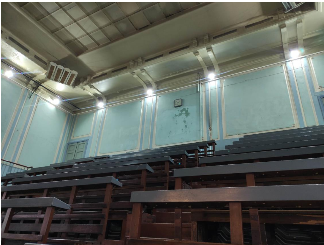
67. Объект культурного наследия регионального значения «Здание Физико-химического института Высших женских (Бестужевских) курсов», расположенный по адресу: г. Санкт-Петербург, Средний проспект В.О., дом 41, литера А. Общий вид пом. № б/н главного корпуса (северо-западная большая аудитория).
