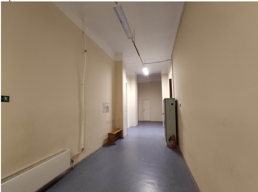
88. Объект культурного наследия регионального значения «Здание Физико-химического института Высших женских (Бестужевских) курсов», расположенный по адресу: г. Санкт-Петербург, Средний проспект В.О., дом 41, литера А. Общий вид пом. № 1-Н(359) флигеля, расположенного вдоль Среднего проспекта В.О.
