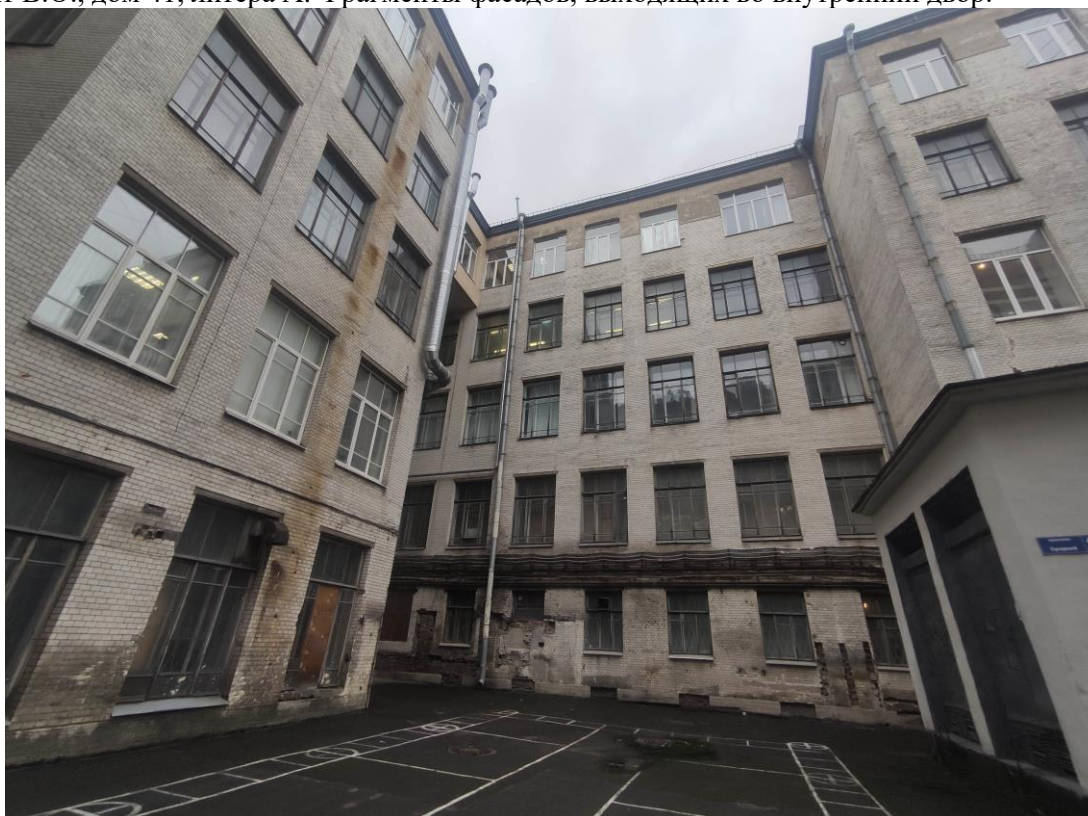
8. Объект культурного наследия регионального значения «Здание Физико-химического института Высших женских (Бестужевских) курсов», расположенный по адресу: г. Санкт-Петербург, Средний проспект В.О., дом 41, литера А. Фрагменты фасадов, выходящих во внутренний двор.
