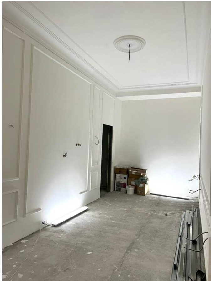
30. Выявленный объект культурного наследия «Дом А.Д.и Н.К.Чижовых». Интерьер парадной лестницы (вход с ул. Чайковского). Квартира №37. Помещение 3
