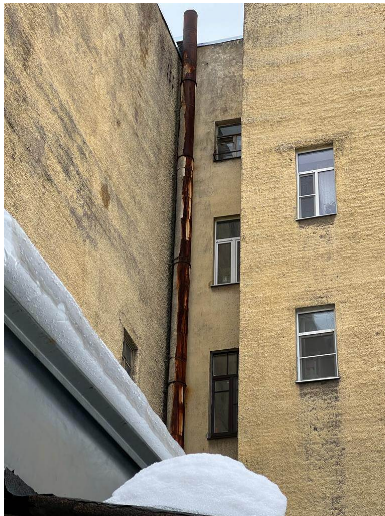
10. Выявленный объект культурного наследия «Дом А.Д.и Н.К.Чижовых». Фрагмент фасада, выходящего на соседний участок. Окно квартиры №37.
