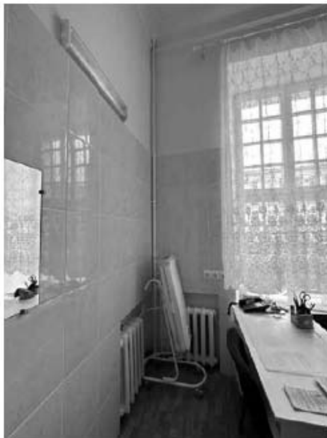
Фото 29. Мед.кабинет (1 этаж) – разводка системы отопления (Пом. 035)
