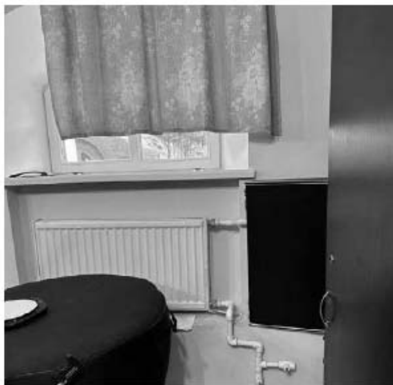
Фото 21. Помещение цокольного этажа – разводка системы отопления (Пом. 026)
