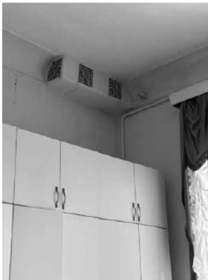
Фото 16. Вентиляционная шахта в большом зале (1-ый этаж) (Пом. 037)
