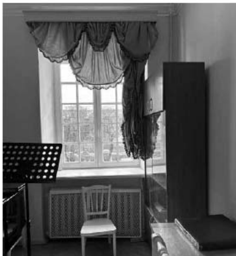
Фото 23. Класс 2-ого этажа – разводка системы отопления (Пом. 17)
