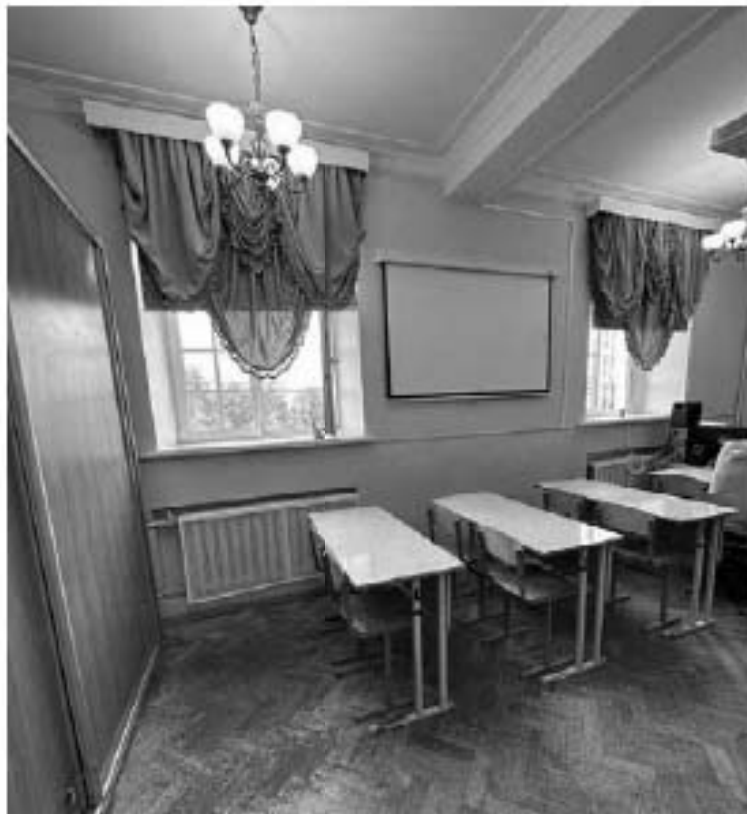
Фото 28. Класс 2-его этажа – разводка системы отопления (Пом. 12)
