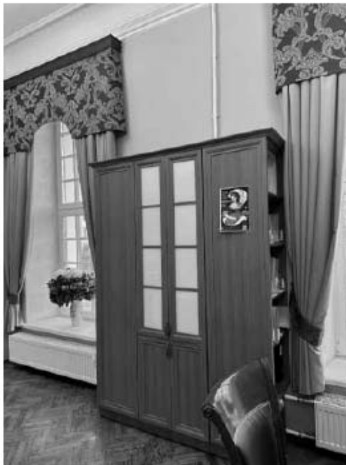
Фото 22. Канцелярия – система отопления (1 этаж) (Пом. 031)
