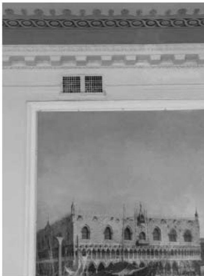
Фото 17. Вентиляционная решетка в большом зале (1-ый этаж) (Пом. 037)
