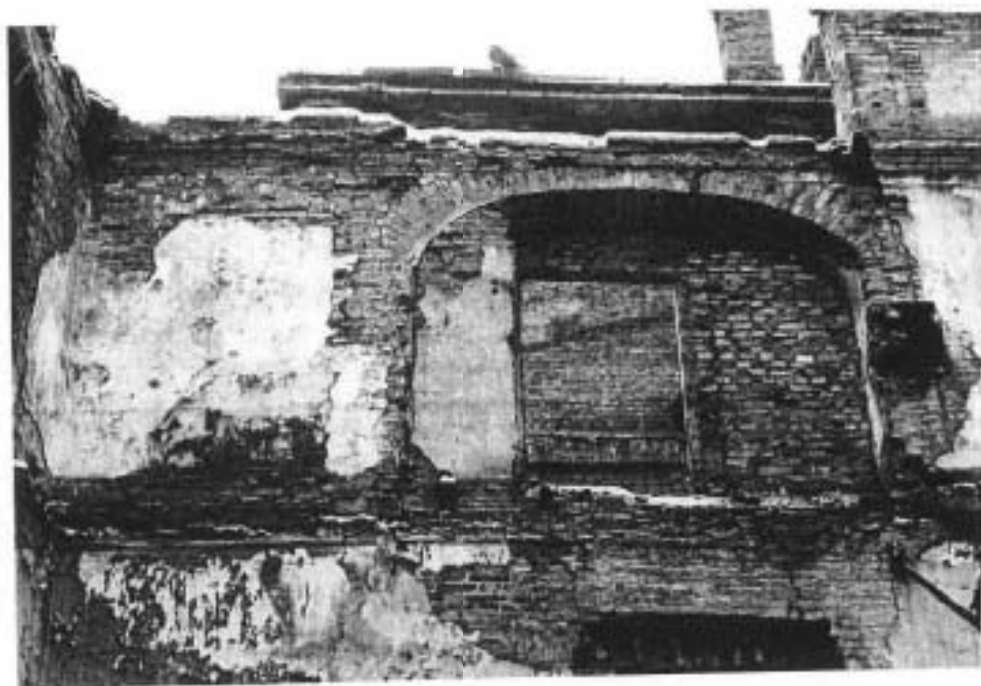
Илл. 19 1949 г. Заложенное окно в наружной стене. Фото А.Н. Петрова из Исторической справки по зданию Кикиных палат
