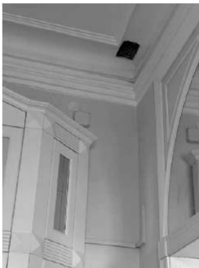
Фото 15. Вентиляционная решетка в холле 1-ого этажа (Пом. 030)
