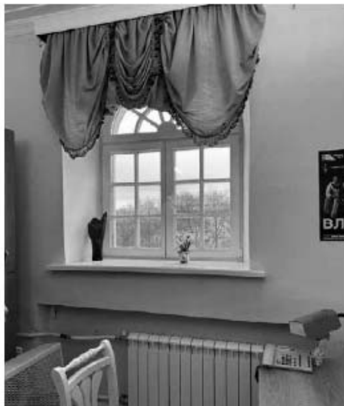
Фото 27. Класс 3-его этажа – разводка системы отопления (Пом. 29)
