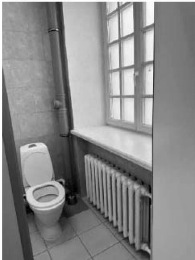
Фото 30. Туалет 2-ого этажа – разводка системы отопления (Пом. 056)
