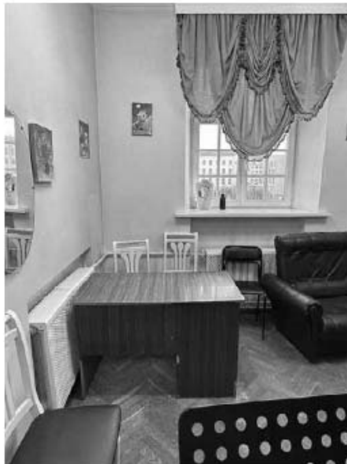
Фото 26. Класс 3-его этажа – разводка системы отопления (Пом. 31)
