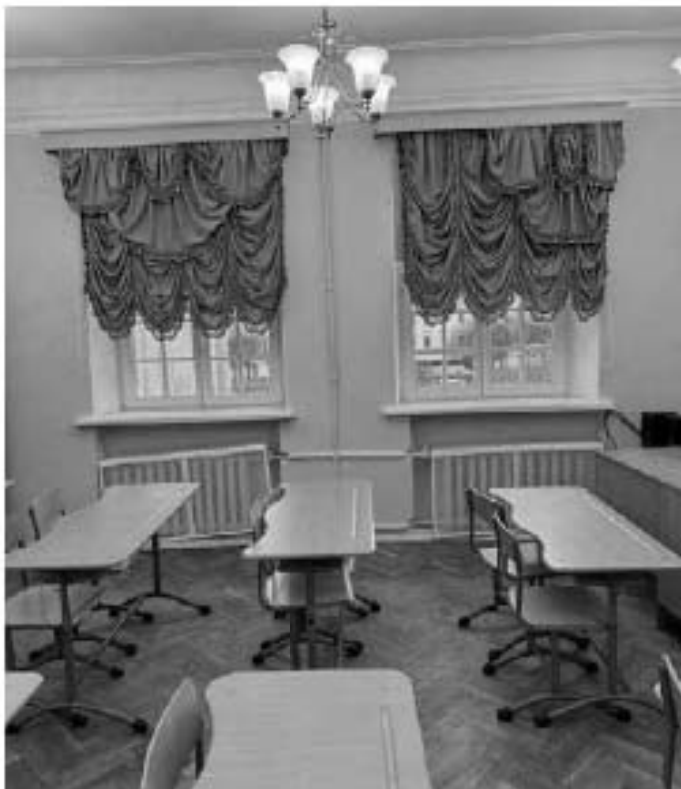
Фото 25. Класс 2-ого этажа – разводка системы отопления (Пом. 22)
