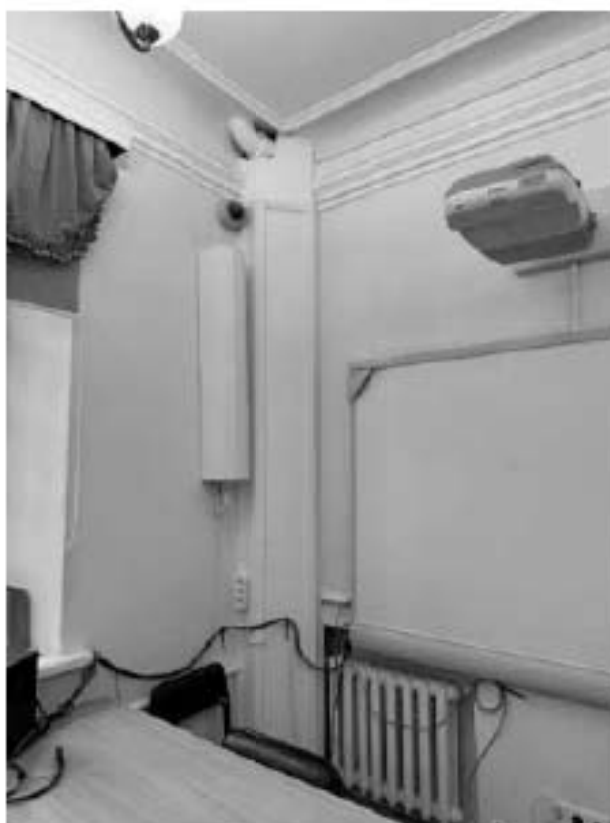
Фото 18. Класс 2-ого этажа – разводка системы отопления (Пом. 20)
