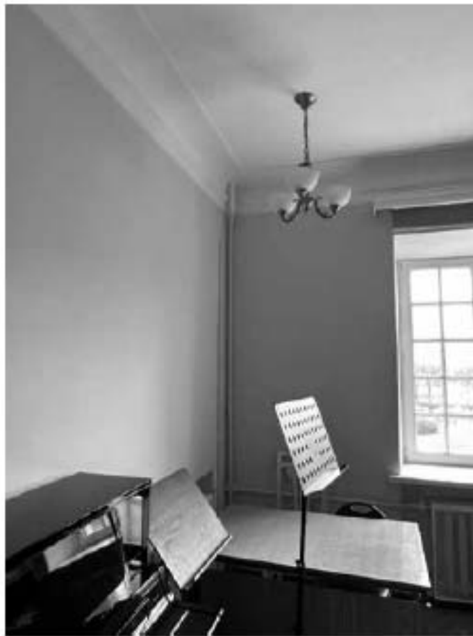
Фото 24. Класс 2-ого этажа – разводка системы отопления (Пом. 18)
