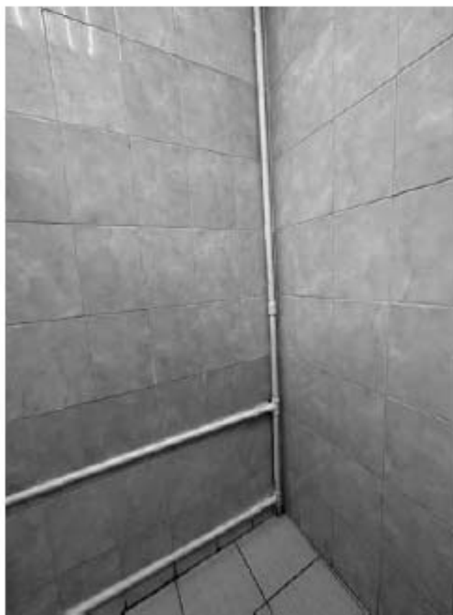
Фото 31. Туалет 2-ого этажа – разводка системы отопления (Пом. 059)
