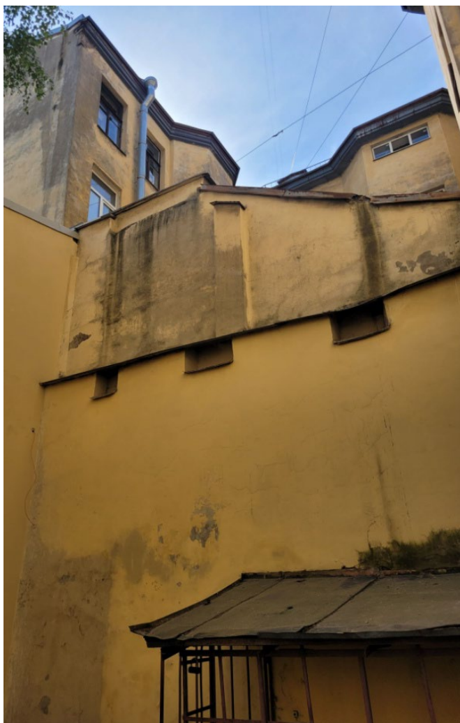
11. ОКНРЗ «Комплекс построек Главного управления государственного коннозаводства и Санкт-Петербургской аукционной конюшни», расположенный по адресу: Санкт-Петербург, улица Маяковского, дом 15, литера А. Брандмауэр, к которому примыкала утраченная часть Аукционной конюшни. Дата съемки: 28.04.2023г.
