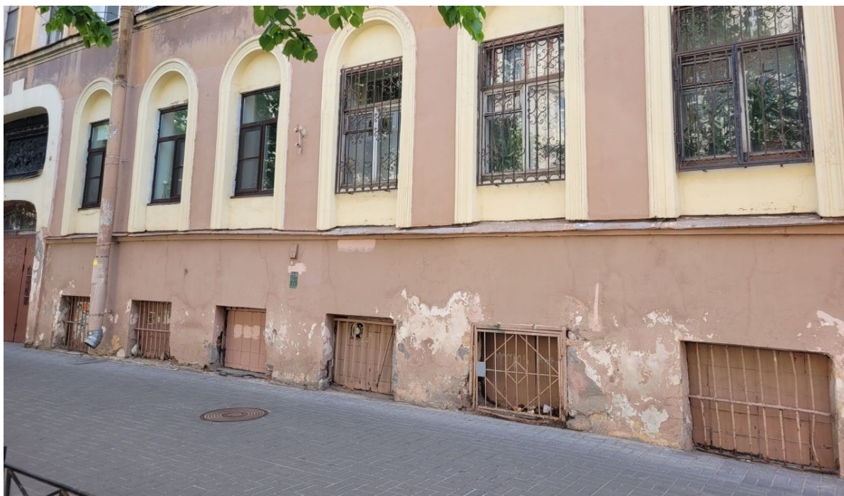
3. ОКНРЗ «Комплекс построек Главного управления государственного коннозаводства и Санкт-Петербургской аукционной конюшни», расположенный по адресу: Санкт-Петербург, улица Маяковского, дом 15, литера А. Архитектурно-художественное решение фасадов: профилированные полуциркульные наличники первого этажа с упором на междуэтажный карниз. Дата съемки: 28.04.2023г.
