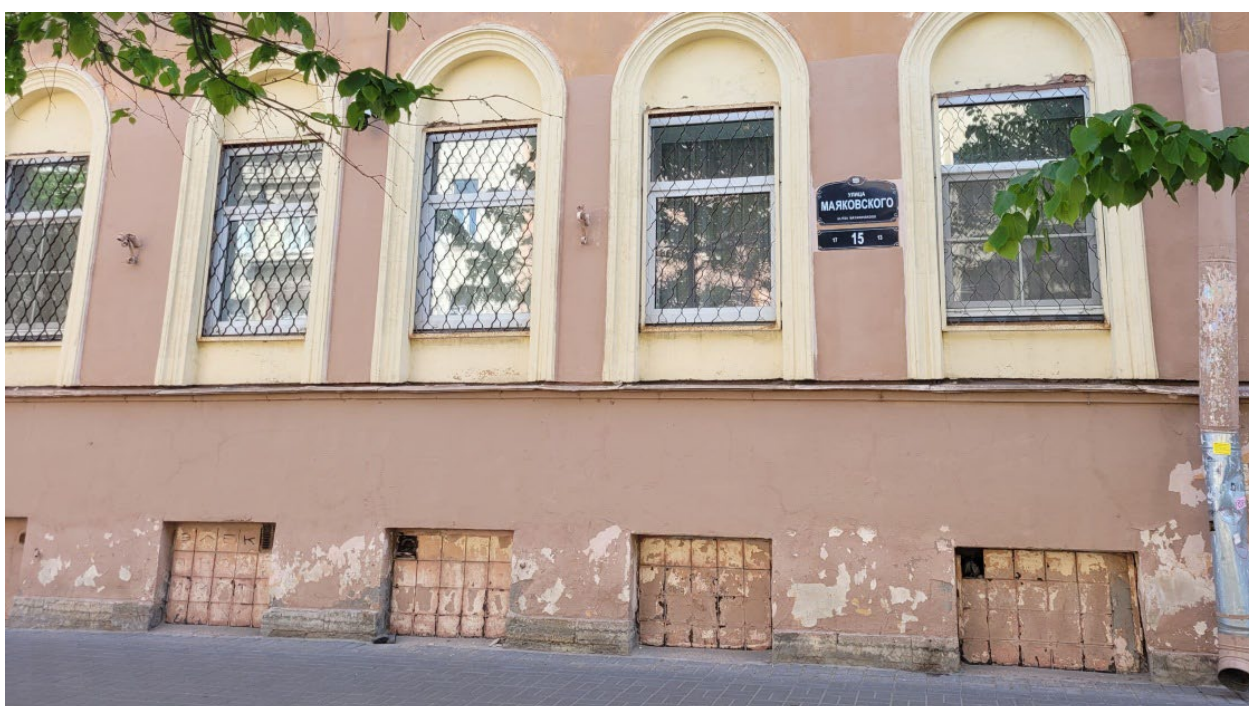
2. ОКНРЗ «Комплекс построек Главного управления государственного коннозаводства и Санкт-Петербургской аукционной конюшни», расположенный по адресу: Санкт-Петербург, улица Маяковского, дом 15, литера А. Архитектурно-художественное решение фасадов: материал и характер отделки – гладкая штукатурка; конфигурация исторических оконных проемов. Дата съемки: 28.04.2023г.
