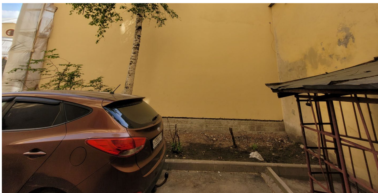
12. ОКНРЗ «Комплекс построек Главного управления государственного коннозаводства и Санкт-Петербургской аукционной конюшни», расположенный по адресу: Санкт-Петербург, улица Маяковского, дом 15, литера А. Аукционные конюшни. Цоколь. Дата съемки: 28.04.2023г.
