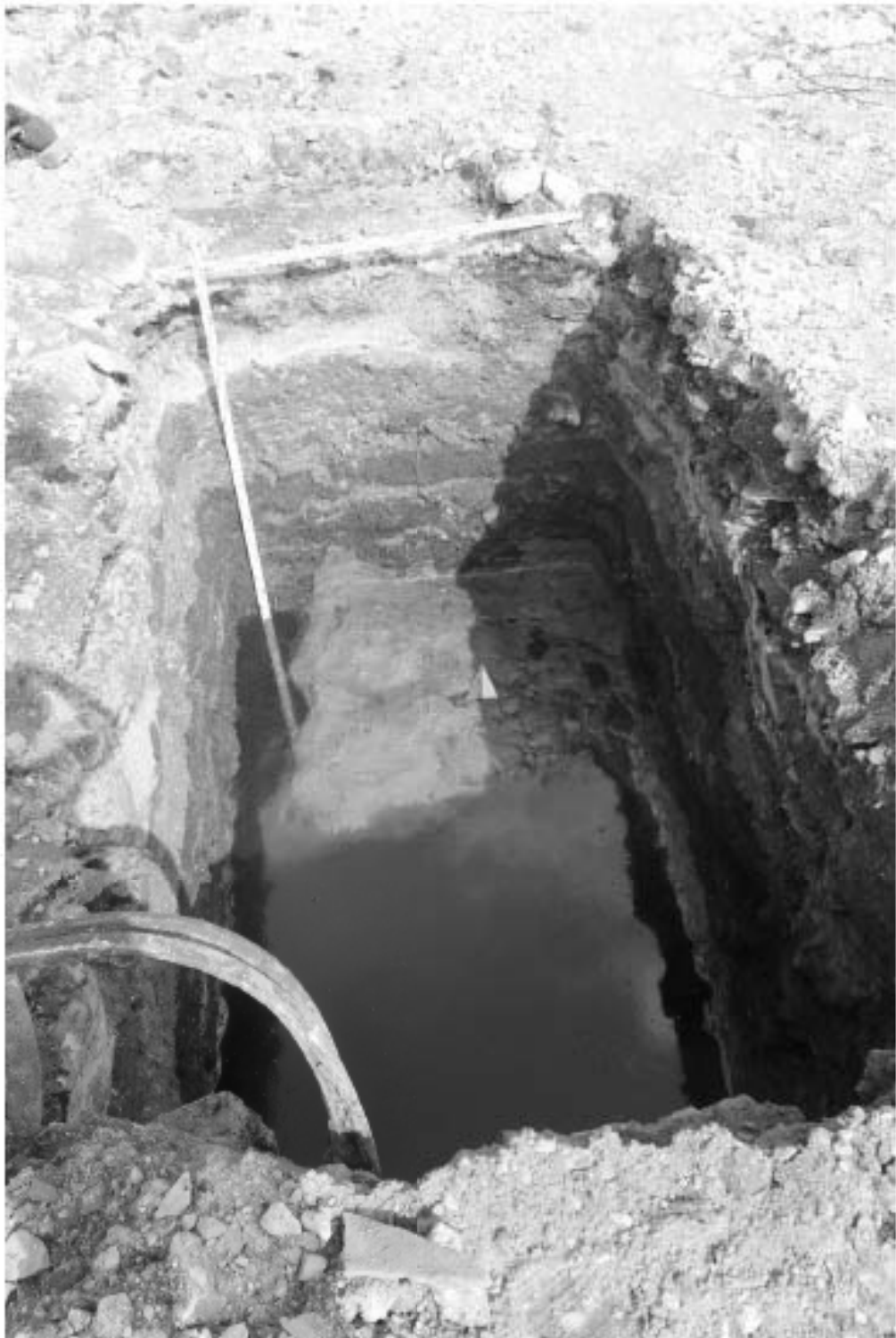
Рис. 76. СПб-2023. Кожевенная л., д. 39, к. 5 (КН78:06:0002114:21). Шурф 3-4, фиксация по уровню окончания работ, вид на север.
