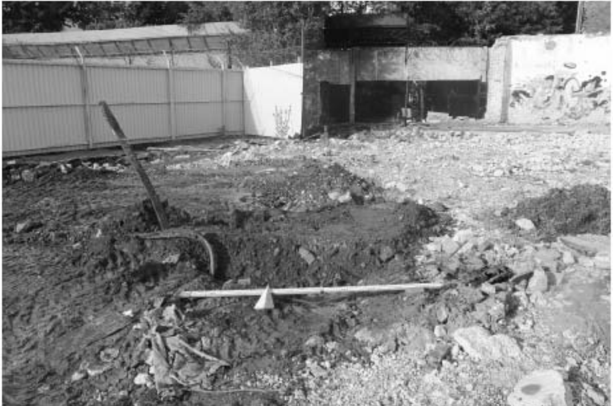
Рис. 83. СПб-2023. Кожевнная л., д. 39, к. 5 (КН78:06:0002114:21). Шурф 3-4 после рекультивации, вид на север.
