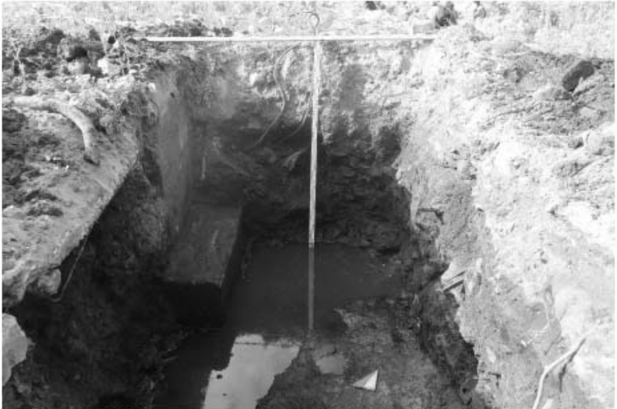
Рис. 102. СПб-2023. Кожевниная л., д. 39, к. 5 (КН78:06:0002114:21). Шурф 7-8, фиксация по уровню окончания работ, северная стенка.
