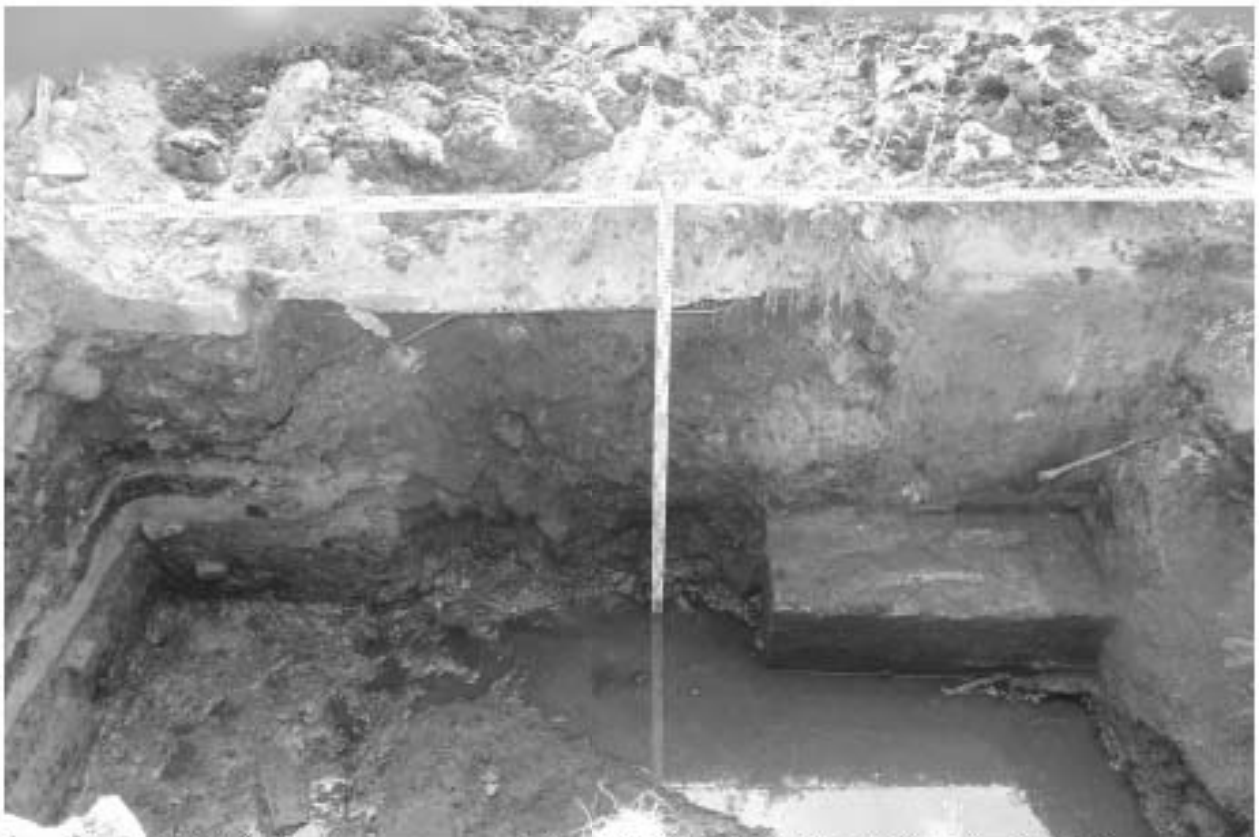
Рис. 100. СПб-2023. Кожевенная л., д. 39, к. 5 (КН78:06:0002114:21). Шурф 7-8, фиксация по уровню окончания работ, вид на запад, западная стенка.
