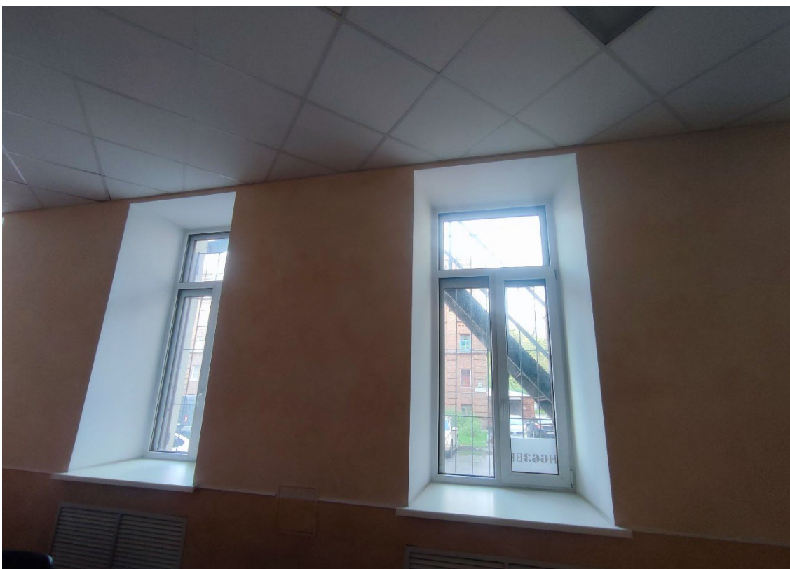
22. Выявленный объект культурного наследия «Здание института», расположенный по адресу: г. Санкт-Петербург, Большой Сампсониевский проспект, дом 86, литера А, в составе выявленного объекта культурного наследия «Санкт-Петербургский учительский институт им. императора Александра II». Фрагмент пом. 1-Н (56) в уровне 1-го этажа, в месте установки проектируемой видеокамеры (ВК7).
