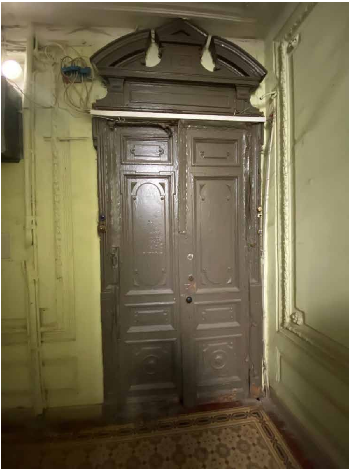
26. Общий вид дверного заполнения в части лестницы 1ЛК в уровне 2-го этажа
