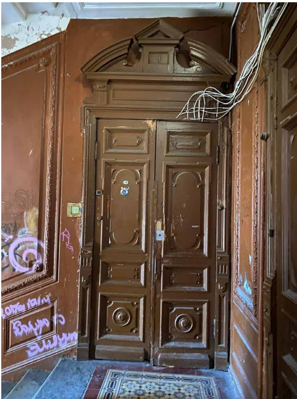
30. Общий вид дверного заполнения в части лестницы 1ЛК в уровне 3-го этажа
