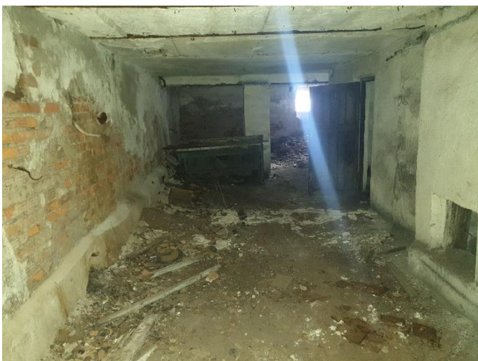
13. «Финская усадьба Заеца», Санкт-Петербург, город Зеленогорск, Приморское шоссе, дом 597, литера К. Подвал. Общий вид. Фото 27.02.2023г.
