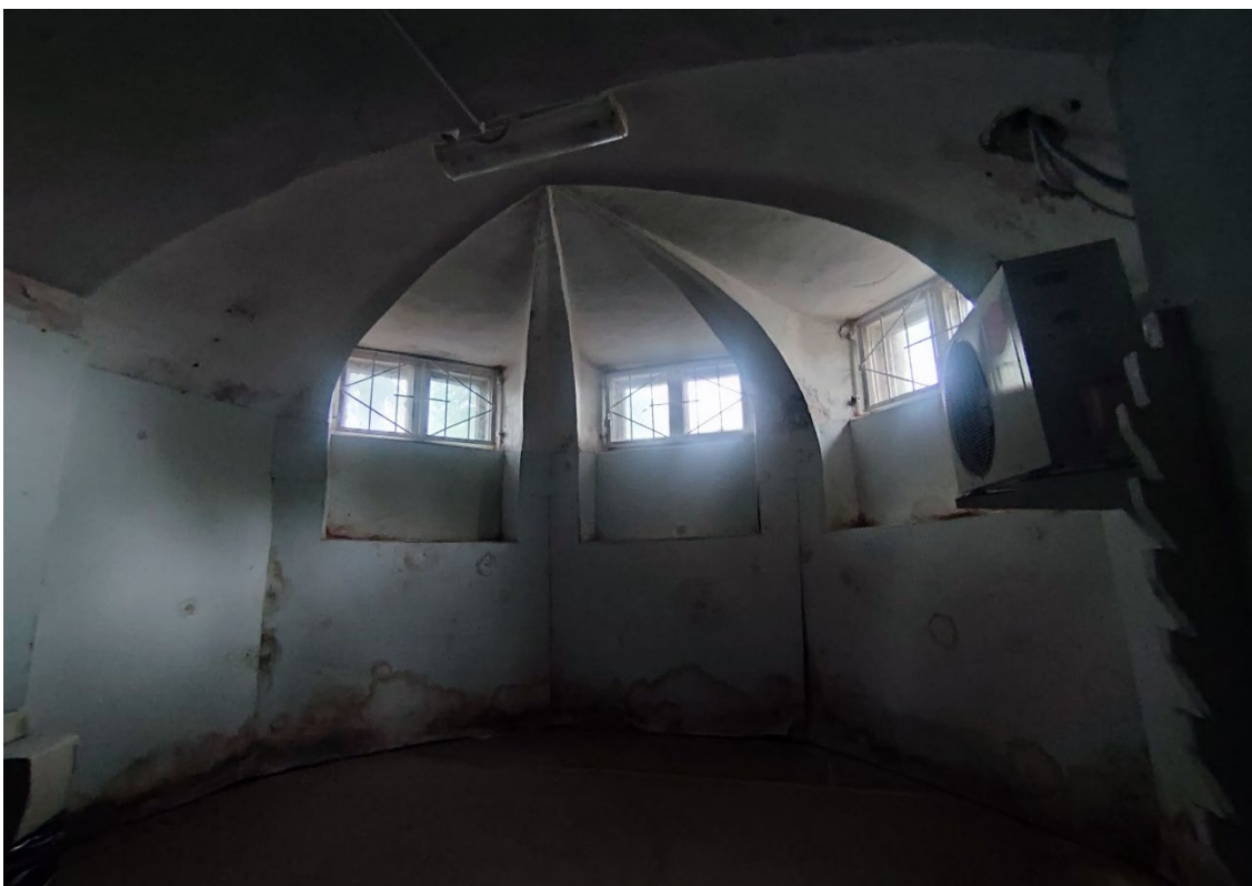
12. Объект культурного наследия регионального значения «Дом А. Гейрота», расположенный по адресу: Санкт-Петербург, город Петергоф, улица Бородачёва, дом 12, литера А, входящий в состав объекта культурного наследия регионального значения «Дом А. Гейрота с беседкой, садом и оградой». Фрагмент пом. 1-Н (43) в уровне подвала.
