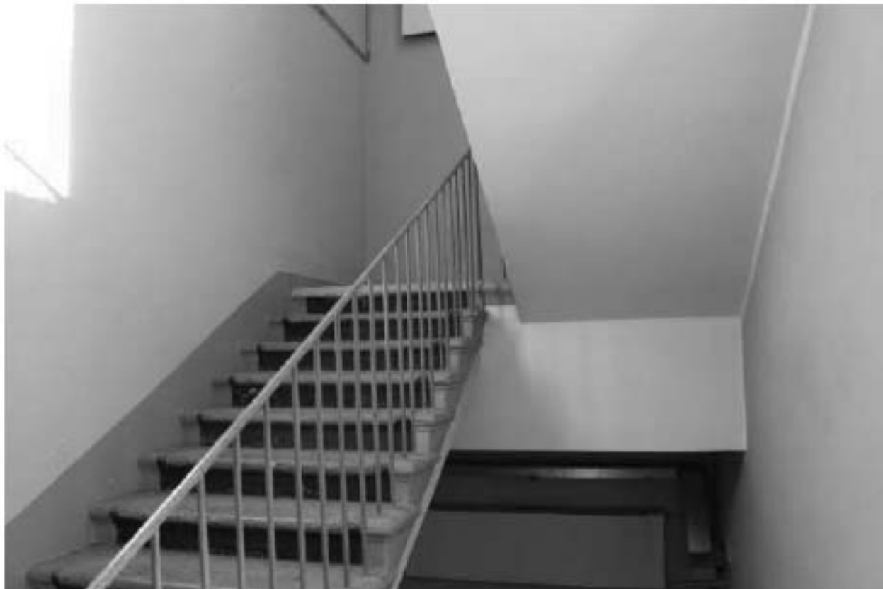
Фото 60. Выявленный объект культурного наследия «Кухонный корпус с переходной галереей». 5ЛК. Вид на лестницу в уровне 1-го – 2-го этажей. Фото 12.05.2023 г.
