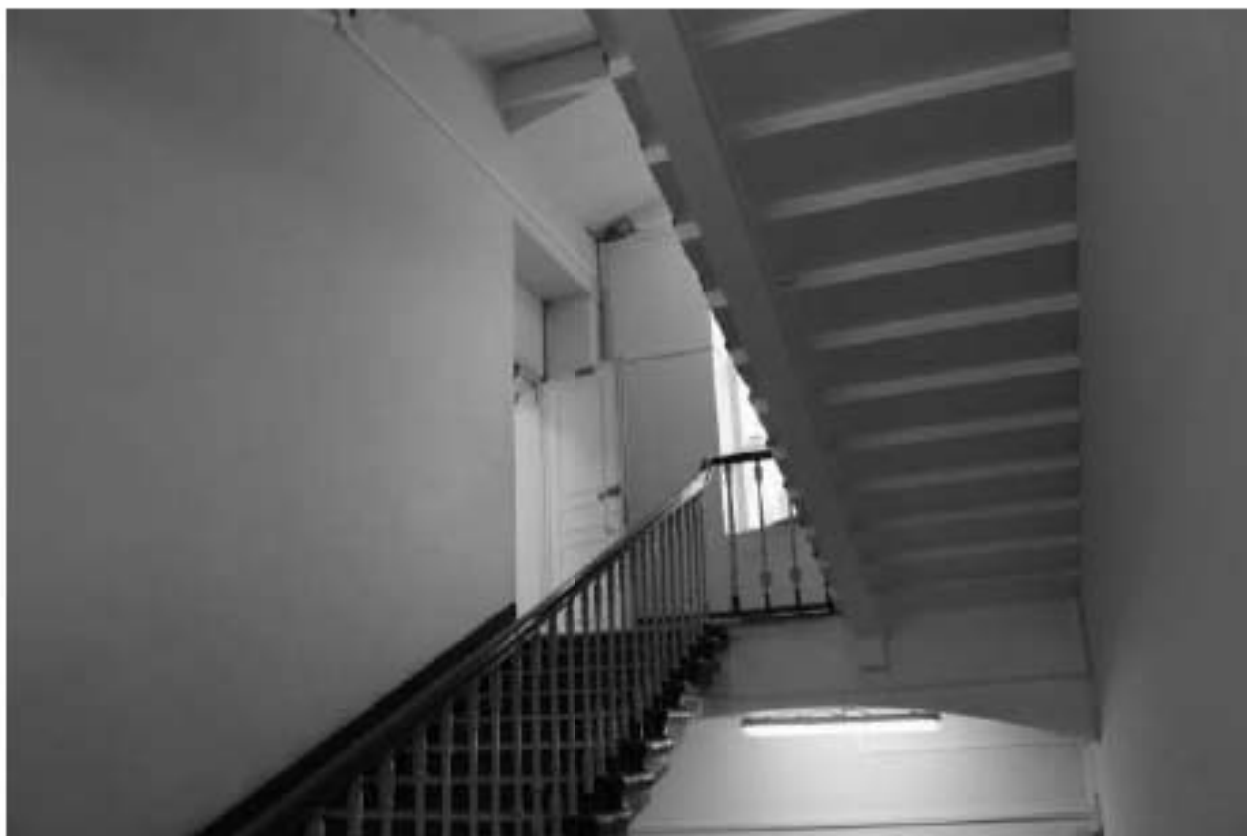
Фото 54. Выявленный объект культурного наследия «Кухонный корпус с переходной галереей». 2ЛК. Вид на лестничную площадку в уровне 2-го этажа. Фото 12.05.2023 г.
