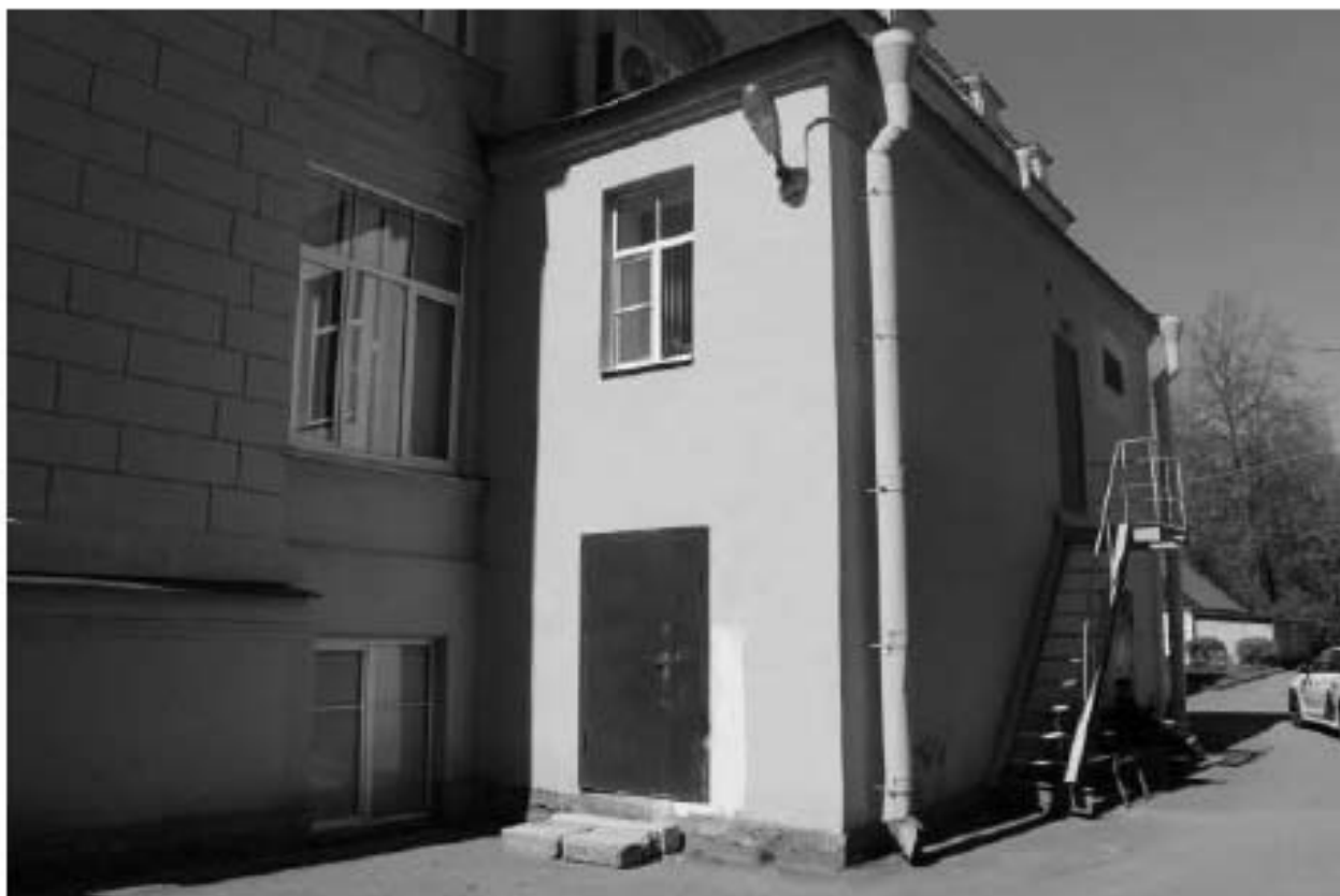
Фото 159. Вид на восточный фасад выявленного объекта культурного наследия «Патологоанатомический павильон». Фото 12.05.2023 г.
