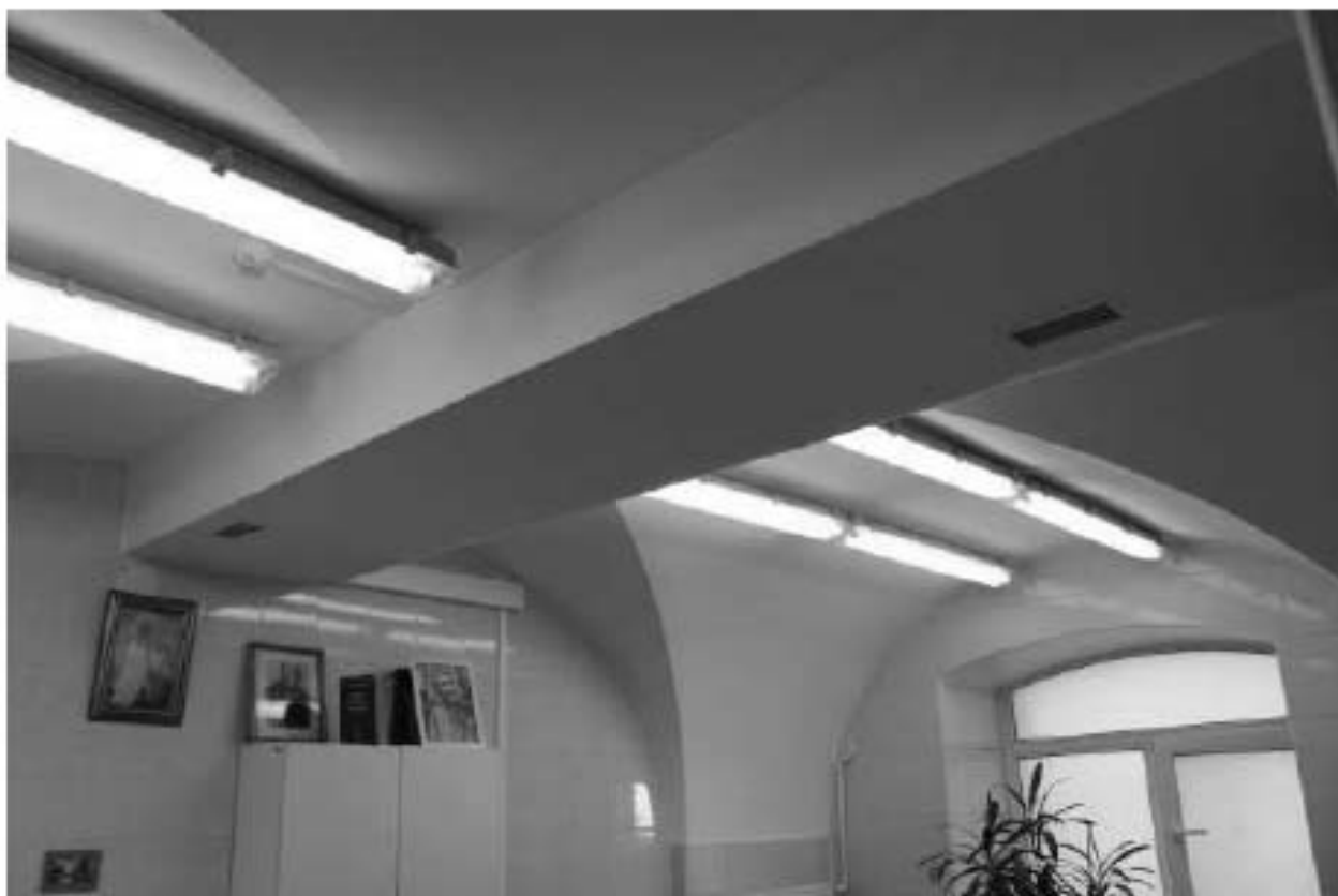
Фото 163. Выявленный объект культурного наследия «Патологоанатомический павильон». Внутренние помещения цокольного этажа. Фото 12.05.2023 г.
