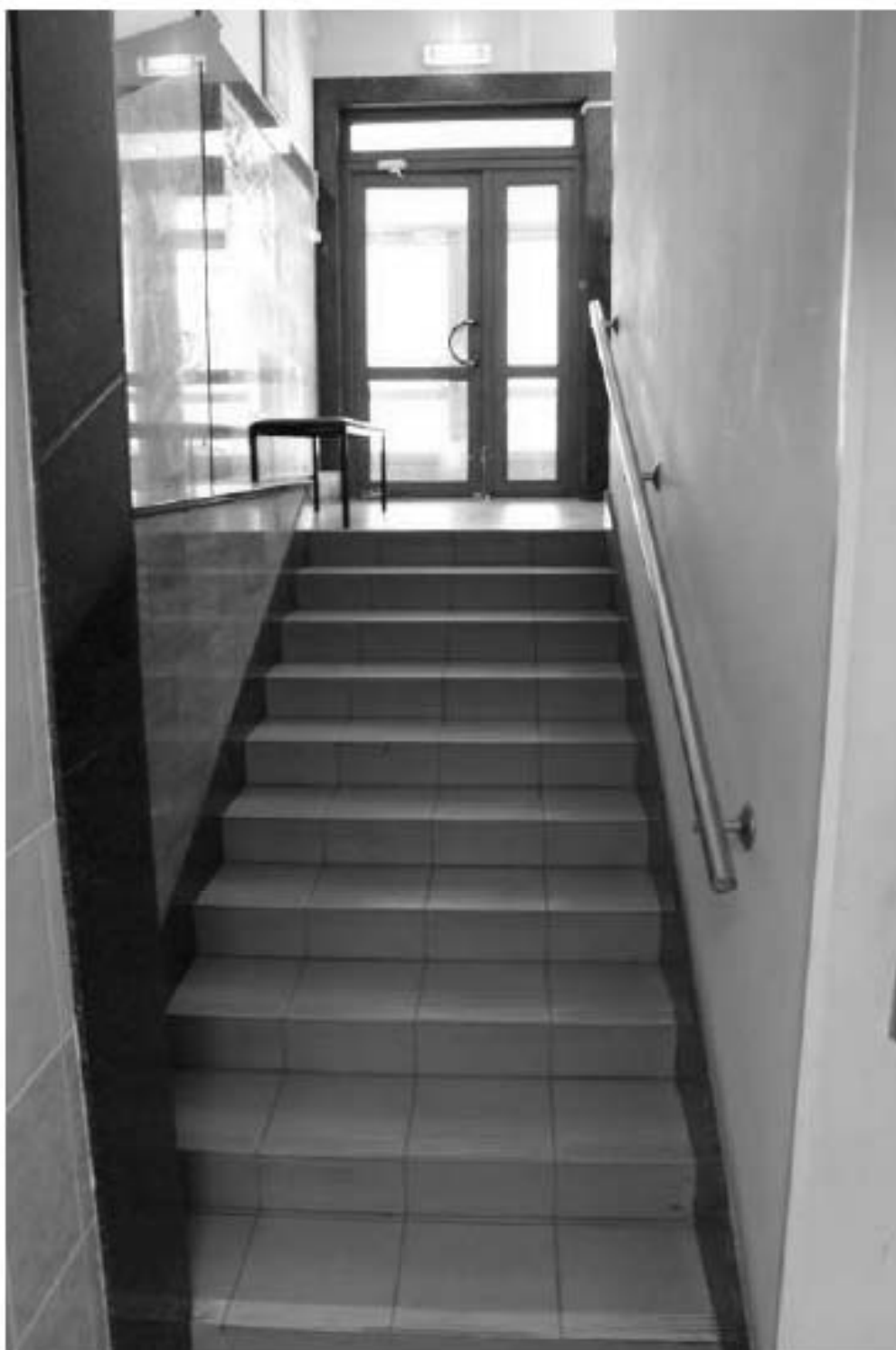
Фото 97. Выявленный объект культурного наследия «Павильон-приют им. Н.И. Жуковской с переходной галереей». ЗЛК. Вид на лестницу в уровне 1-го этажа. Фото 12.05.2023 г.
