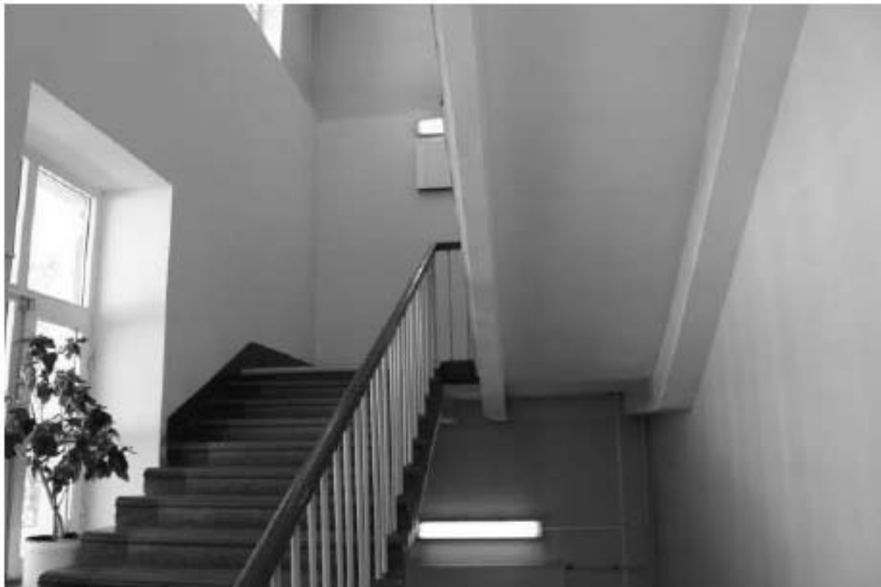
Фото 55. Выявленный объект культурного наследия «Кухонный корпус с переходной галереей». 2ЛК. Вид на лестничную площадку в уровне 3-го – 4-го этажей. Фото 12.05.2023 г.
