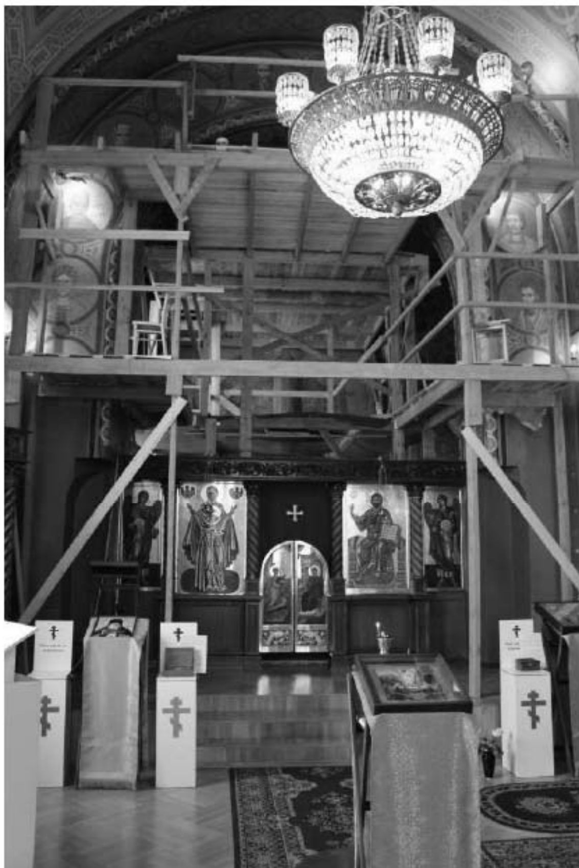
Фото 29. Выявленный объект культурного наследия «Главное здание». Внутренние помещения 2-го этажа. Фото 12.05.2023 г.
