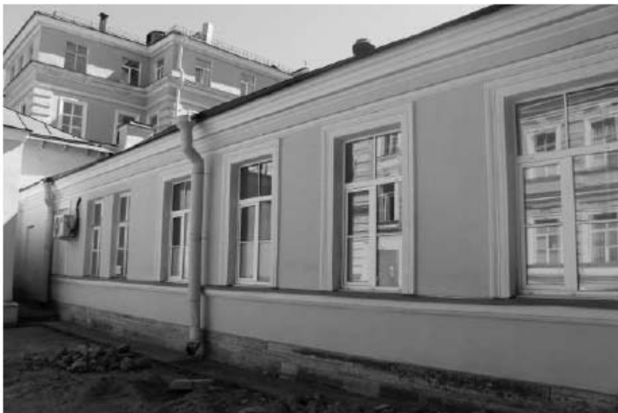
Фото 81. Вид на северный фасад переходной галереи выявленного объекта культурного наследия «Павильон гинекологических и глазных болезней с переходной галереей». Фото 12.05.2023 г.
