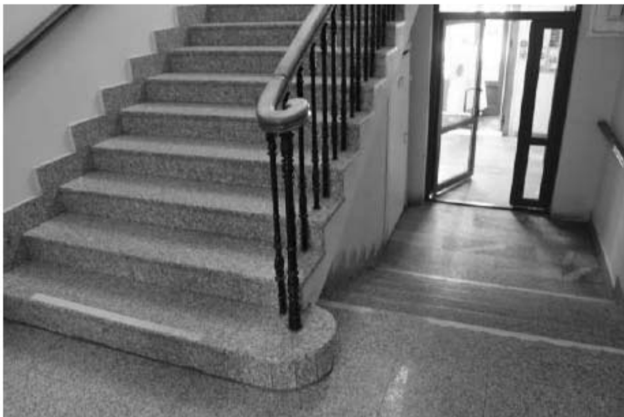
Фото 83. Выявленный объект культурного наследия «Павильон гинекологических и глазных болезней с переходной галереей». 2ЛК. Вид на лестницу в уровне 1-го этажа. Фото 12.05.2023 г.
