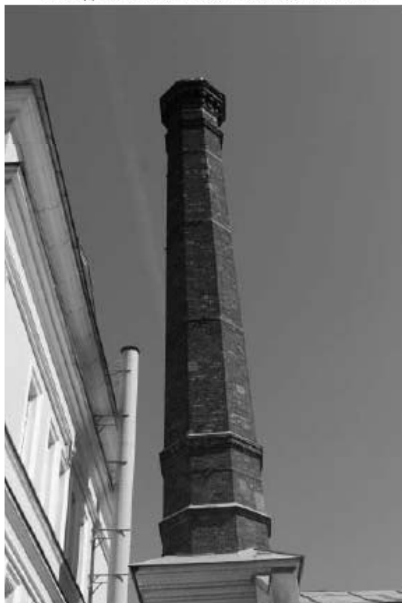
Фото 67. Вид на дымовую трубу выявленного объекта культурного наследия «Котельная» с запада. Фото 12.05.2023 г.
