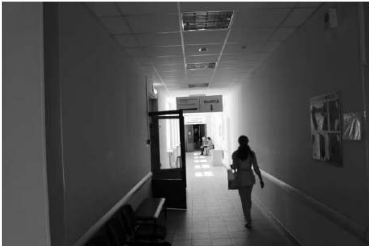
Фото 99. Выявленный объект культурного наследия «Павильон-приют им. Н.И. Жуковской с переходной галереей». Внутренние помещения 1-го этажа. Фото 12.05.2023 г.
