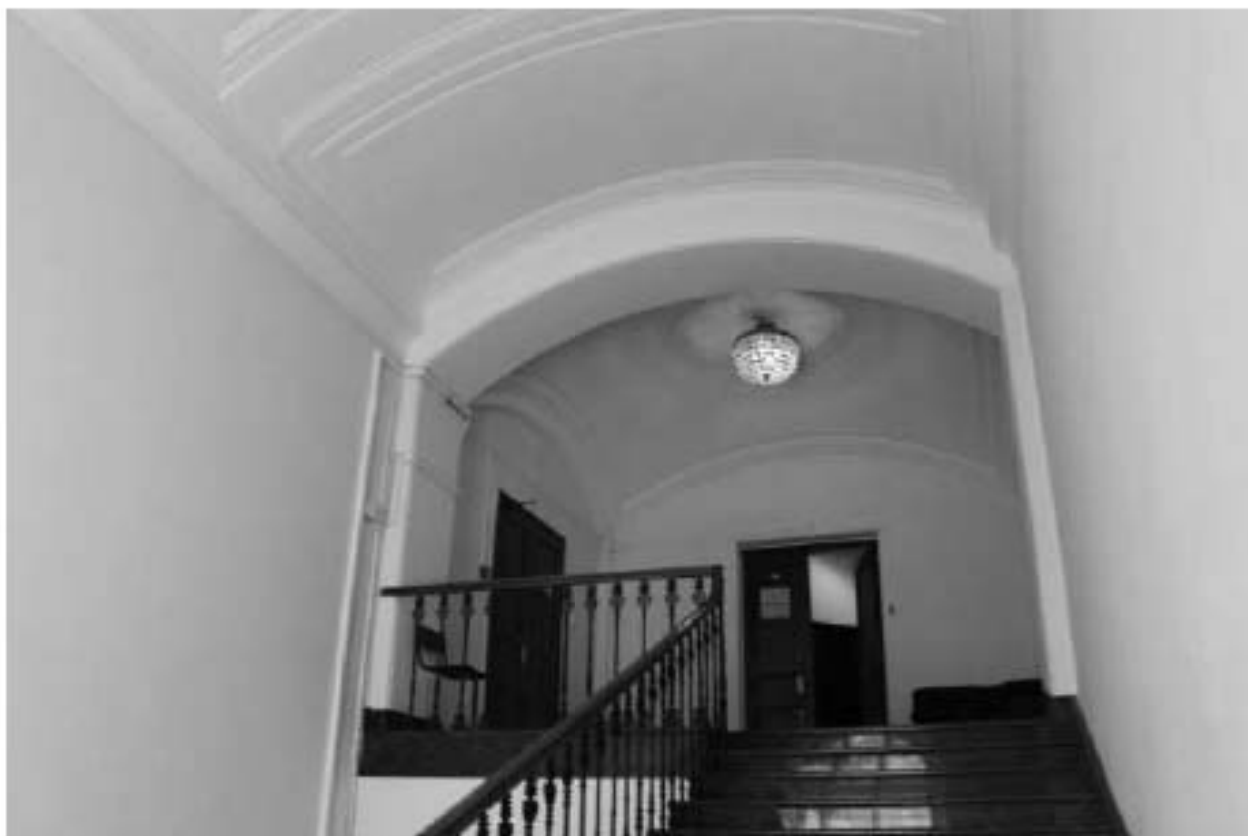
Фото 27. Выявленный объект культурного наследия «Главное здание». 1ЛК. Лестничная площадка в уровне 3-го этажа. Фото 12.05.2023 г.
