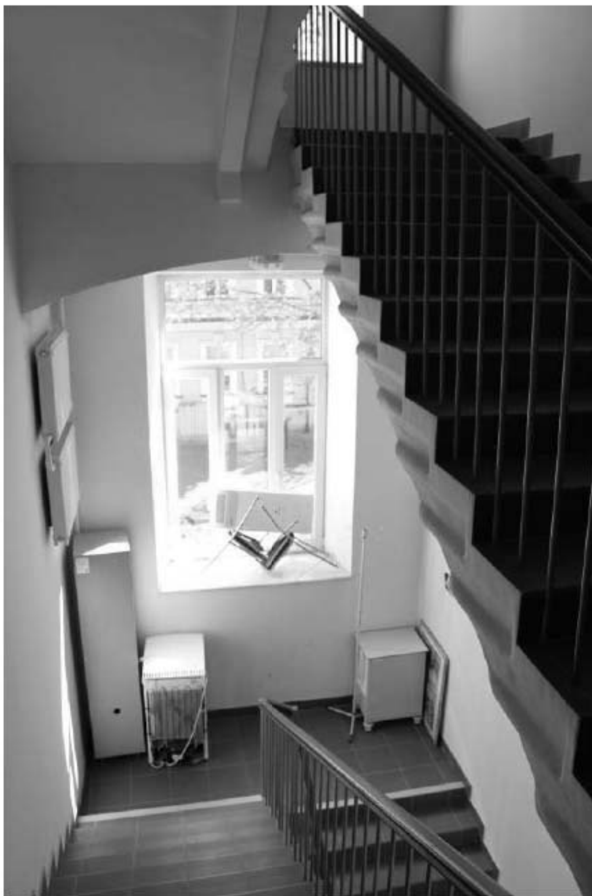
Фото 136. Выявленный объект культурного наследия «Амбулаторный корпус». Л-2. Вид на междуэтажную площадку в уровне 2-го – 3-го этажей. Фото 12.05.2023 г.
