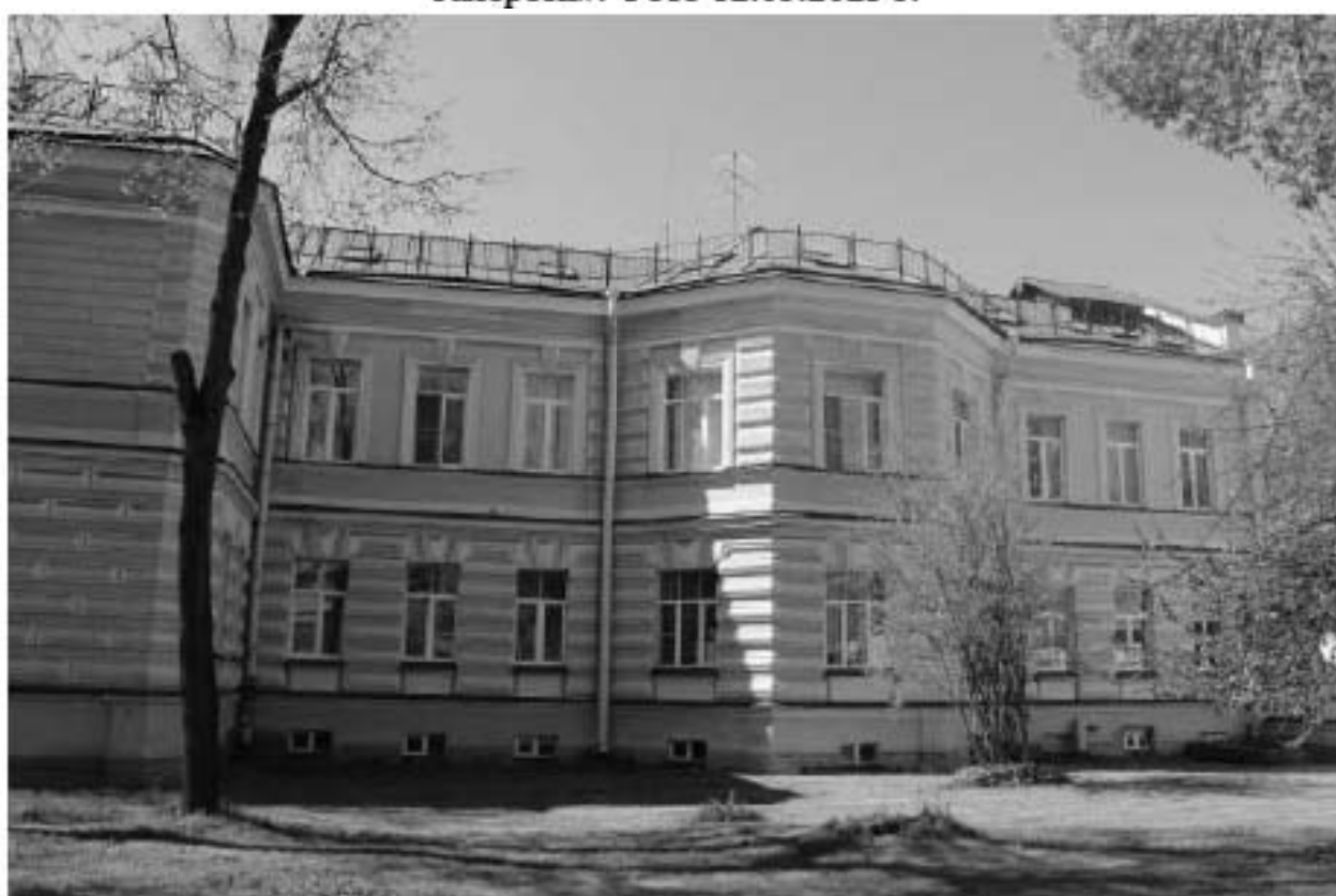
Фото 88. Вид на восточный фасад выявленного объекта культурного наследия «Павильон-приют им. Н.И. Жуковской с переходной галереей». Фото 12.05.2023 г.
