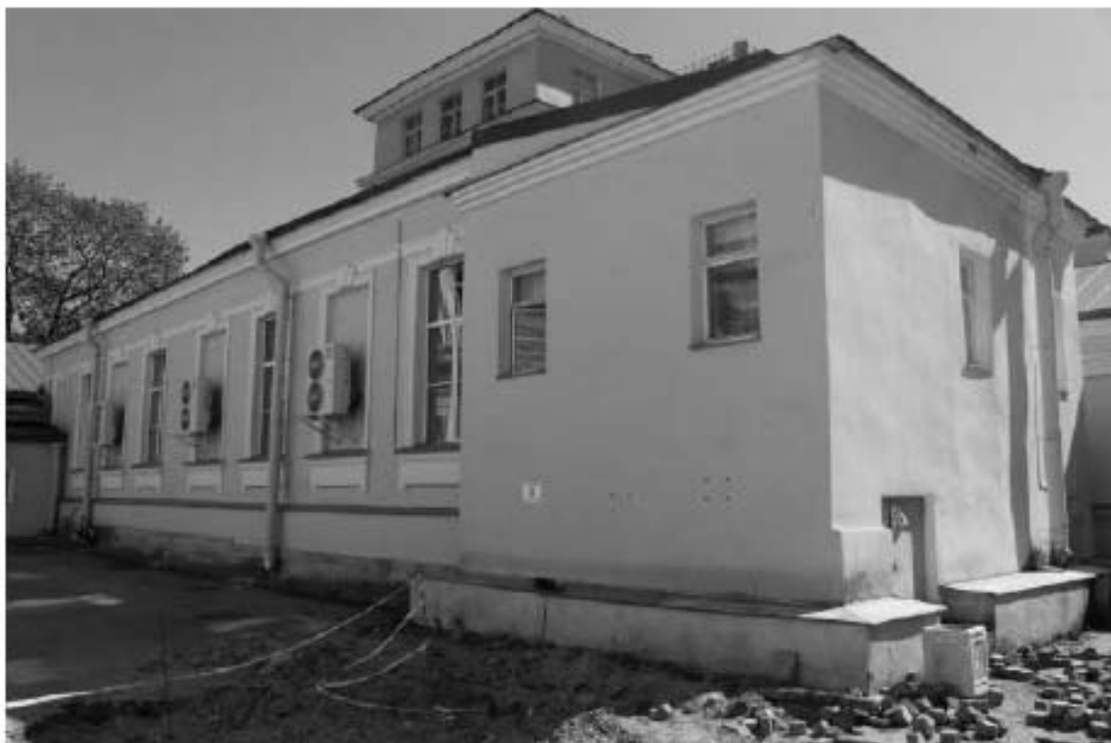
Фото 50. Вид на северный фасад переходной галереи выявленного объекта культурного наследия «Кухонный корпус с переходной галереей». Фото 12.05.2023 г.
