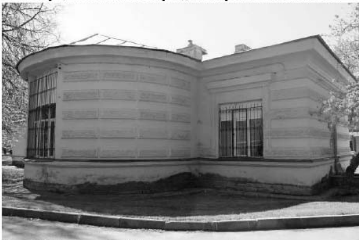
Фото 107. Вид на восточный фасад выявленного объекта культурного наследия «Операционный павильон с переходной галереей». Фото 12.05.2023 г.
