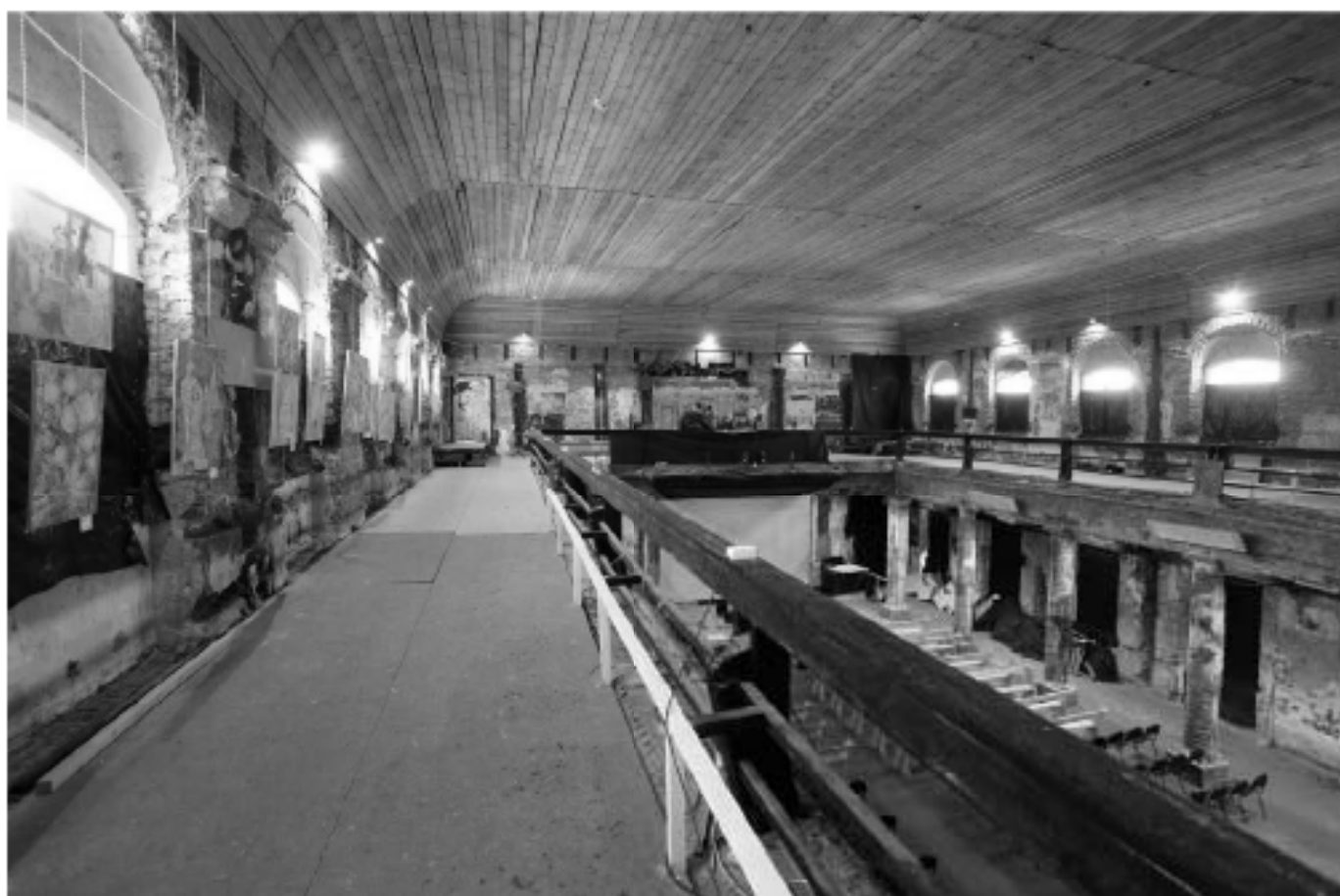
Фото 30. Объект культурного значение федерального значения «Церковь», 1775-1779гг, арх. Фельтон Ю.М., 1939г. арх. Гегелло А.И, арх. Косвен Л.С., по адресу: г. Санкт-Петербург, ул. Кирочная, дом 8, лит. В, входящего в состав объекта культурного наследия федерального значения "Церковь евангелическо-лютеранская Святой Анны" по адресу: г. Санкт-Петербург, Кирочная ул., дом 8, Фурштатская ул., между домами 7 и 9.
