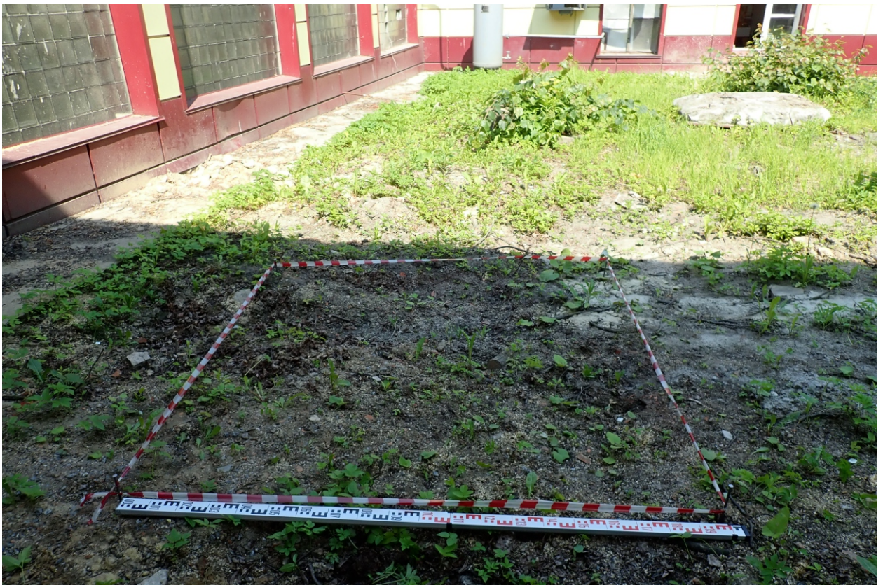
Илл. 15. г. Санкт-Петербург. «Реконструкция производственного здания инв. № 147;136 расположенного на территории АО «НПП «Краснознамёнец» по ул. Челябинской, д.46 АЖ». Шурф. До начала работ. Вид с юга.
