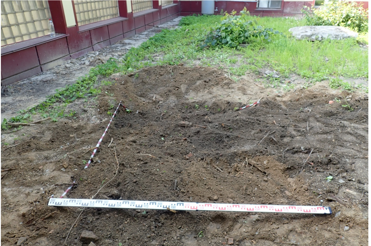
Илл. 20. г. Санкт-Петербург. «Реконструкция производственного здания инв. № 147;136 расположенного на территории АО «НПП «Краснознамёнец» по ул. Челябинской, д.46 АЖ». Шурф. Рекультивация. Вид с юга.
