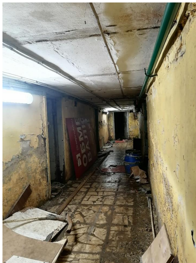
Илл.55. Подвал в жилое здание, примыкающее к зданию Калининского универмага со стороны Кондратьевского проспекта. 05.07.2021г.
