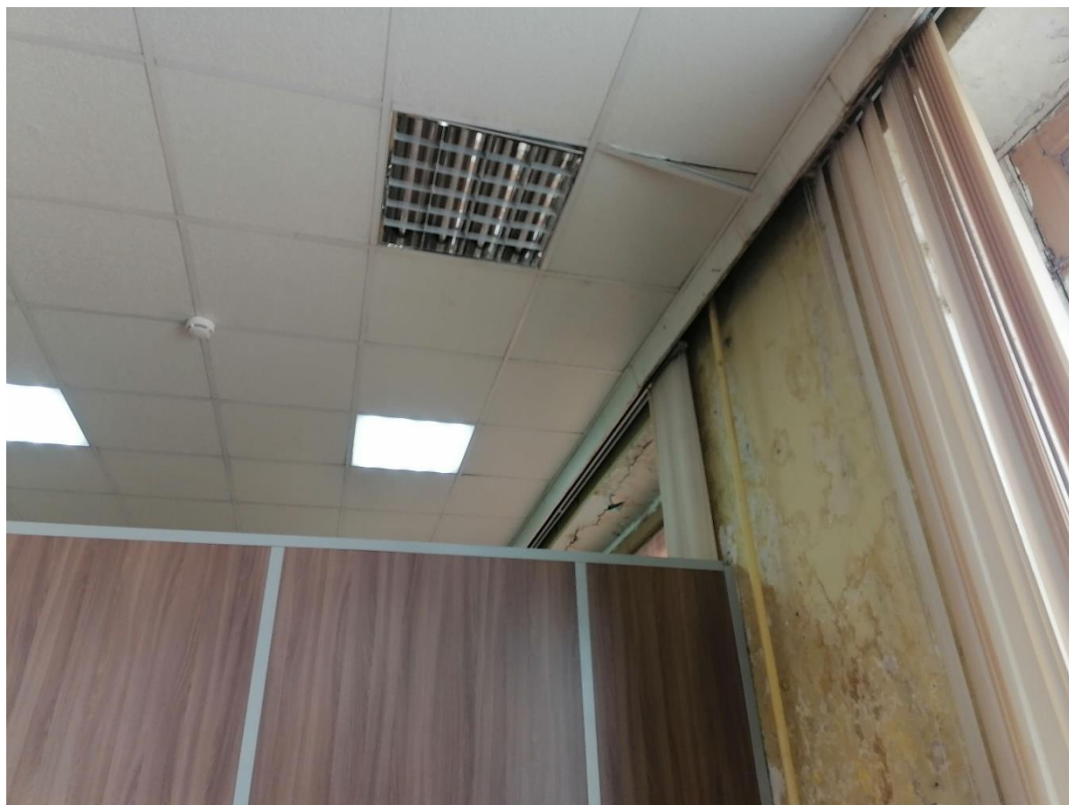
Илл.27. 2-ой этаж (помещение №5 в части здания со стороны Полюстровского проспекта). Фрагмент. 05.07.2021г.
