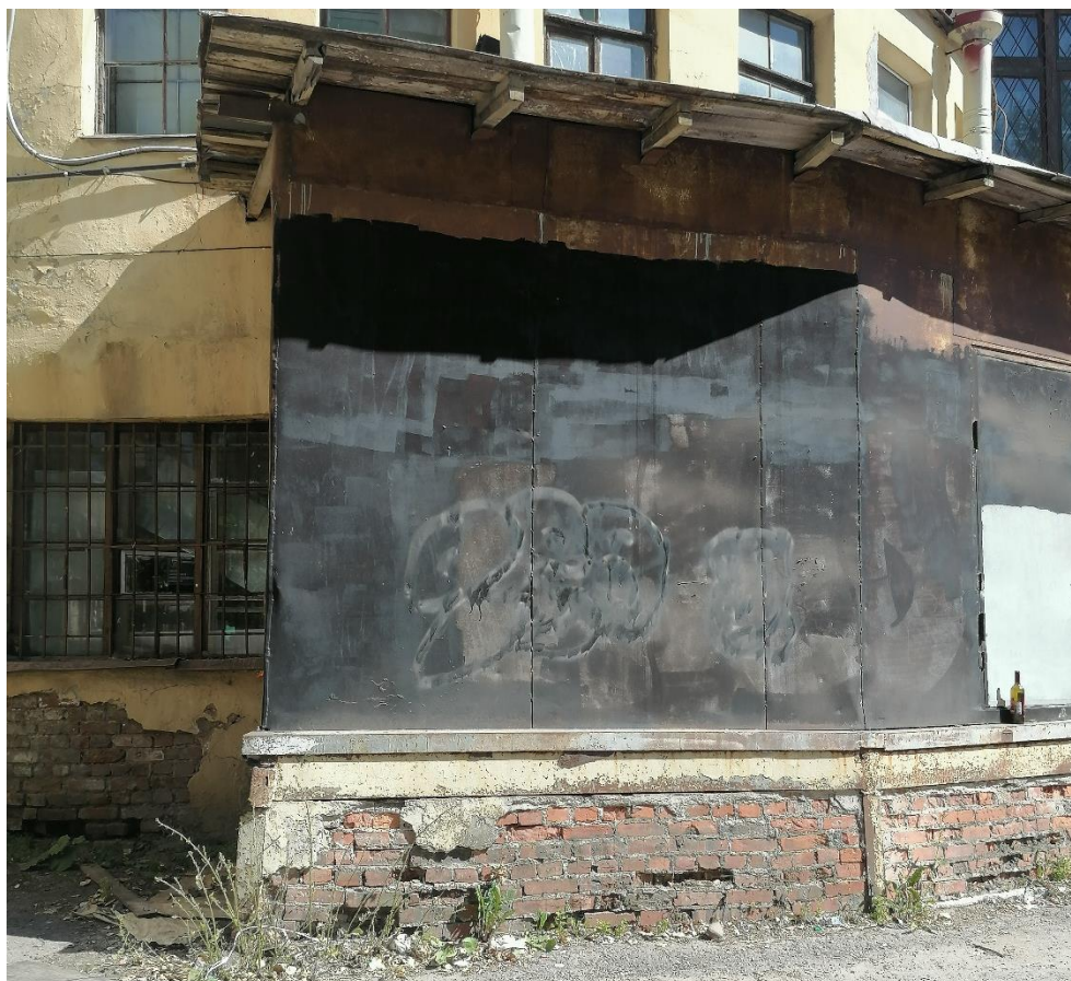
Илл.12. Фрагмент основания центральной полуротонды дворового фасада. 05.07.2021г.
