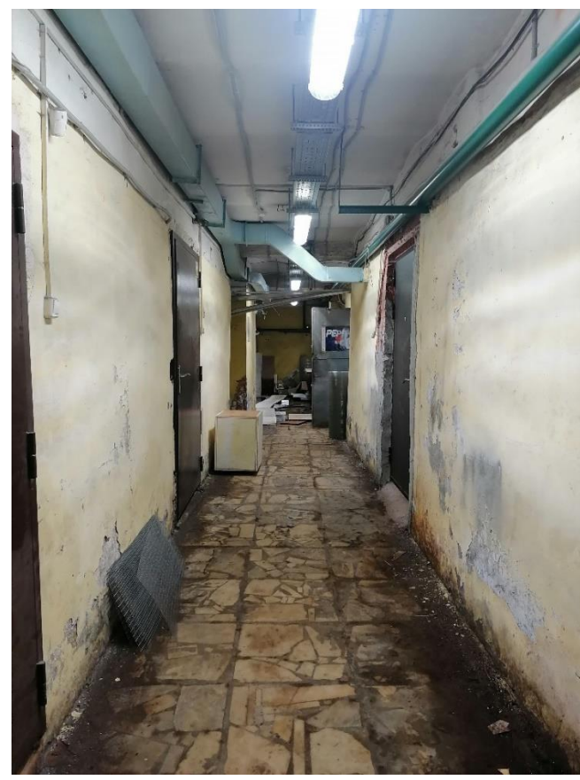
Илл.49. Подвал. Коридор (помещение №14) в части здания со стороны Кондратьевского проспекта. 05.07.2021г.
