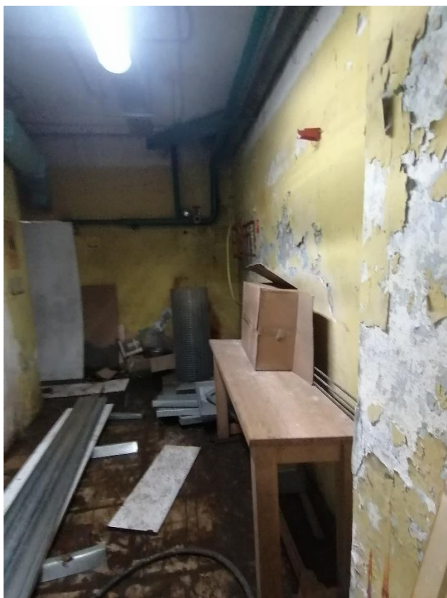
Илл.54.1. Подвал. Коридор (помещение №14) в части здания со стороны Кондратьевского проспекта. 05.07.2021г.
